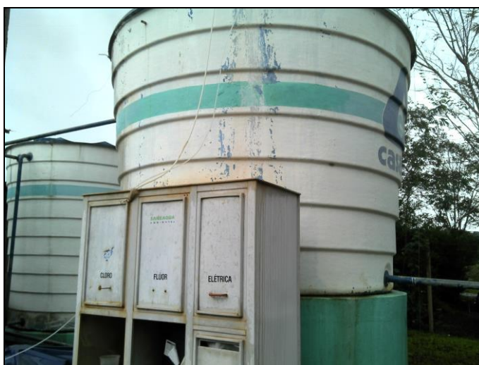
Figura 3: Casa de química sem proteção (GEFIS 043/2015)
