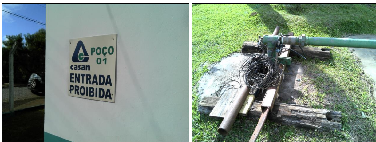
Figura 7: Poço 1 junto à ETA e Escritório
