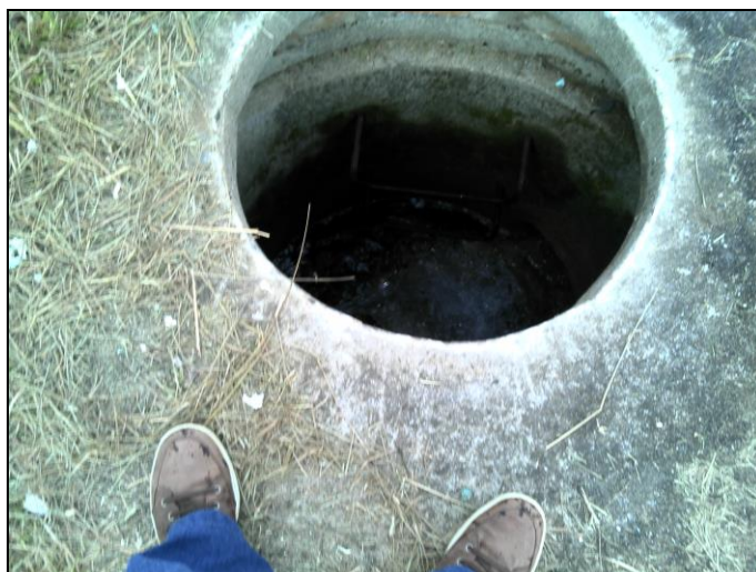
Figura 18: Extravasamento de água tratada do reservatório
