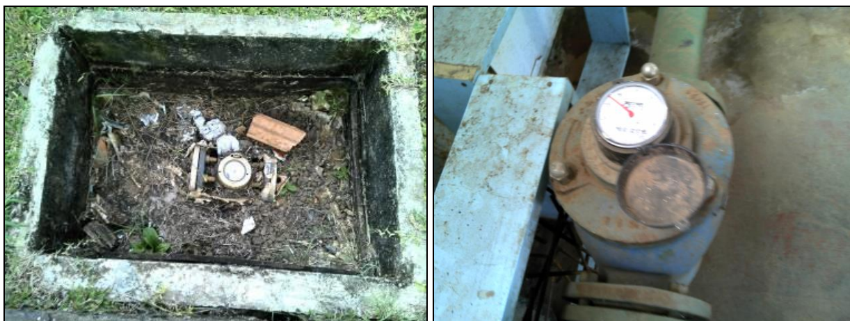
Figura 12: Macro medidor de água bruta do Poço 1 e Poço 2
