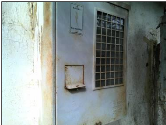
Figura 23: Quadro de energia
