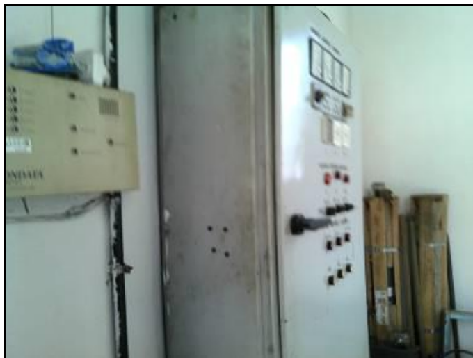
Figura 21: Quadro de comando da ERAT
