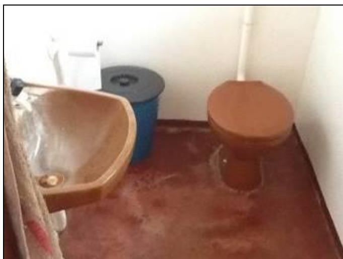
Figura 3: Sanitário de uso coletivo
