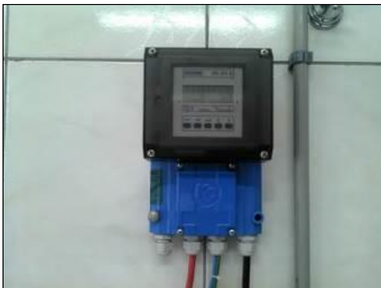
Figura 43: Medidor de vazão
