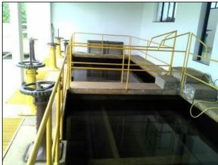
Figura 19: Filtros da ETA
