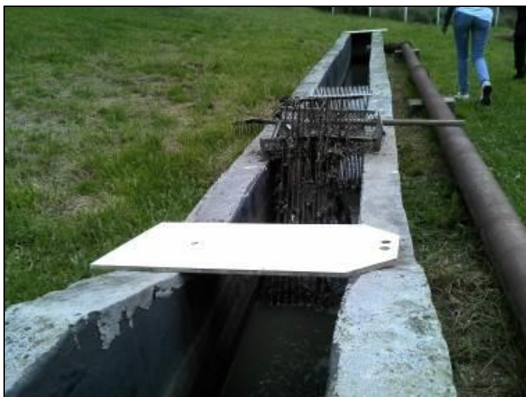
Figura 42: Chegada do efluente bruto
