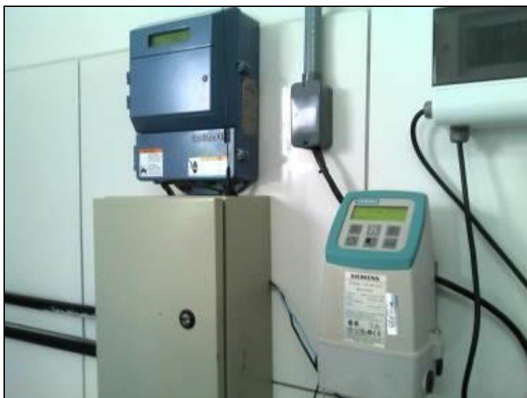
Figura 14: Macromedidor entrada e saída
