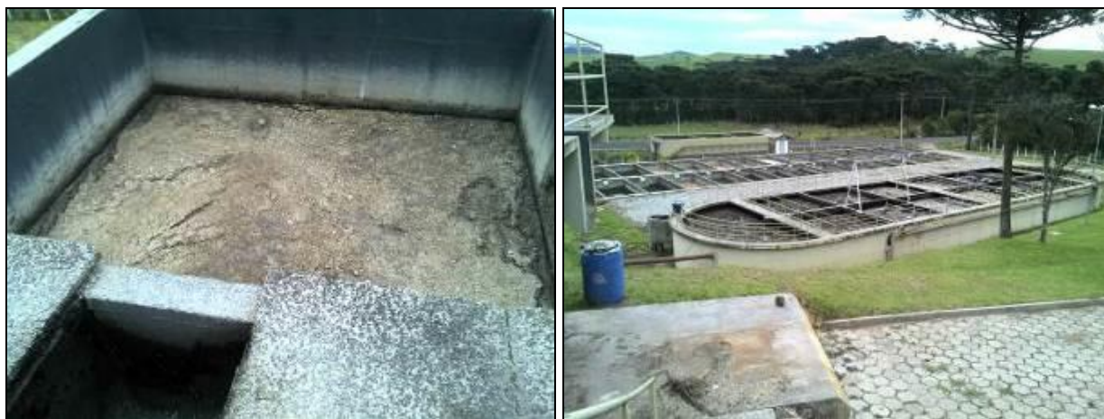
Figura 44: Unidades de tratamento
