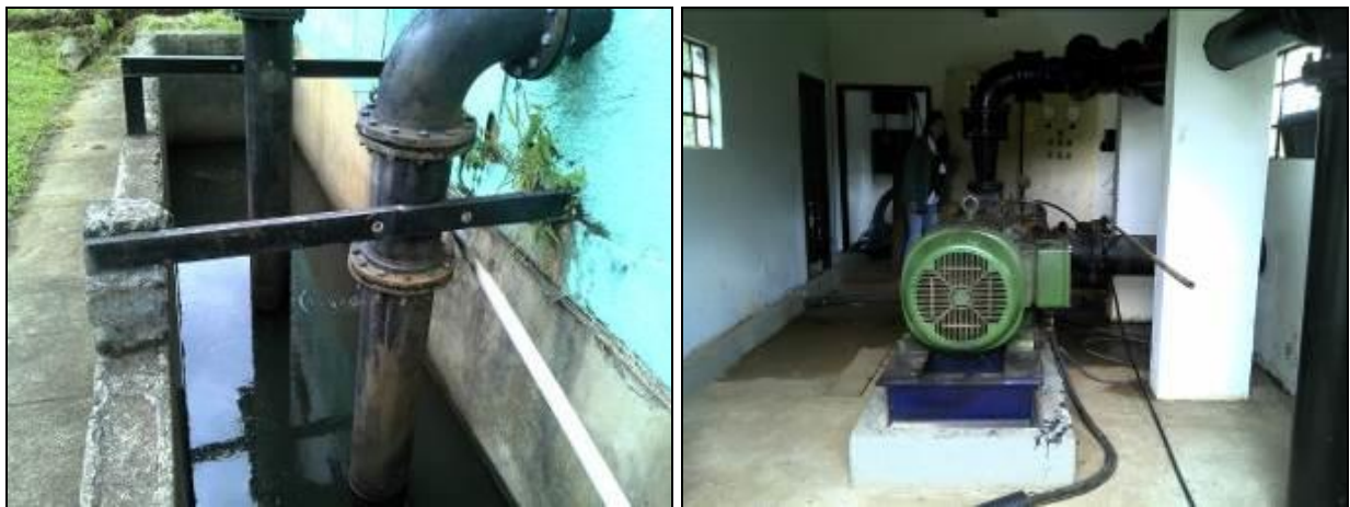
Figura 9: Bombas de captação
