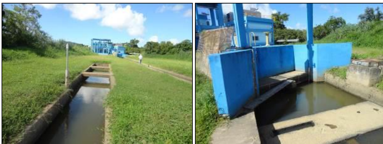
Figura 1: Canal artificial do Rio Camboriú para a captação de água (à esquerda) e barragem de captação (à direita) (28/03/2014)
