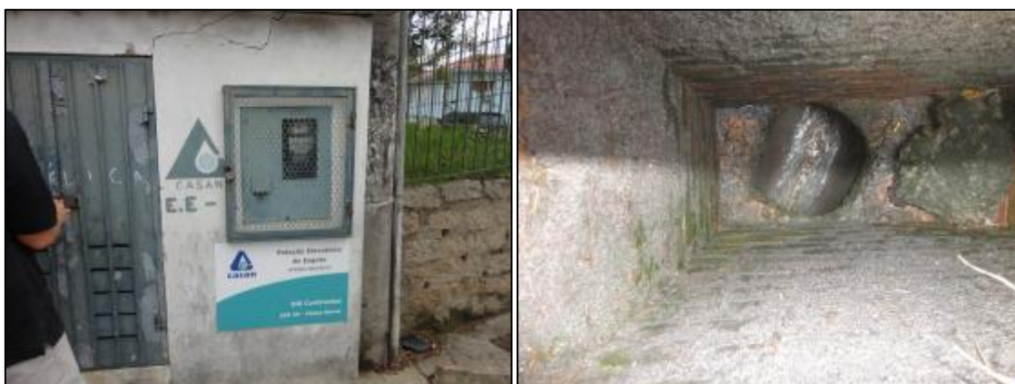
Figura 1: EEE Felipe Neves lançando o efluente bruto na rede pluvial (17/02/2014)
