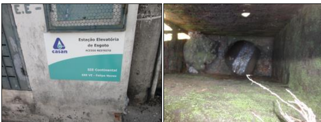
Figura 2: EEE Felipe Neves lançando efluente bruto na rede pluvial (06/03/2014)
