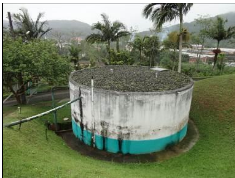
Figura 24: Área de cobertura do reservatório
