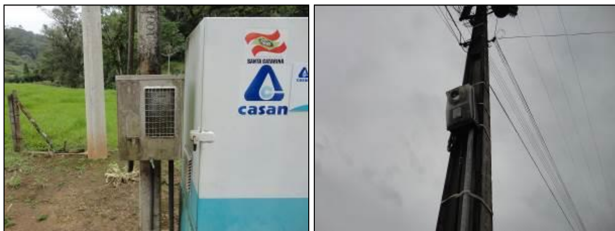
Figura 29: Quadro de energia dos Booster
