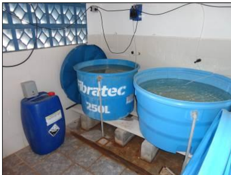
Figura 9: Tratamento e armazenamento produtos químicos
