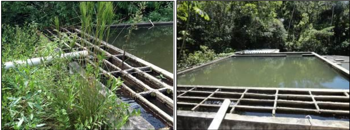
Figura 15: Estrutura de tratamento físico (inicial e acompanhamento)
