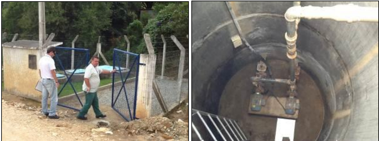
Figura 51: Estação Elevatória EE-01 – Principal (Inicial)
