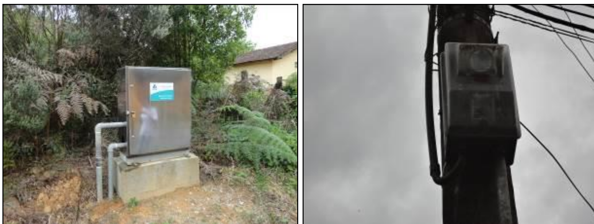
Figura 36: Booster Morro Chato I (Acompanhamento)
