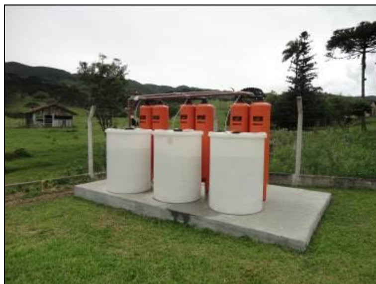
Figura 26: Tanques Desfluoretadores – Casa de química Taquaras(Acompanhamento)
