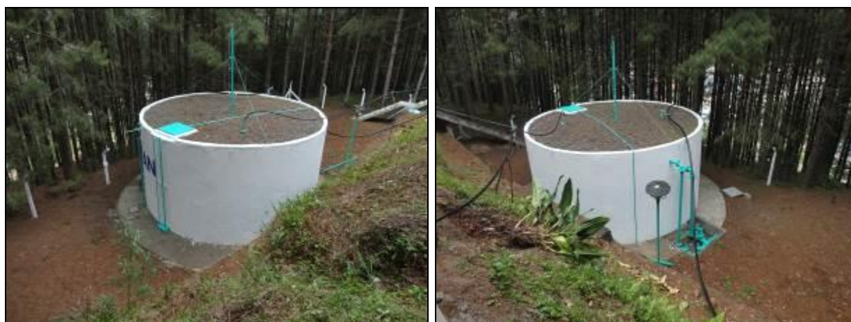
Figura 30: Reservatório R-01 Sede (Acompanhamento)
