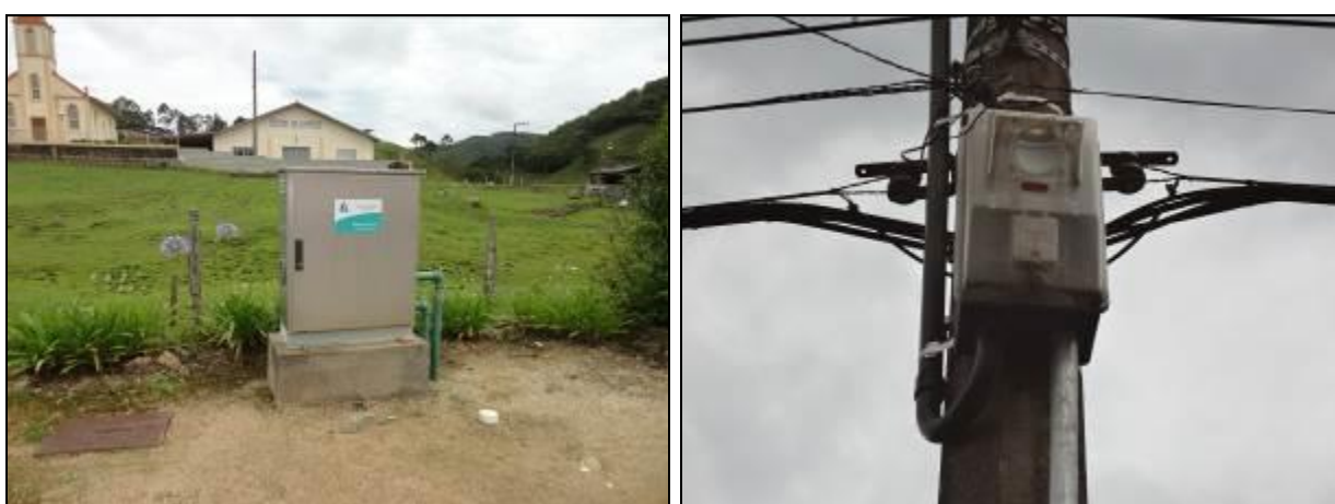
Figura 38: Booster Morro Chato II (Acompanhamento)
