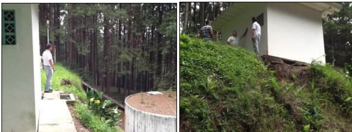
Figura 27: Estrutura da ETA Sede sob risco (Inicial)
