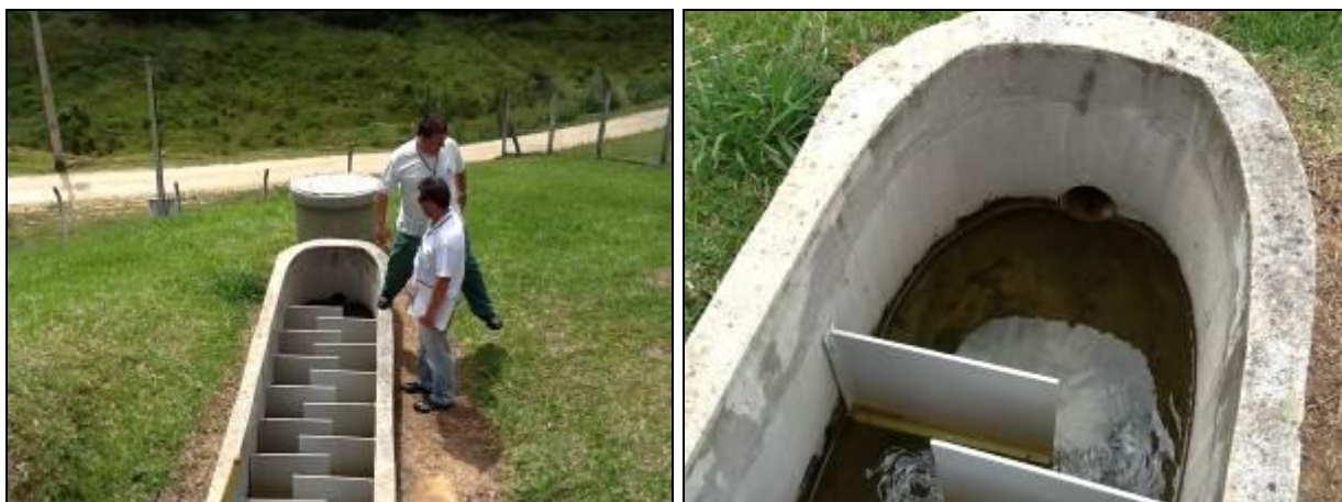
Figura 46: Estruturas e tratamento físico (Inicial)
