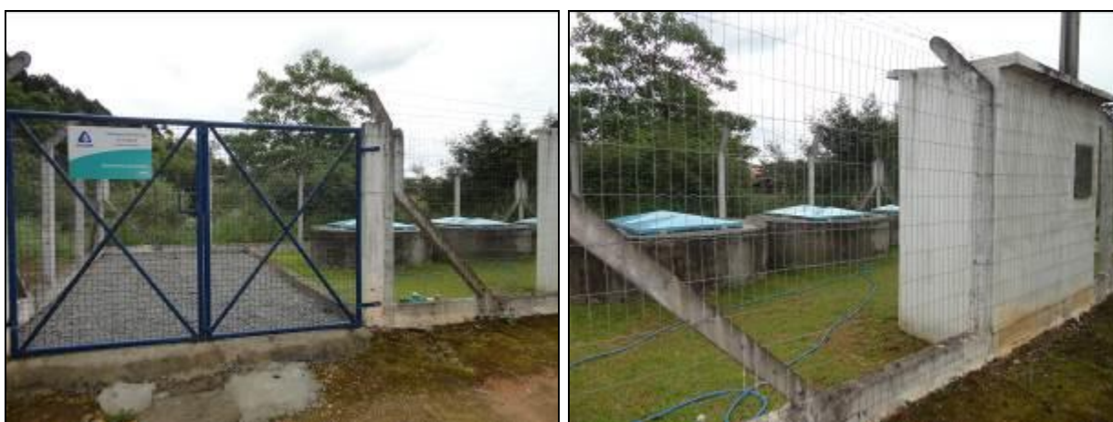
Figura 55: Estação Elevatória EE-03 (Acompanhamento)
