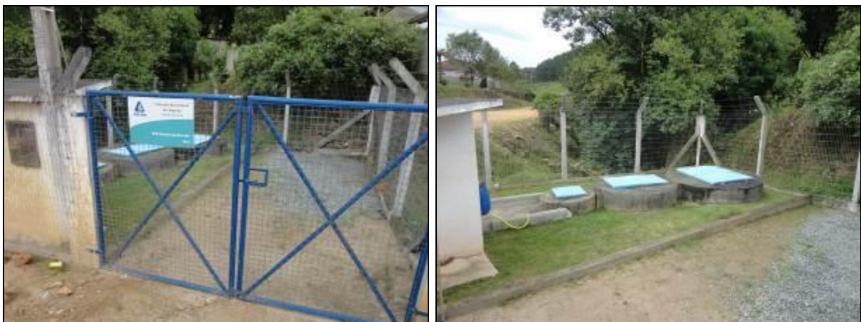
Figura 52: Estação Elevatória EE-01 – Principal (Acompanhamento)
