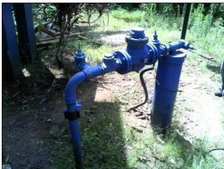
Figura 7: Poço 1- Vai para a ETA para tratamento (acompanhamento)
