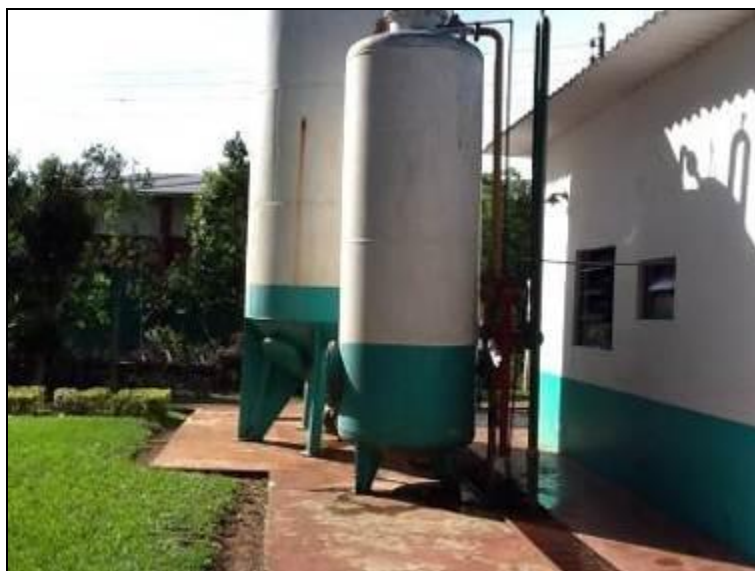
As áreas de tratamento físico: ETA Compacta.
