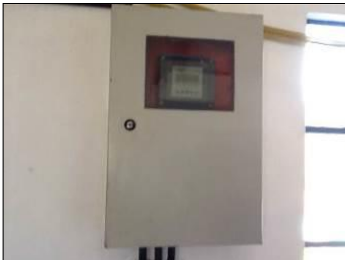
Figura 12: Macromedidor de saída ETA
