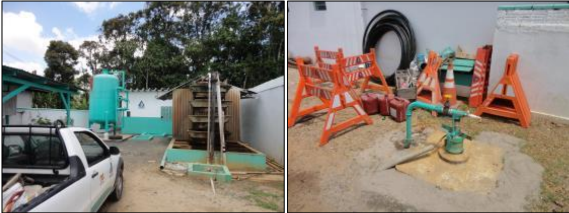
Figura 5: ETA Central e poço artesiano
