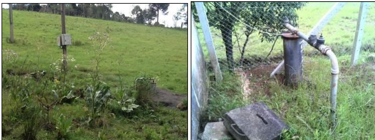
Figura 3: Poço 1 - Sede (Inicial e acompanhamento)
