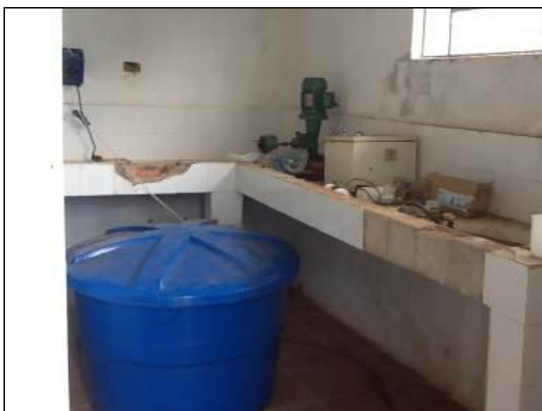
Figura 6: Laboratório em estado abandonado
