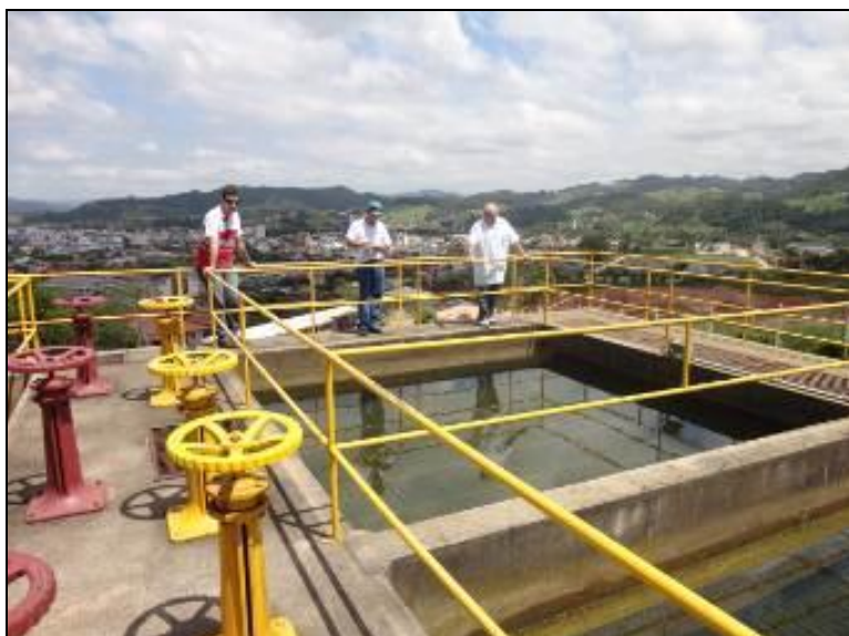
Figura 19: Filtros da ETA
