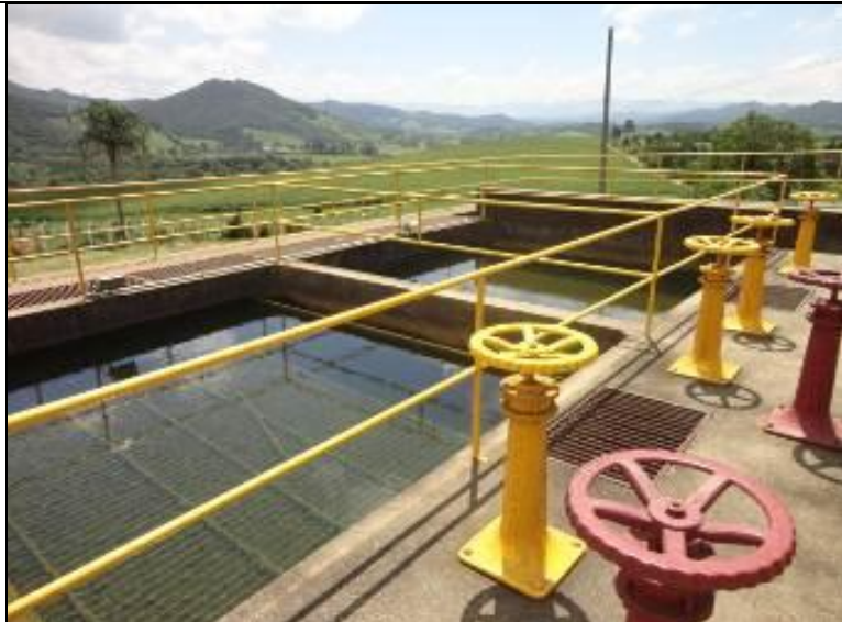
Figura 18: Decantadores da ETA
