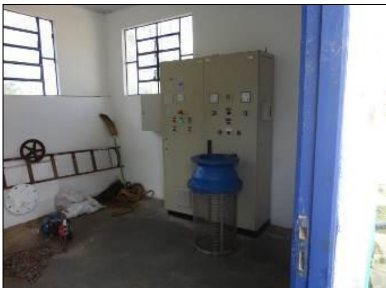
Figura 26: Quadro de Energia e Disjuntor
