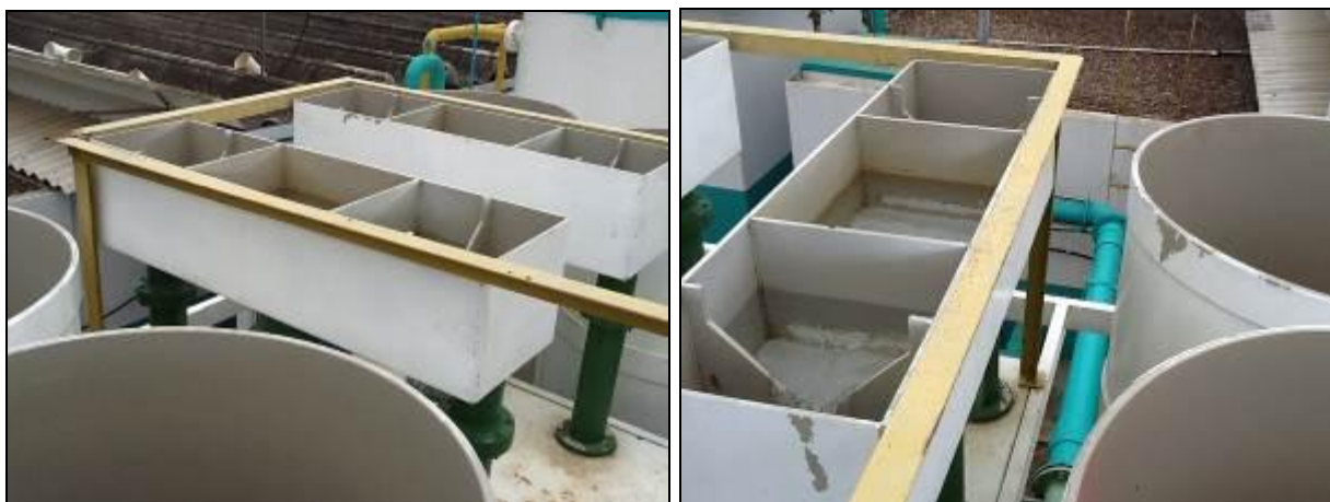
Figura 13: Filtros da ETA
