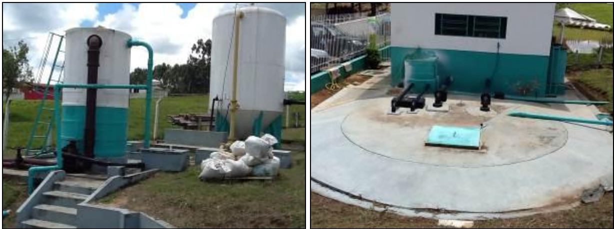
Figura 7: Estação de Tratamento de Água.
