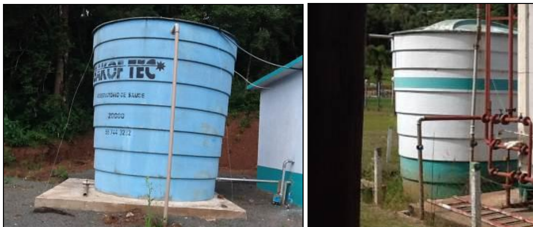
Figura 56: Reservatórios de contato junto aos Poços.
