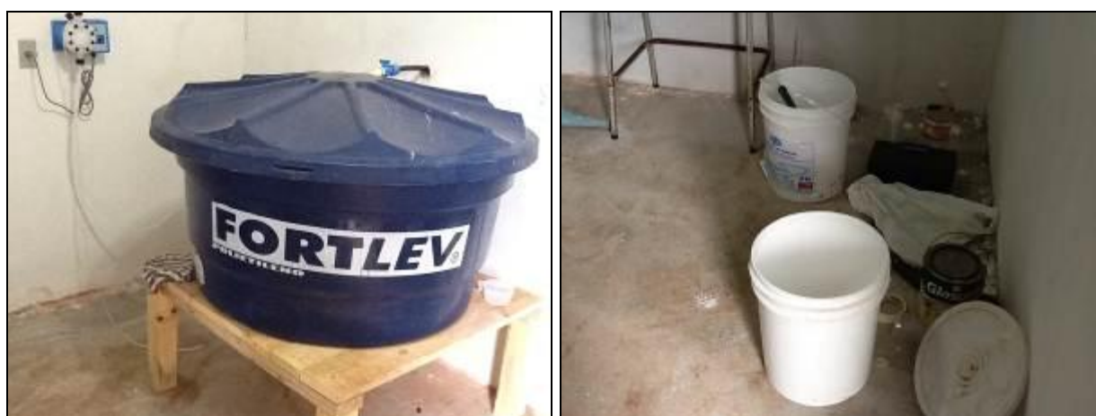
Figura 143: Casa de química do Poço 2.
