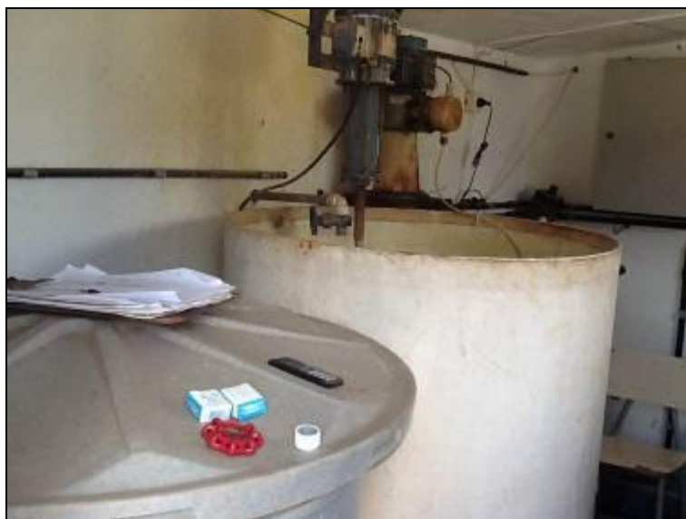
Figura 13: Casa de Química do Poço 1
