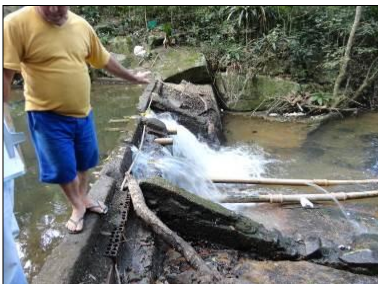
Figura 4 – Tipo e condições operacionais de captação
