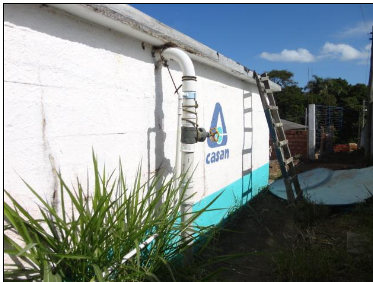
Figura 13 Escada de madeira em precárias condições
