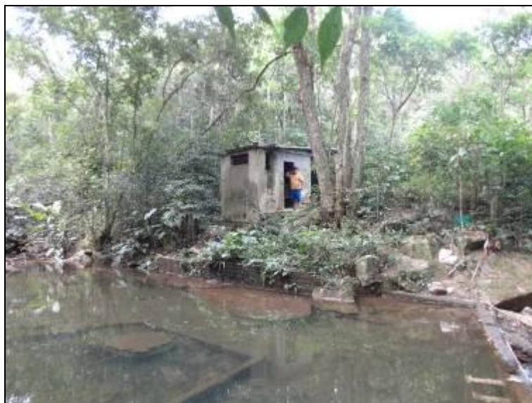
Figura 7: Casa de Química sem condições de acesso
