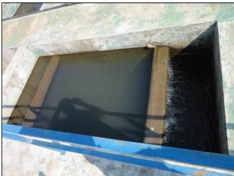
Decantadores da ETA Campo Erê.
