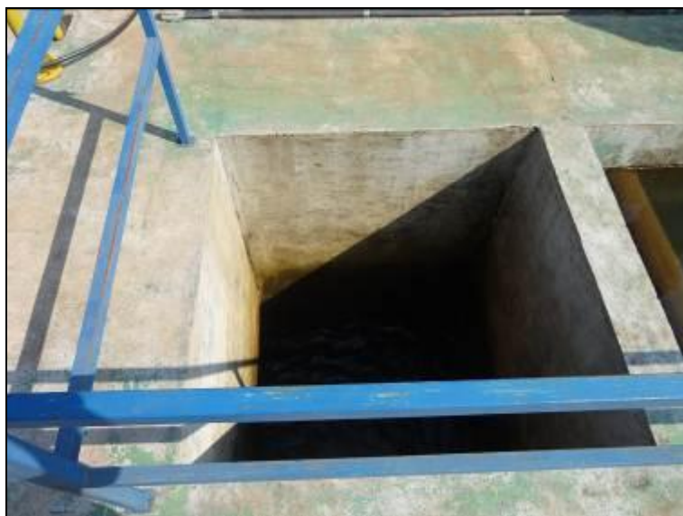
Filtros da ETA Campo Erê.
