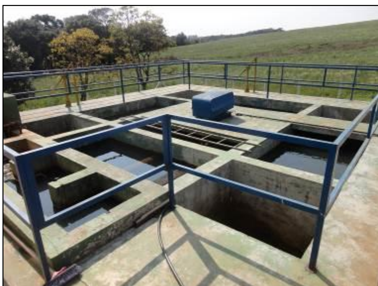
As áreas de tratamento da água físico.
