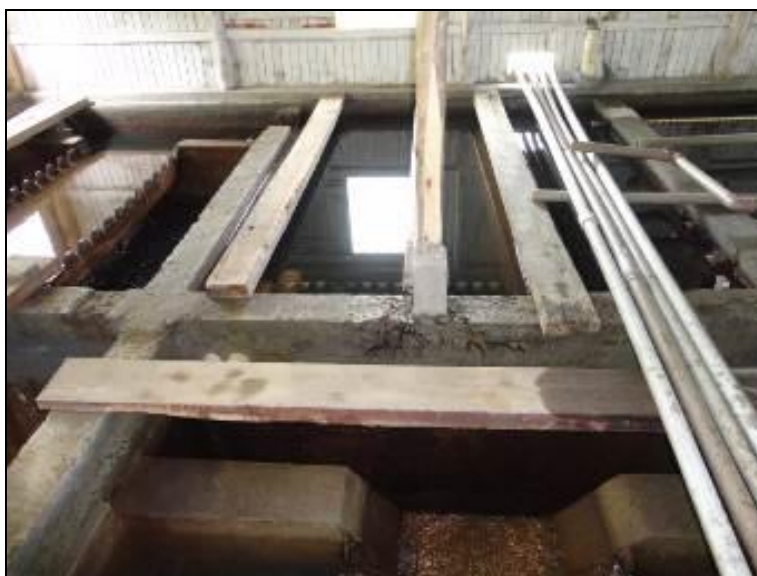
Figura 16: Áreas de vistoria/manutenção não dispõem de guarda-corpo
