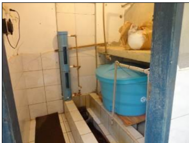
Figura 19: Espaço do tratamento químico.
