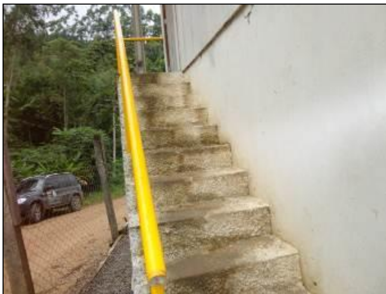
Figura 15: Cercas de proteção.
