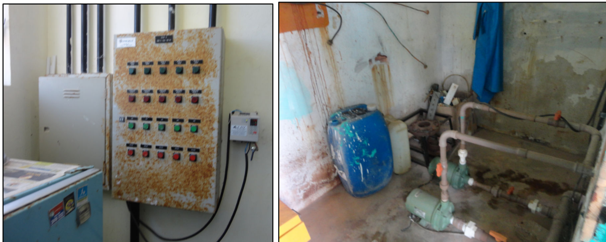
Figura 12 – Na nova visita foi verificada áreas internas da ETA em estado de má conservação.
