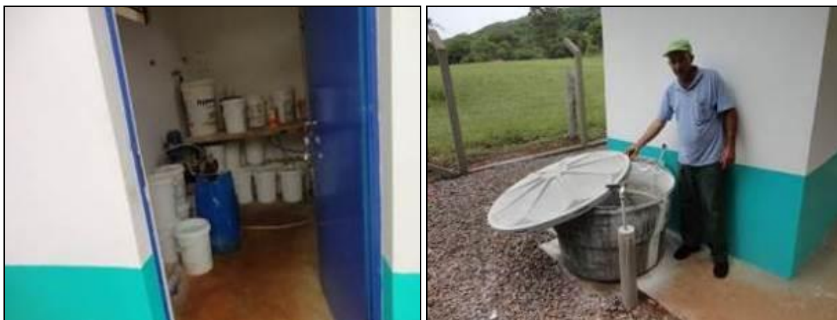
Figura 14: O tratamento é realizado junto ao poço de captação (inicial)
