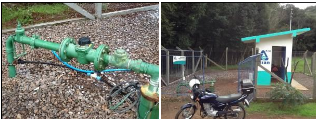
Figura 12: Vistas gerais dos dois poços de captação do SAA de Erval Velho. (acompanhamento)
