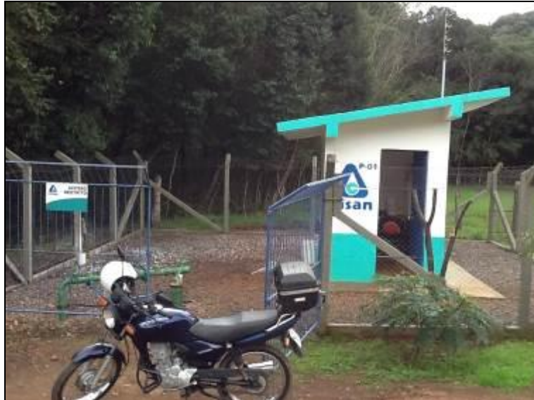
Figura 19: ETA junto ao Poço 1 com cercas de proteção
