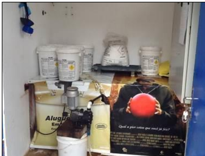
Figura 20: Almoxarifado e acondicionamento dos produtos químicos(acompanhamento)
