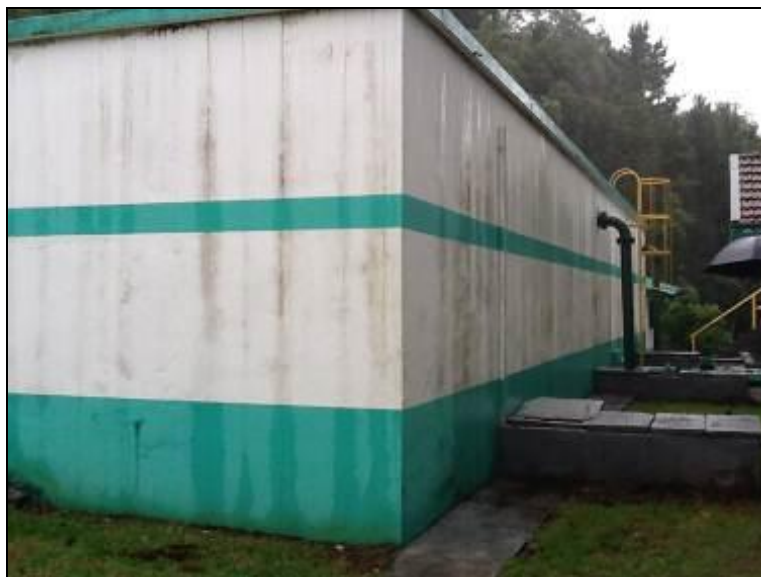
Vista parcial da ETA.
