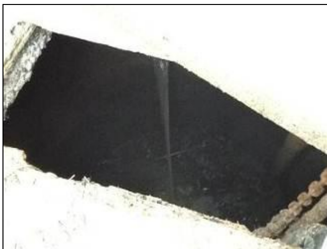
Saída do efluente e condição da água de saída.
