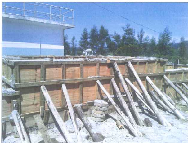
Figura 10: Novo local de armazenamento de produto químico
