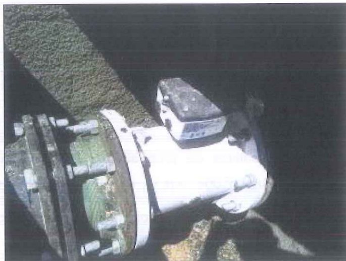
Figura 7: Macromedidor de vazão instalado porém inoperante
