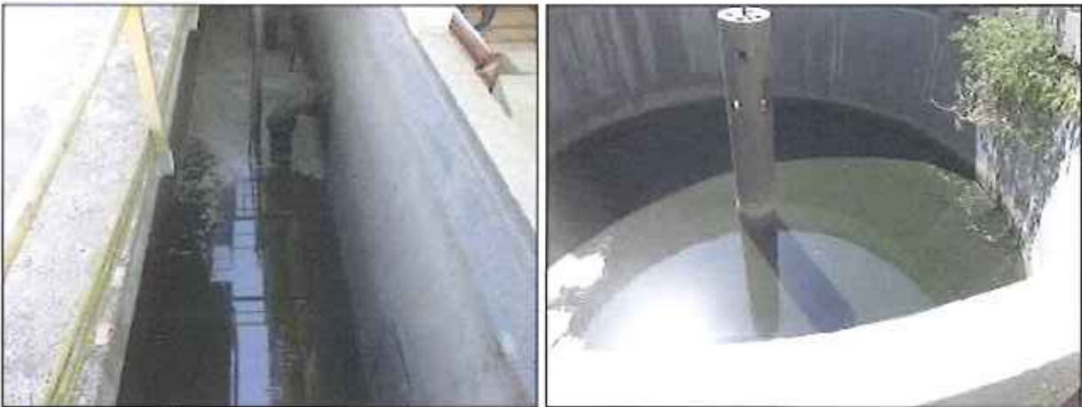
Figura 3: Poço de sucção e aerador desativado da EEE ETE Ingleses
