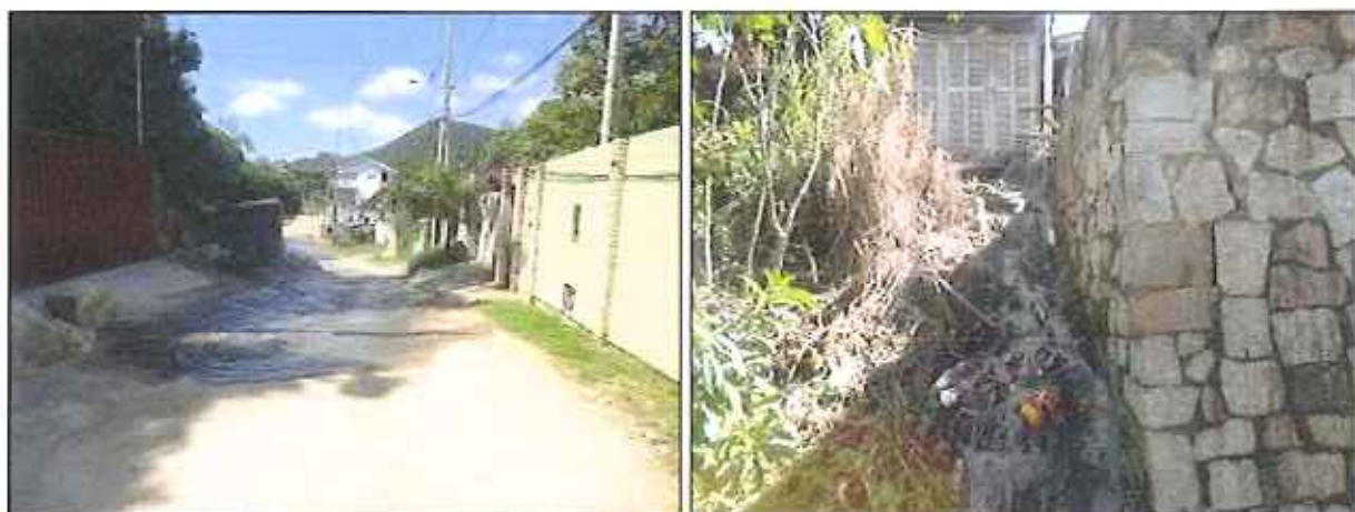
Figura 6: Caixa de passagem com vazamento e esgoto bruto escorrendo em terrenos particulares da Servidão Ferreira
