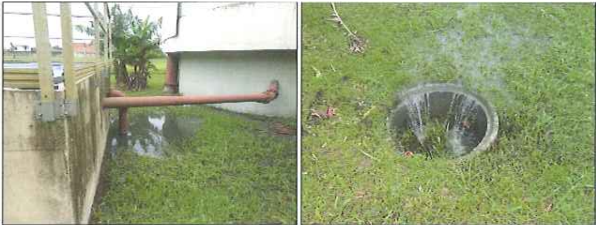
Figura 2: Vazamento EEE ETE Ingleses
