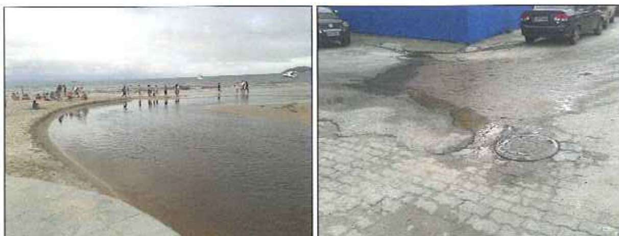
Figura 2: Rio do Braz desaguando na praia de Canasvieiras (à esquerda) e PV da Rua Antenor Borges com vazamento (à direita)
