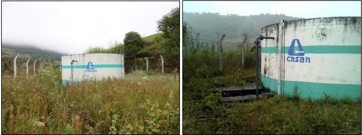
Figura 7: Reservatório com medição de nível (GEFIS 091/2013 à esquerda e maio de 2015 à direita)
