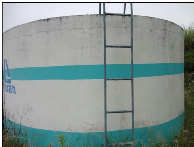
Figura 5: Reservatório sem guarda-corpo na escada (GEFIS 091/2013)
