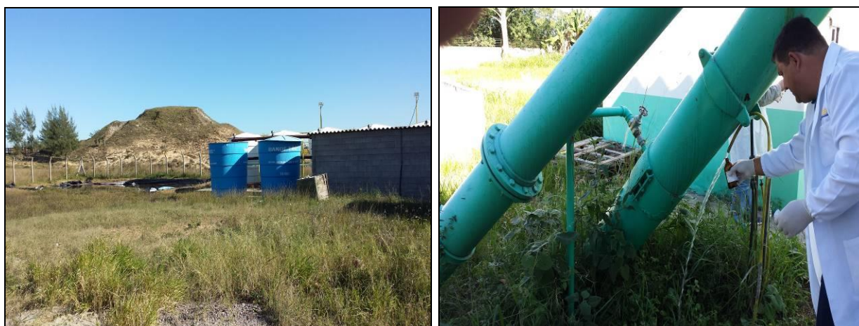
Figura 1: Coleta de água na ETA do Gi (16/06/2015)
