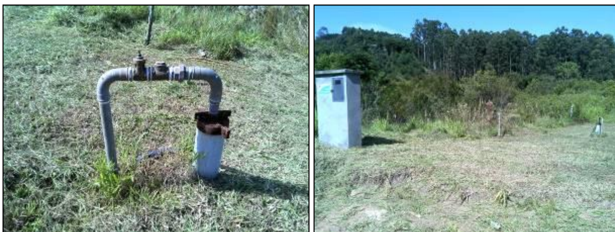
Figura 1: Área do poço sem isolamento (Acompanhamento n. 021/2015)
