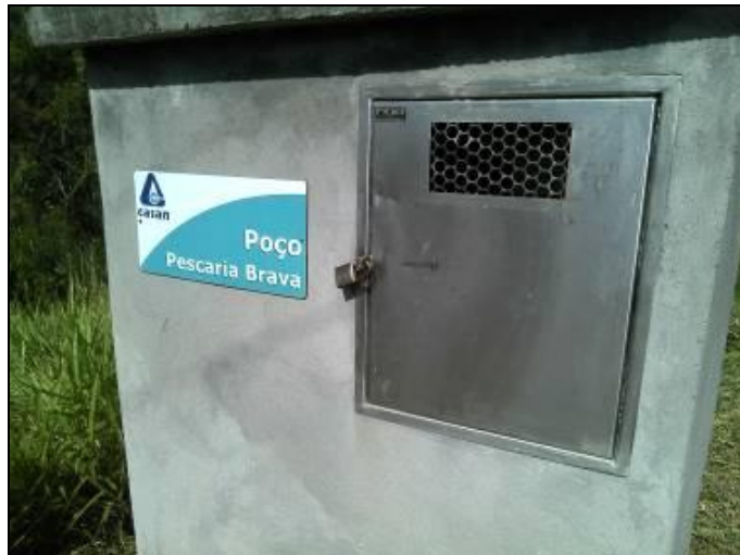
Figura 2: placa de identificação (Acompanhamento n.021/2015)
