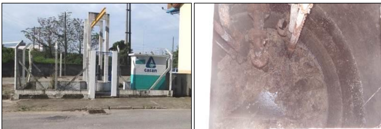
Figura 158: Vista geral da ETE e interna do poço úmido
