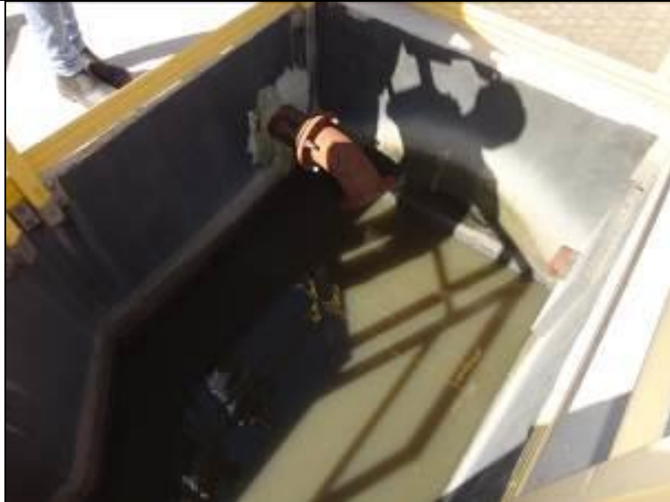
Figura 76: Chegada do efluente bruto
