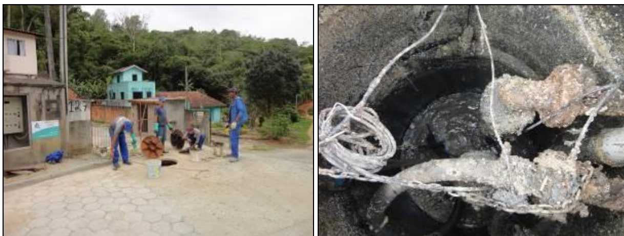
Figura 212: Vista externa e interna do poço úmido
