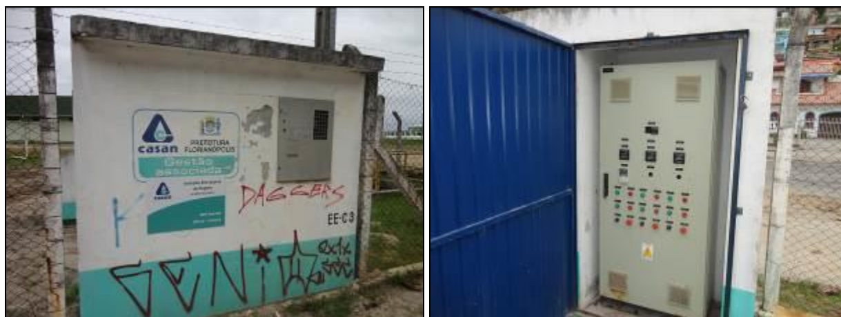
Figura 202: Vista externa e interna do quadro de comando
