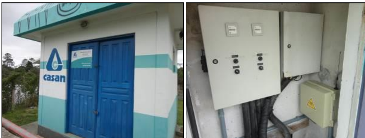
Figura 117: Vista externa e interna do quadro de comando
