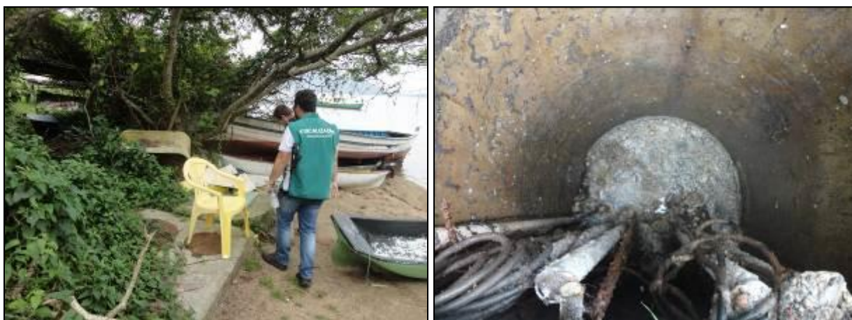
Figura 114: Vista externa e interna do poço úmido
