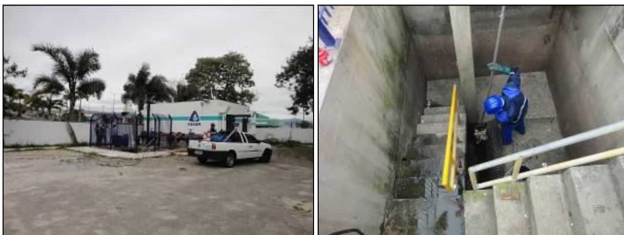
Figura 173: Vista da área interna da EEE e Funcionário executando Limpeza do gradeamento
