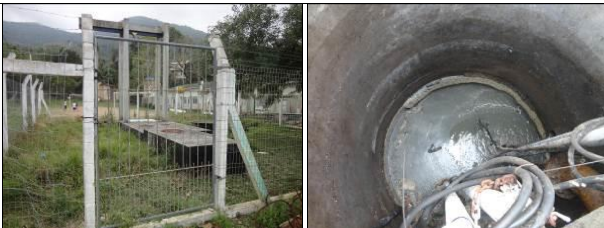
Figura 116: Vista externa e interna do poço úmido
