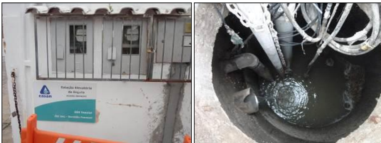
Figura 183: Vista do Quadro de comando e interna do poço úmido
