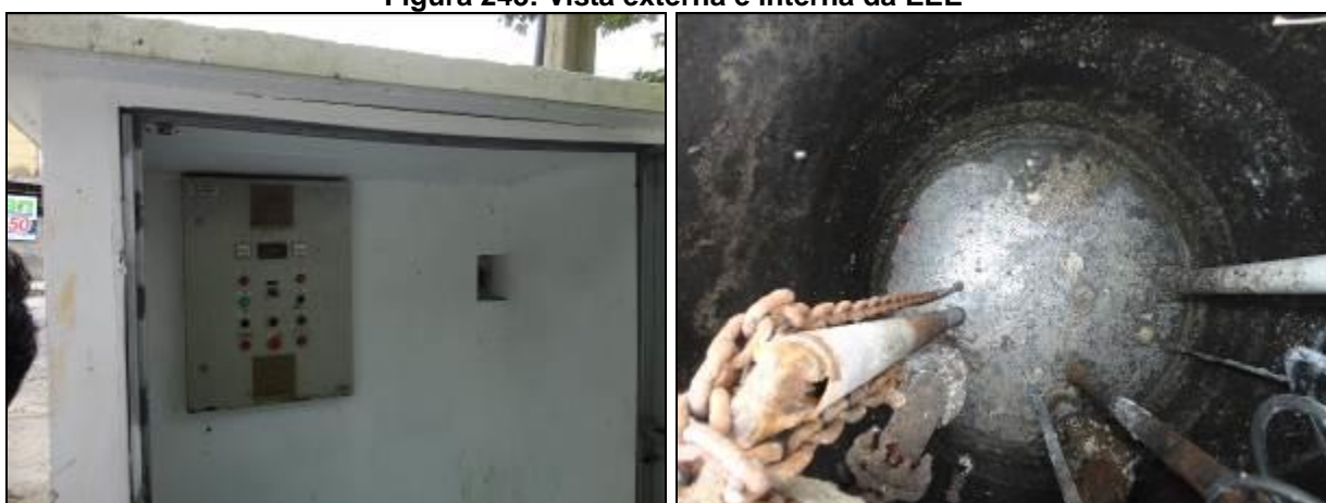
Figura 244 Vista interna da casa de comando e do poço úmido
