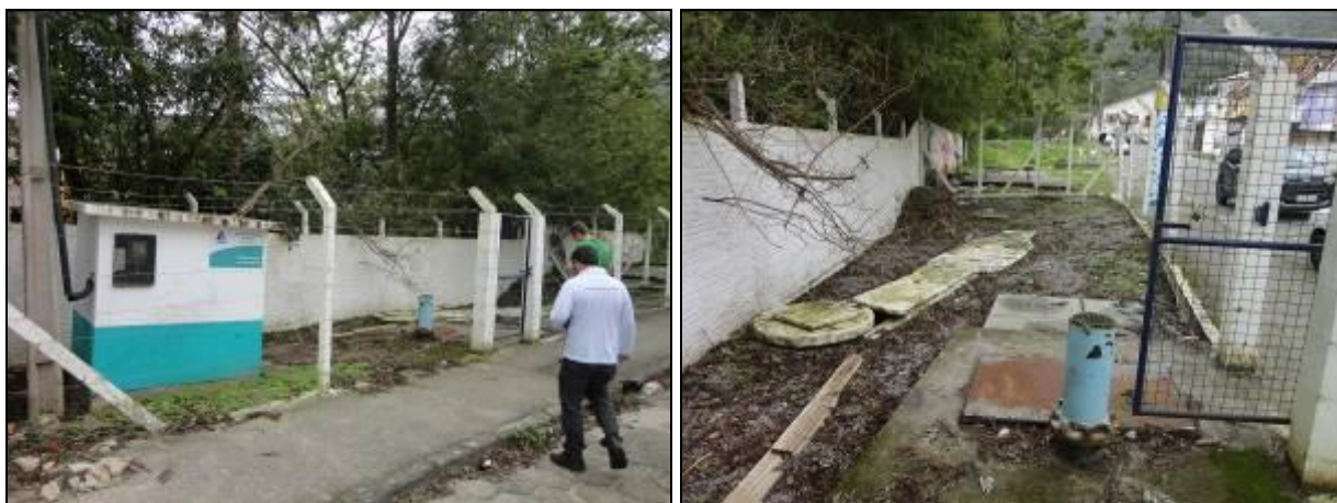
Figura 243: Vista externa e interna da EEE
