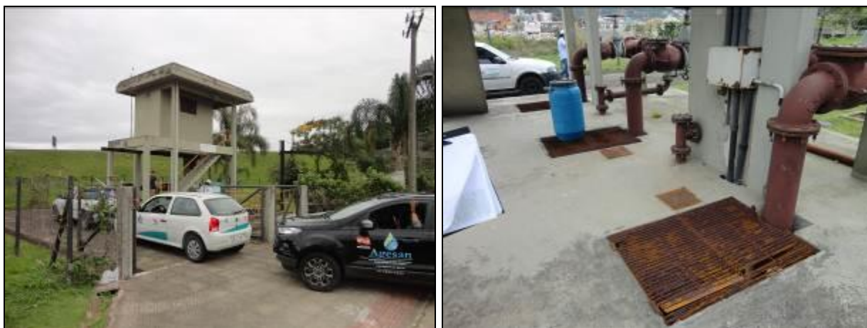
Figura 195: Vista externa e interna da EEE
