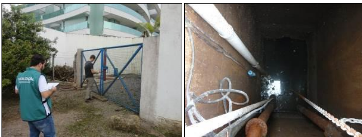
Figura 121: Vista externa da EEE e interna do poço úmido
