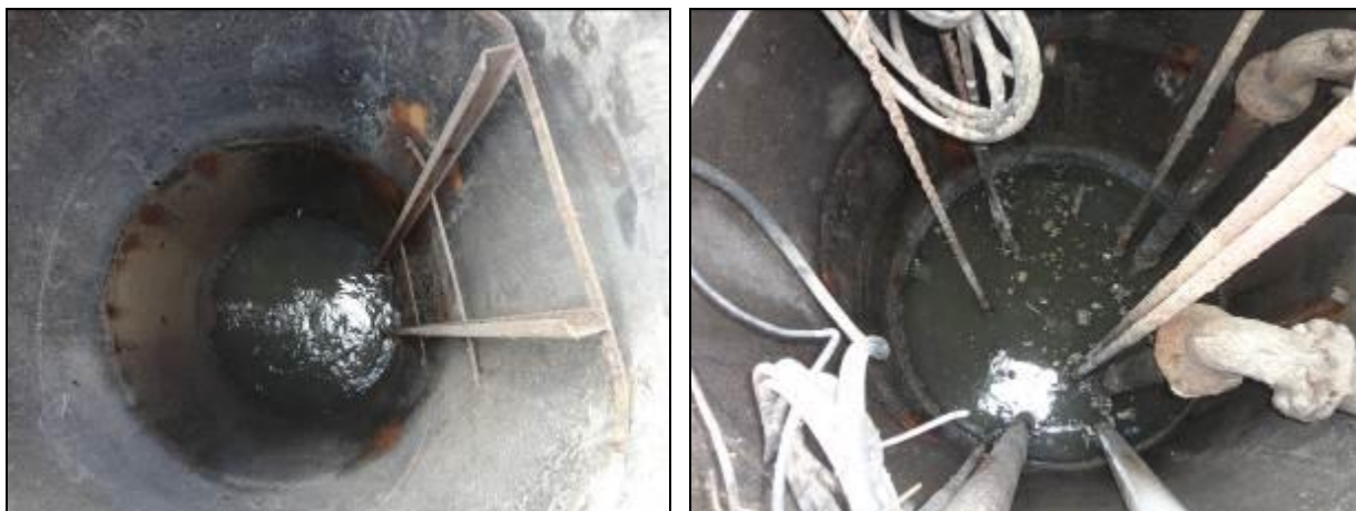
Figura 138: Vista interna do poço de chegada e do poço úmido
