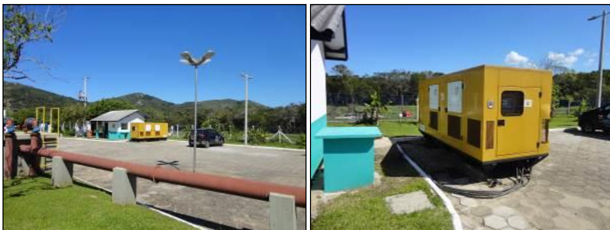
Figura 69: Gerador da ETE
