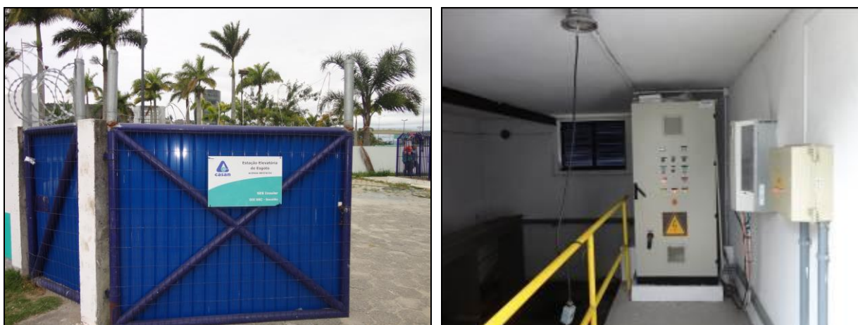
Figura 174: Vista do acesso e quadro de comando da EEE
