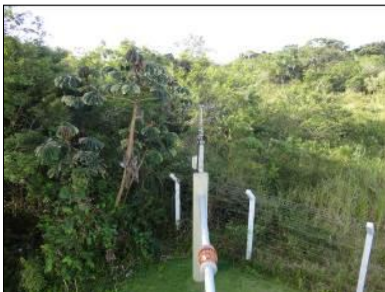
Figura 40: Queimador de gases do Reator UASB
