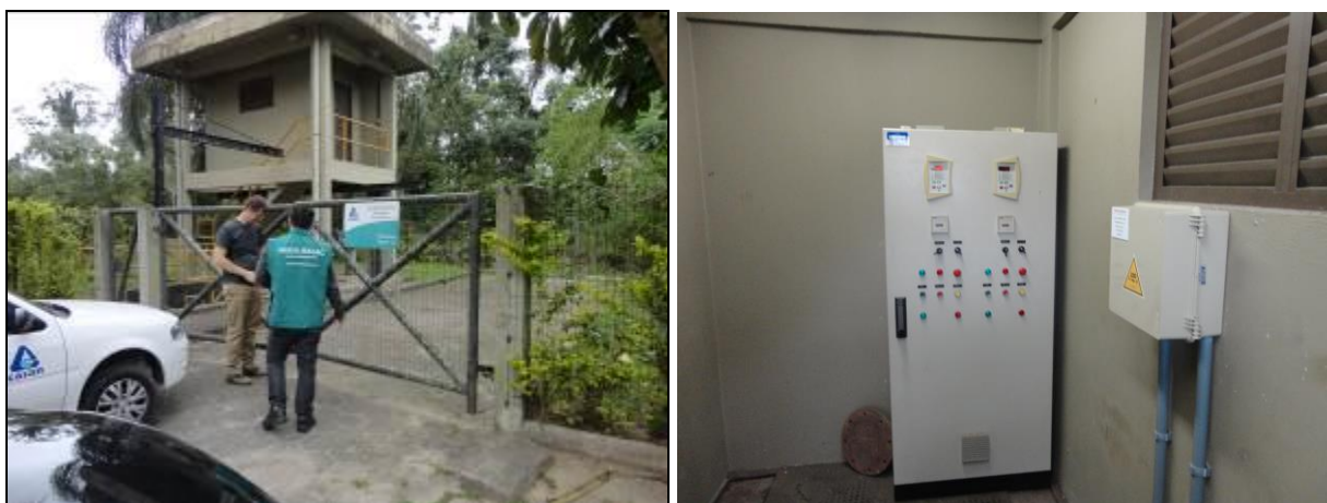
Figura 189: Vista geral da EEE e quadro de comando
