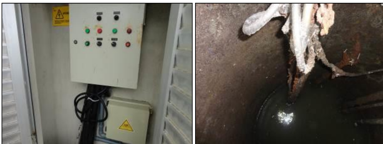
Figura 132: Vista do Quadro de comando e interna do poço úmido
