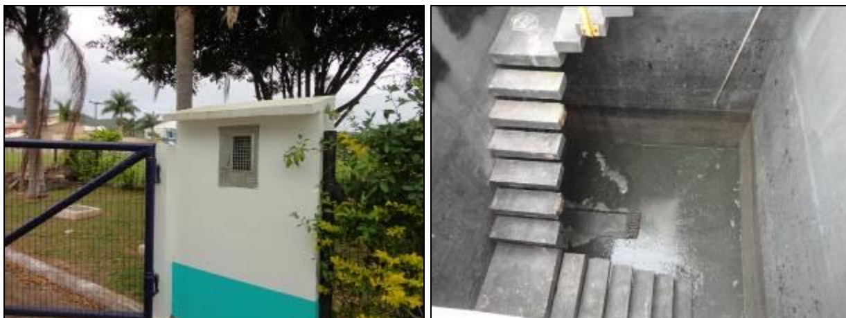
Figura 193: Vista do quadro de energia e do poço de chegada do efluente
