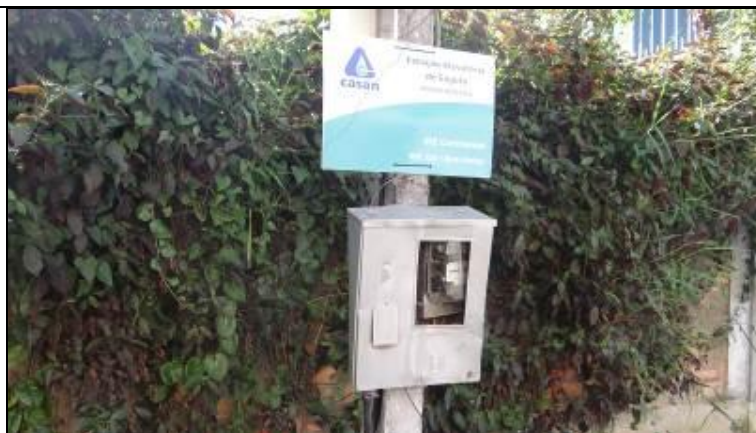
Figura 156: Vista do quadro de energia e painel de controle fixado no poste sobre a calçada
