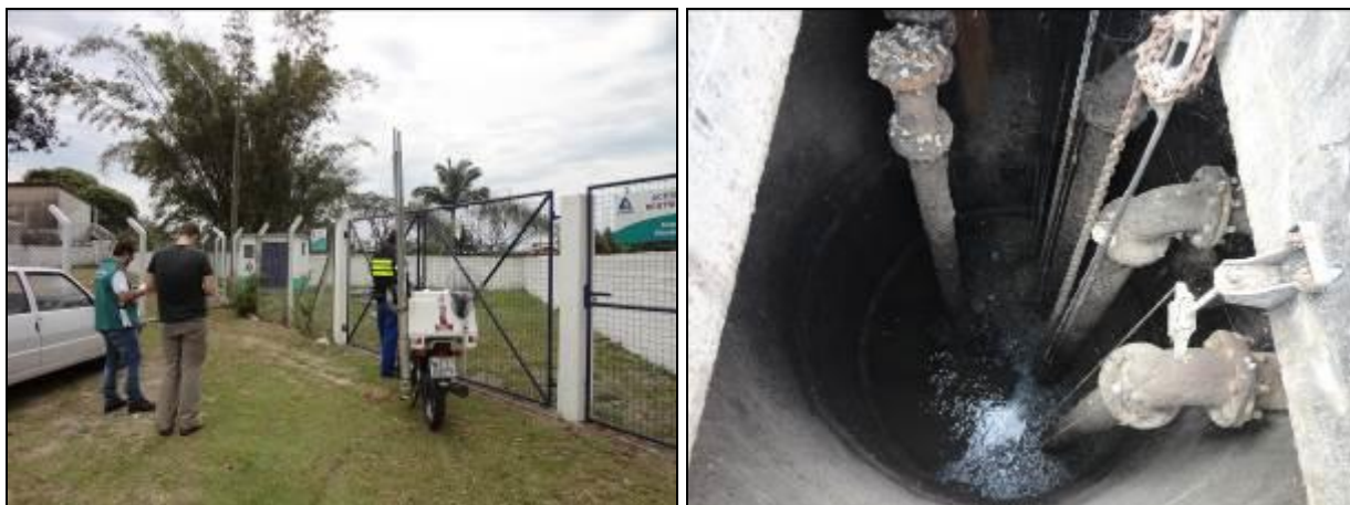
Figura 108: Vista externa e interna do poço úmido
