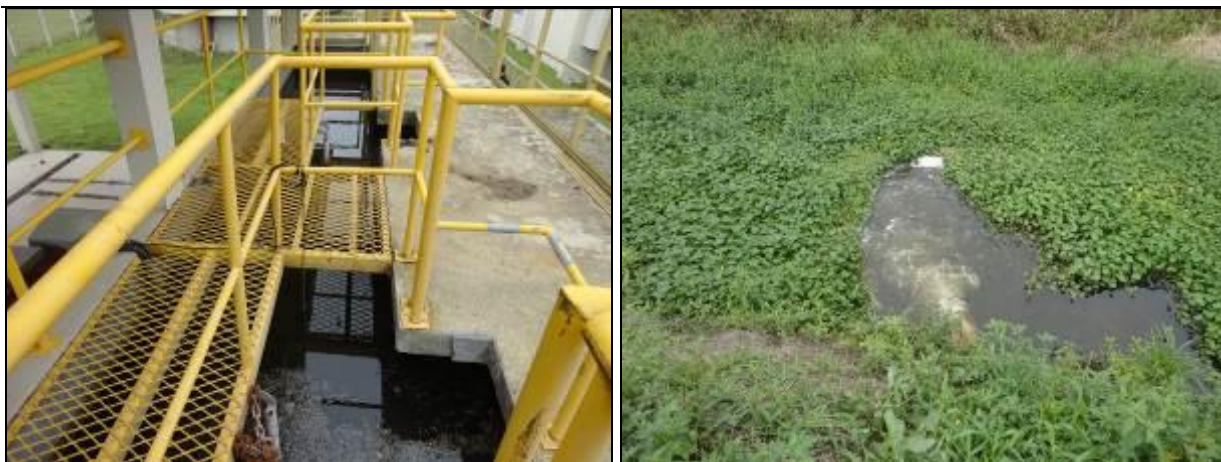
Figura 141: Vista geral da elevatória e da área de extravasamento
