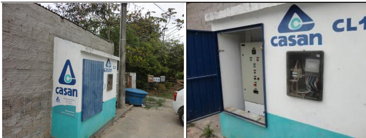
Figura 136: Vista da Casa de comando e painel de controle
