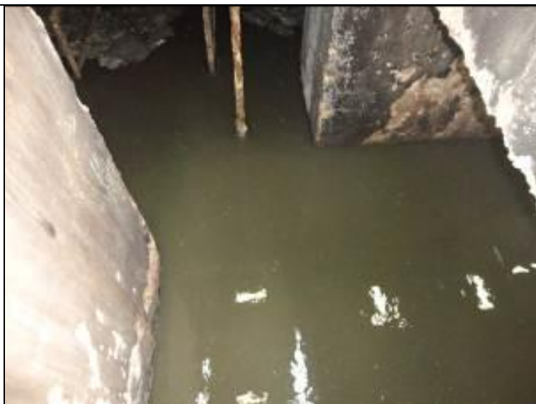
Figura 179: Vista do poço de chegada do efluente
