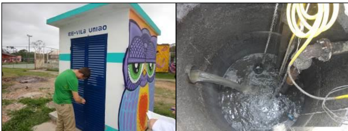
Figura 144: Vista externa da casa de comando e interna do poço úmido
