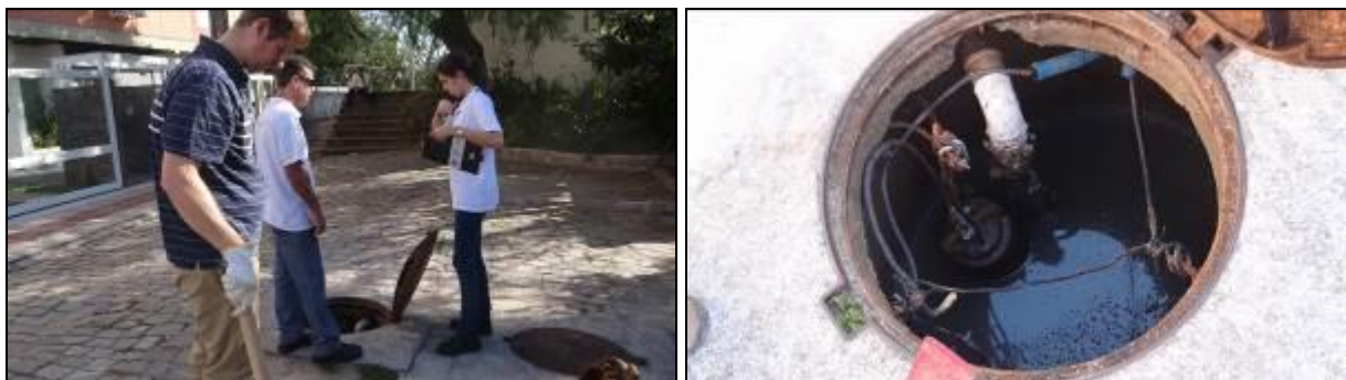
Figura 155: Vista Geral do EEE J2A Bom Abrigo e poço úmido com lodo sobrenadante
