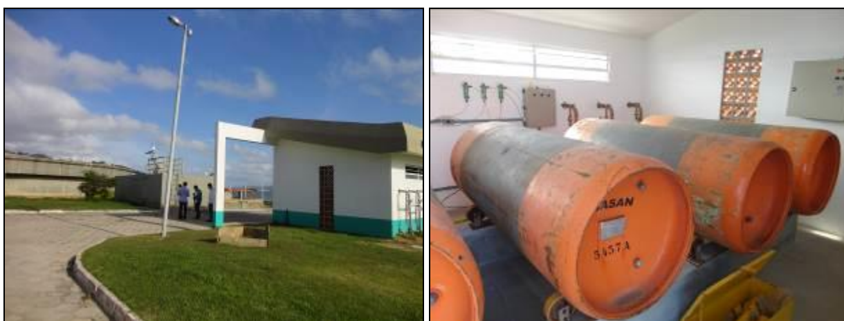
Figura 12: Local de desinfecção e armazenamento do cloro gás
