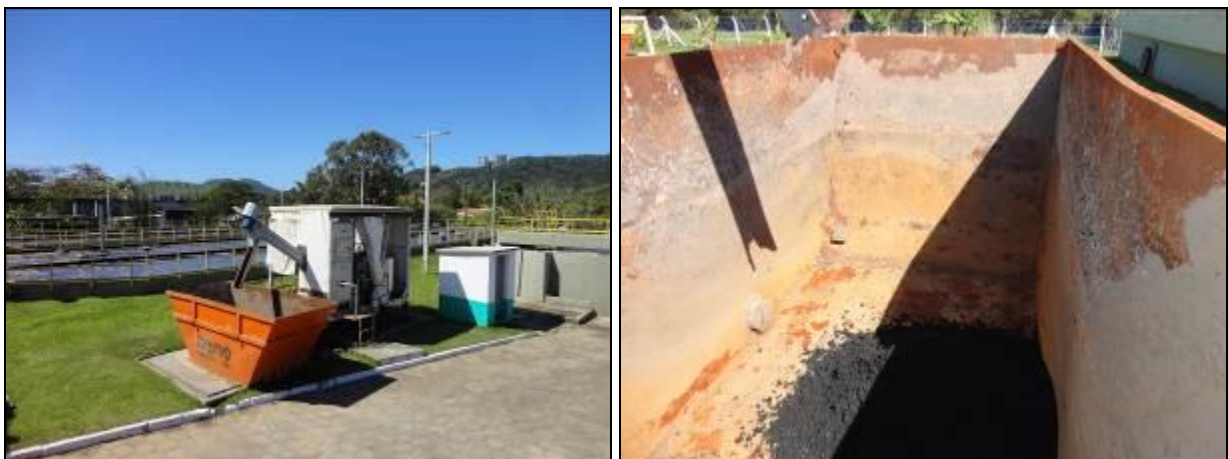
Figura 68: Centrífuga e lodo desidratado
