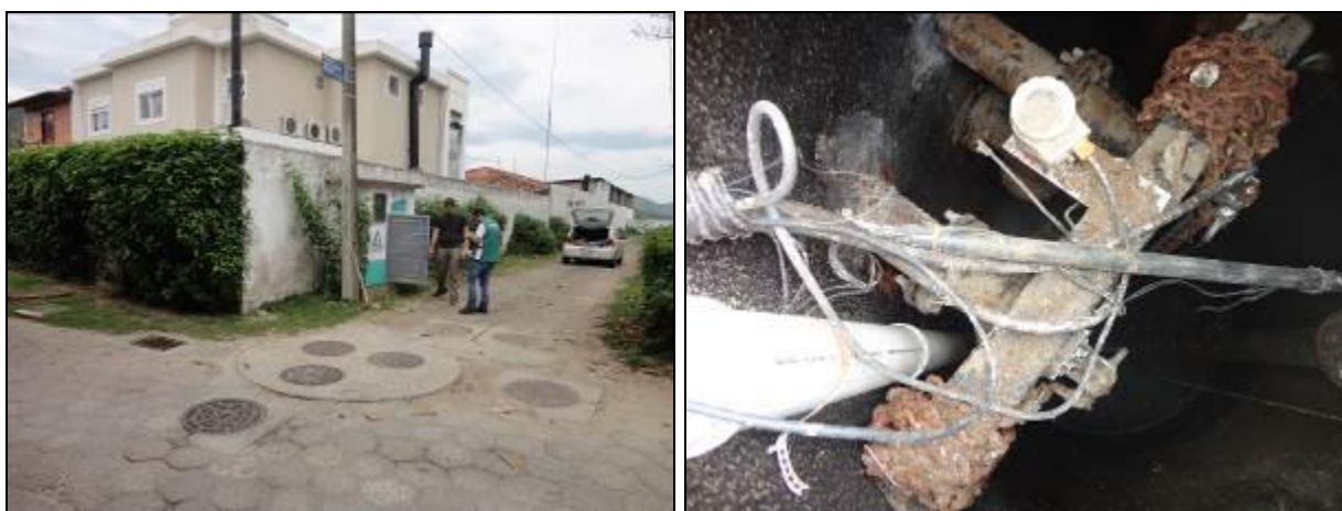
Figura 101: Vista externa e interna do poço úmido
