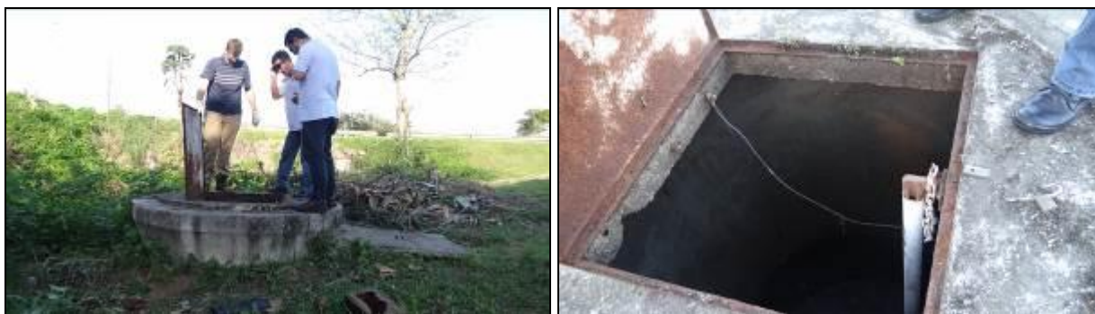
Figura 169: Vista externa e interna do poço úmido
