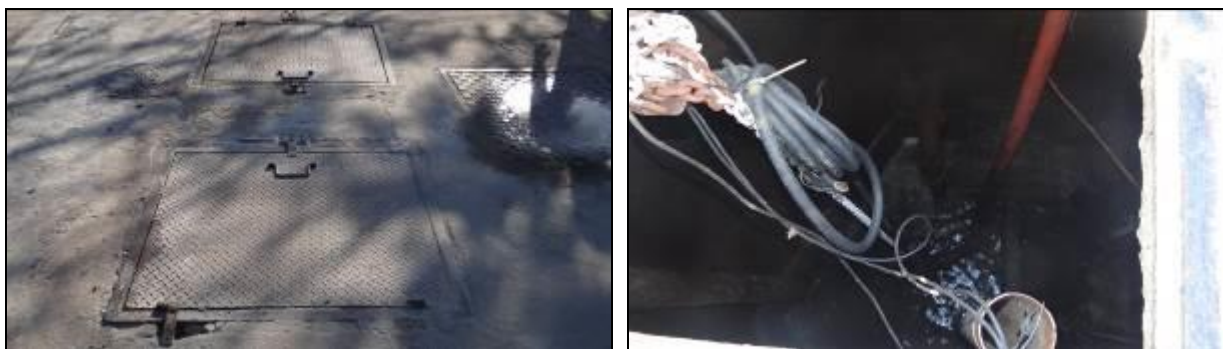
Figura 161: Vista externa e interna do poço úmido
