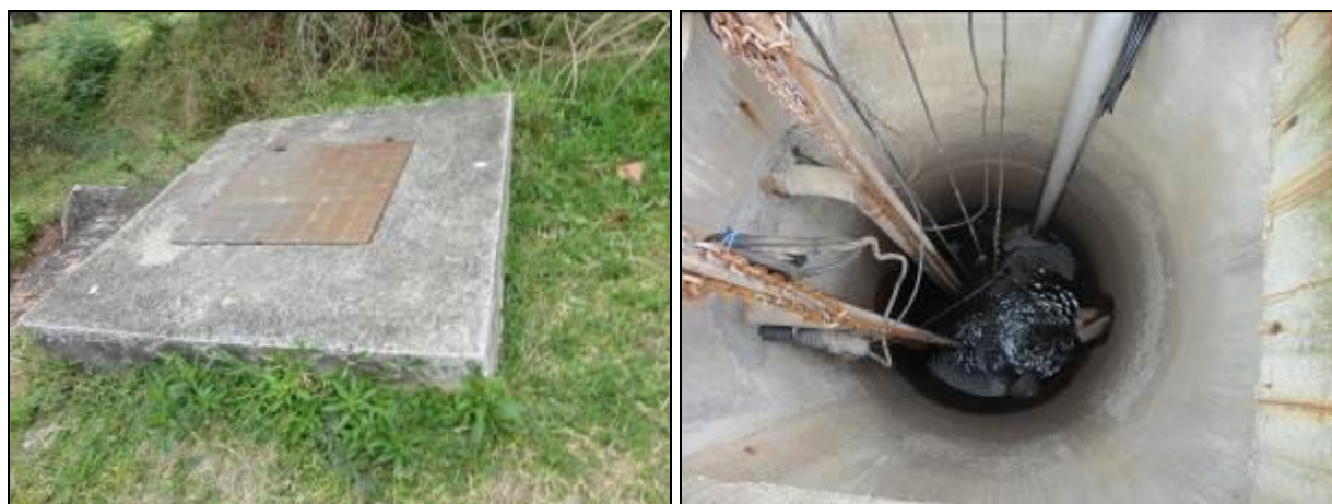
Figura 236: Vista externa e interna do poço úmido
