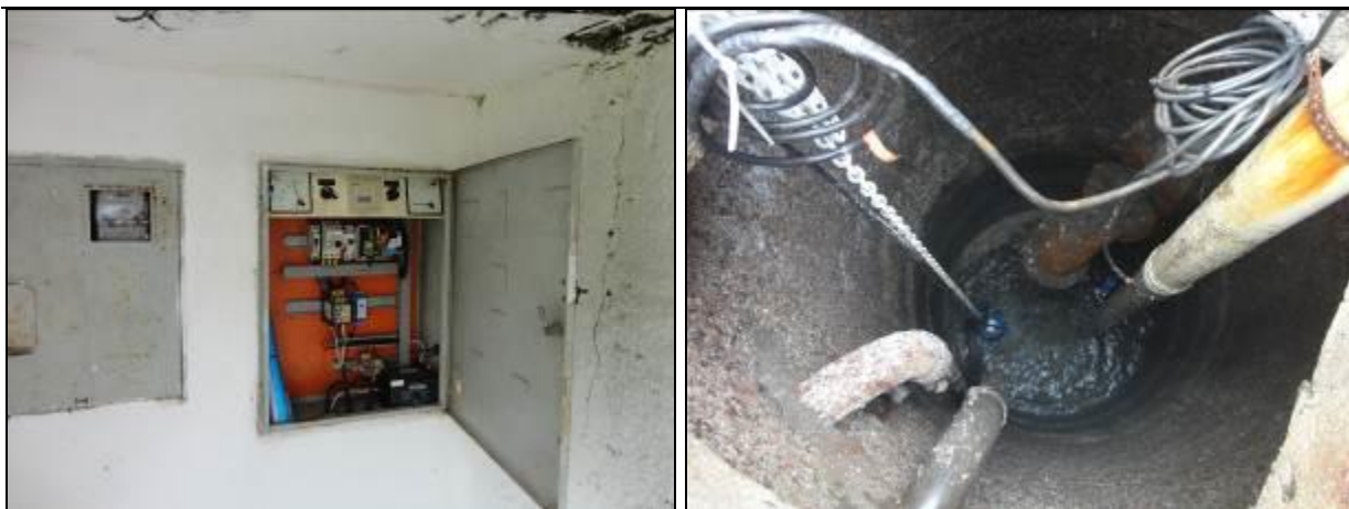
Figura 242: Vista interna da casa de comando e do poço úmido
