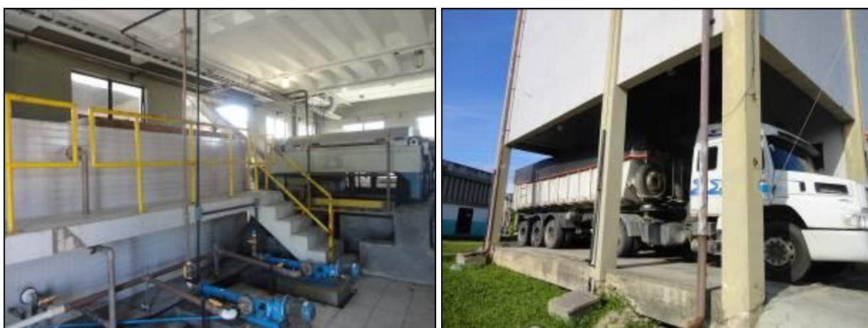
Figura 13: Centrífuga e caminhão para o descarte do lodo desidratado
