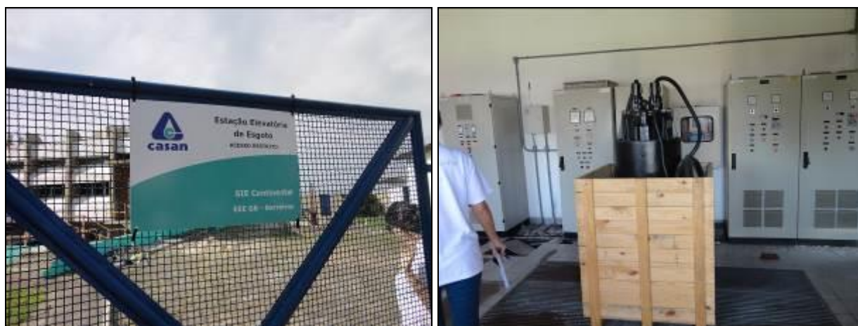
Figura 159: Acesso a EEE e sala de comando com bomba reserva
