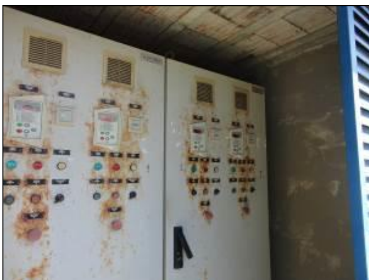
Figura 71: Quadros de comando enferrujados
