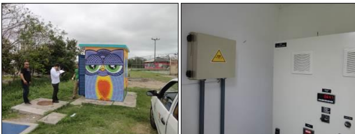
Figura 145: Vista externa do poço úmido e interna do painel de controle
