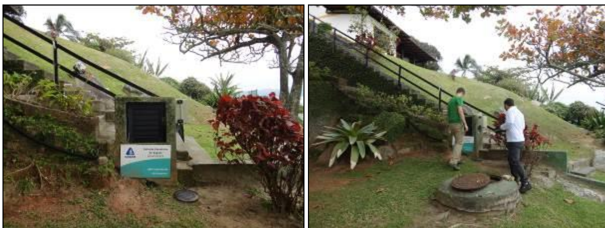
Figura 133: Vista geral da EEE
