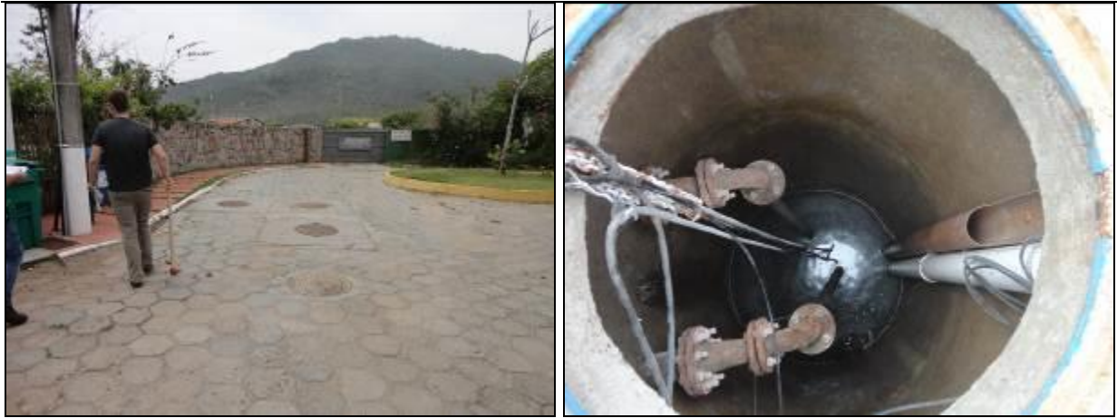
Figura 238: Vista externa e interna do poço úmido
