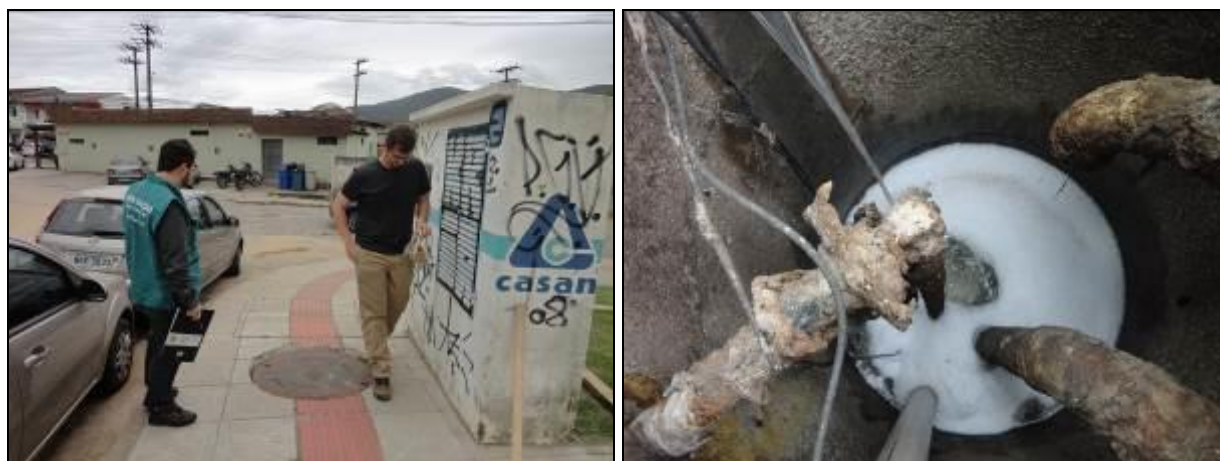
Figura 208: Vista externa e interna do poço úmido
