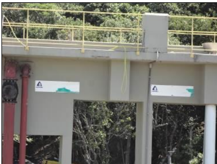
Figura 70: Placas de identificação das unidades danificadas
