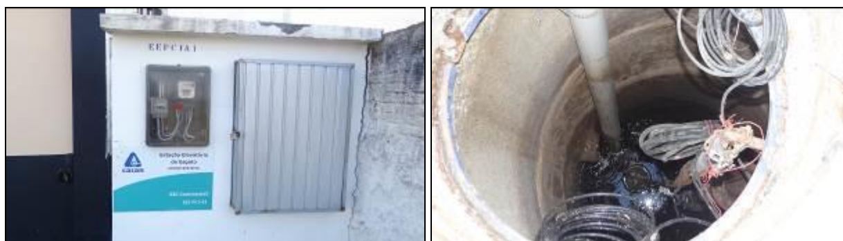
Figura 172: Vista externa da casa de comando e interna do poço úmido
