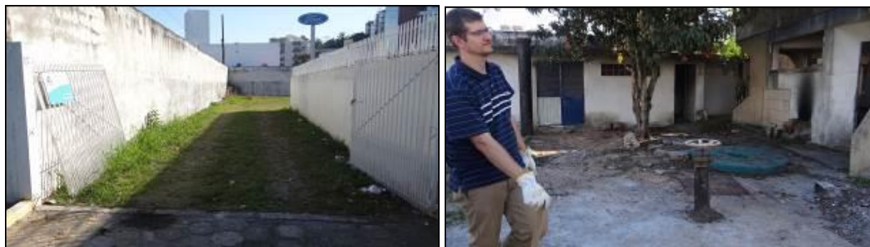
Figura 148: Acesso a EEE com portões quebrados e vista externa da casa de comando e do poço úmido
