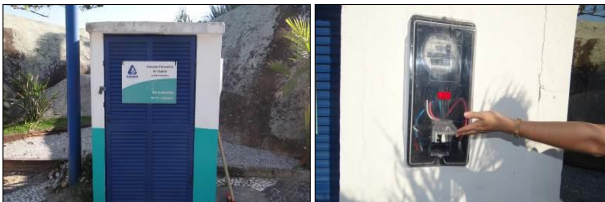
Figura 162: Vista geral do quadro de comando e energia
