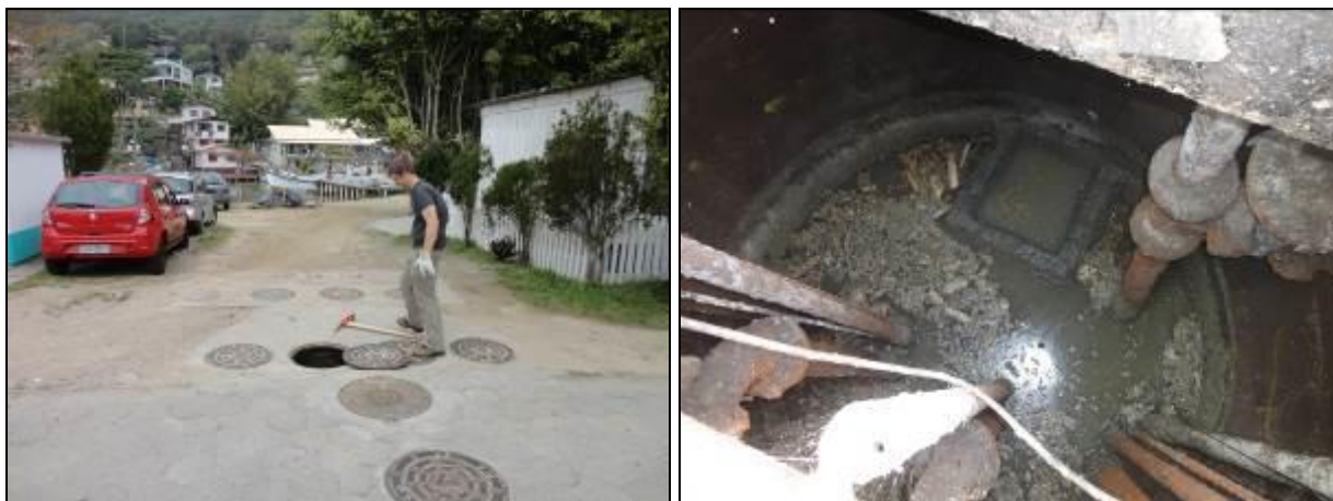
Figura 106: Vista externa e interna do poço úmido
