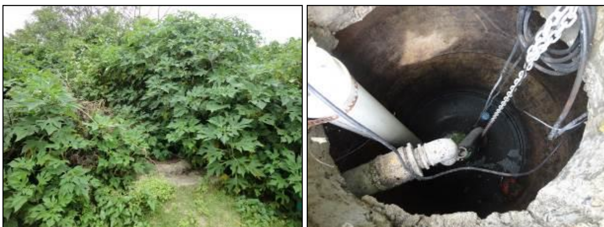
Figura 222: Vista externa e interna do poço úmido
