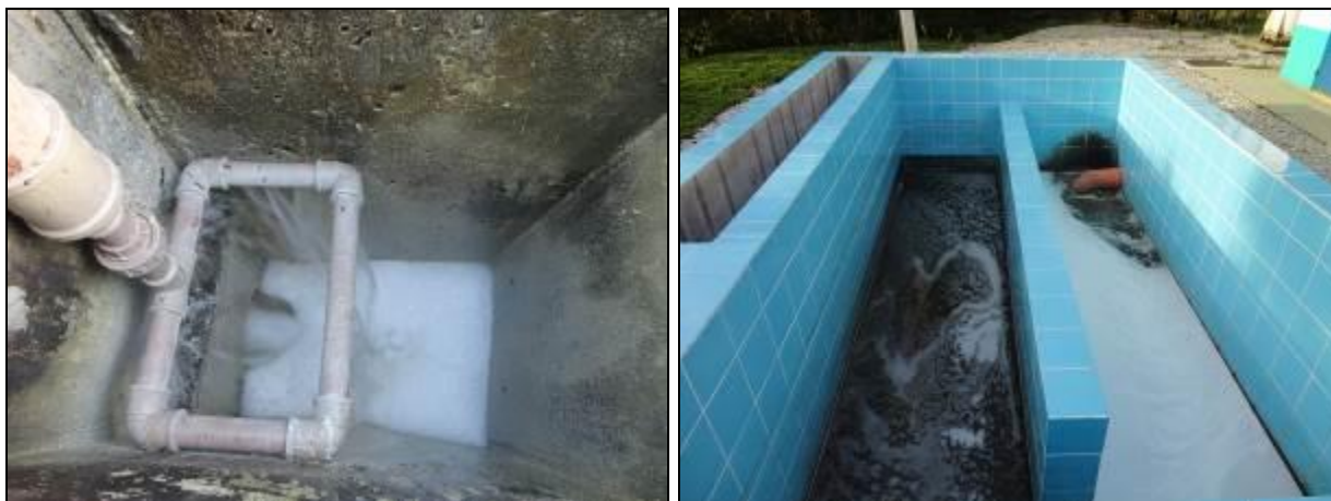
Figura 27: Dosagem do cloro e tanque de contato (novo)
