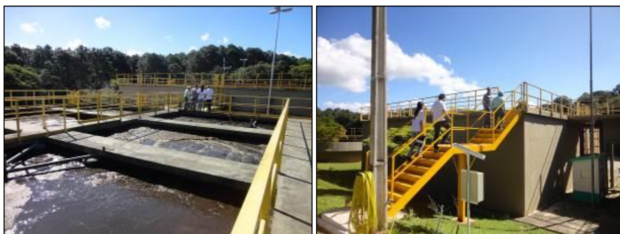
Figura 79: Tanques de aeração
