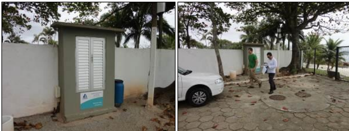
Figura 131: Vista da Casa de comando e externa do poço úmido
