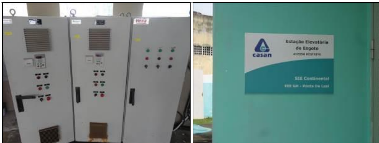
Figura 165: Painel de controle e porta de acesso
