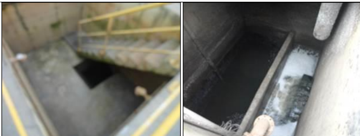
Figura 124: Vista externa e interna do poço úmido
