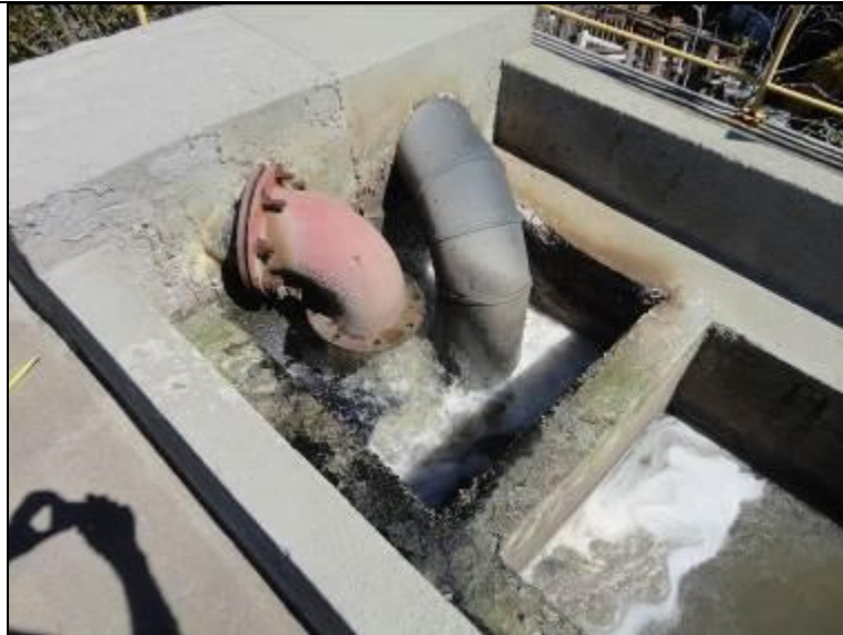
Figura 62: Entrada do efluente
