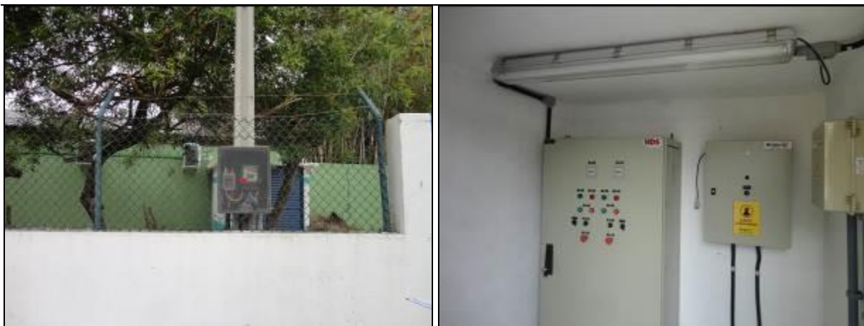
Figura 130: Vista do Quadro de energia e painel de controle
