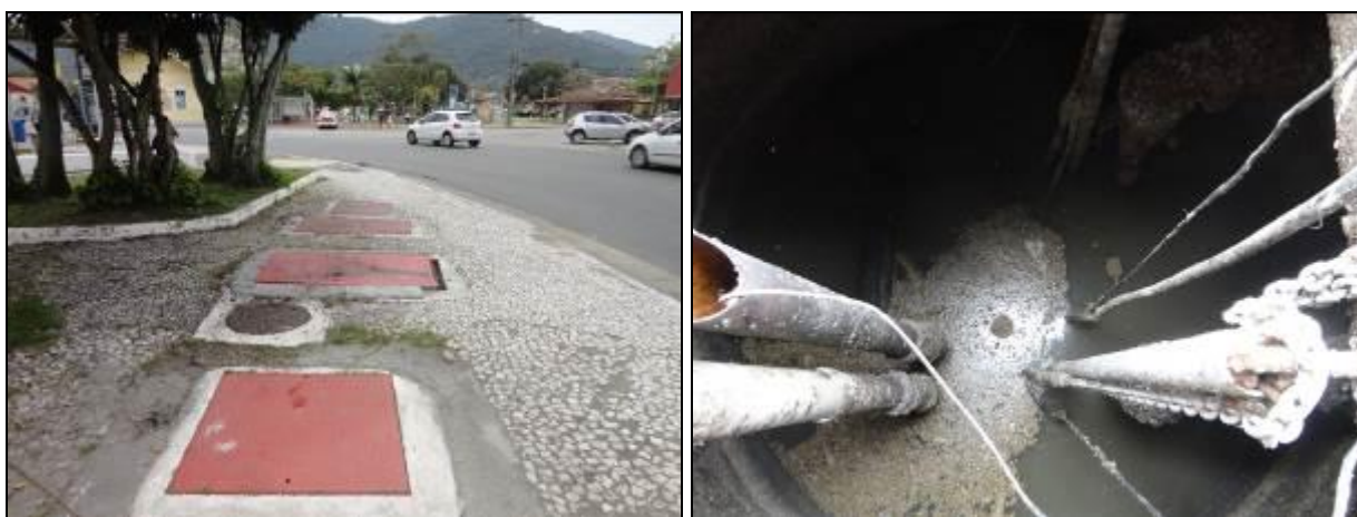
Figura 214: Vista externa e interna do poço úmido
