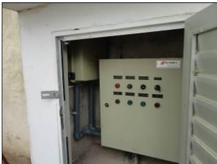
Figura 122: Vista interna da casa de comando
