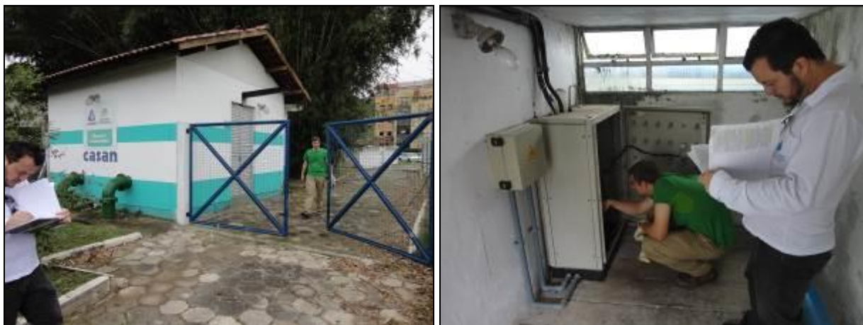
Figura 233: Vista externa da EEE e interna do quadro de comando
