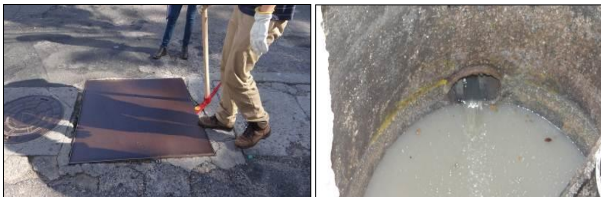
Figura 168: Vista externa e interna do poço úmido
