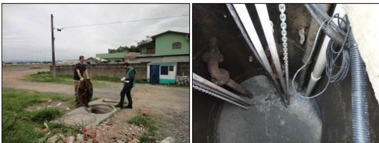
Figura 206: Vista externa e interna do poço úmido
