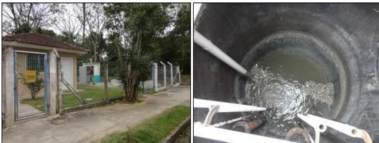
Figura 194: Vista externa da EEE e interna do poço úmido
