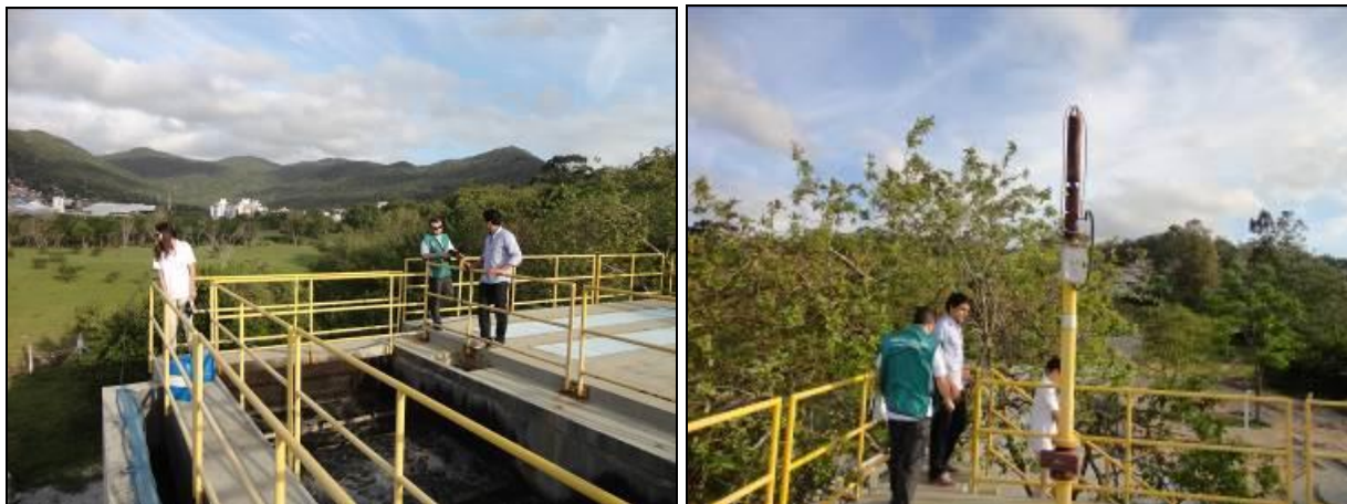
Figura 25: Reator UASB, Filtro aerado submerso e Queimador de gás do reator UASB
