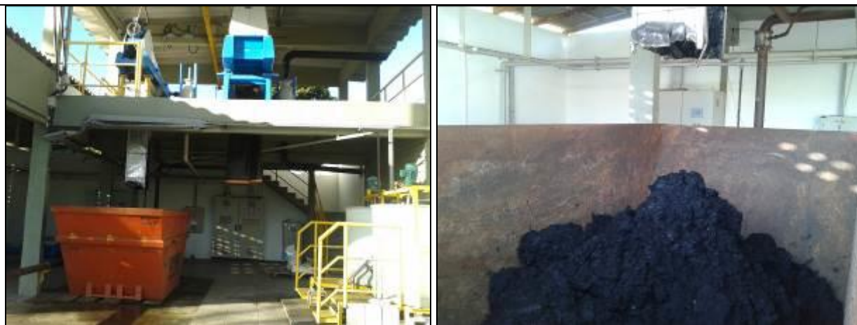
Figura 44: Área das centrífugas e lodo desidratado
