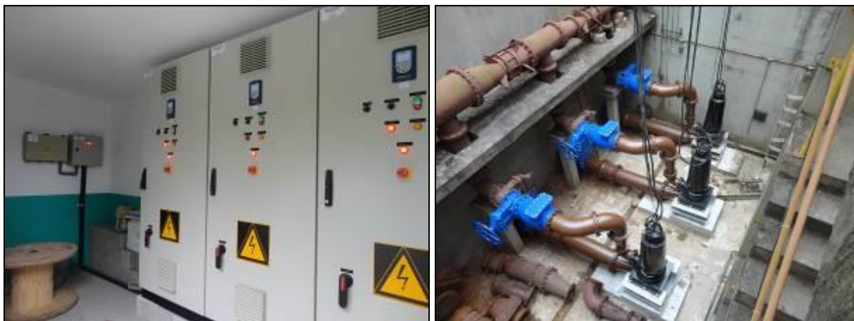
Figura 177: Vista do Quadro de comando e bombas
