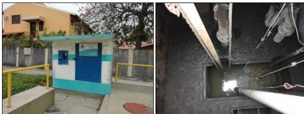
Figura 118: Vista externa da casa de comando e interna do poço úmido
