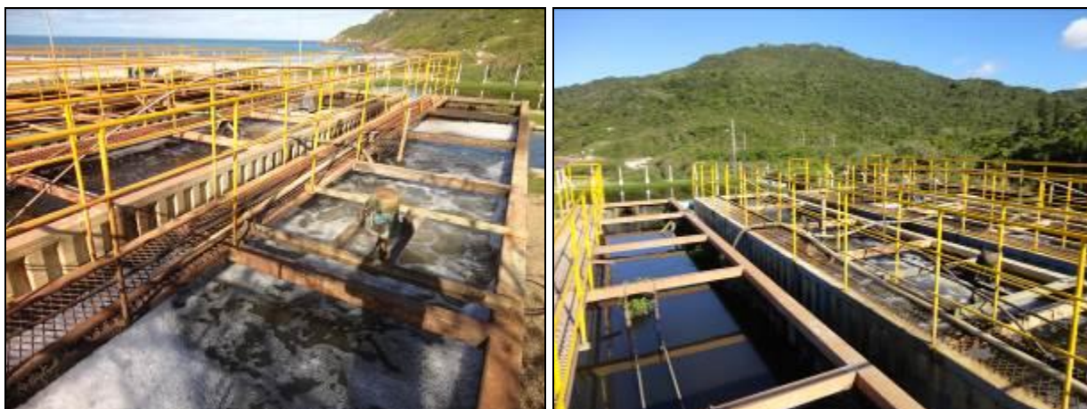
Figura 52: Tanques de aeração e decantador
