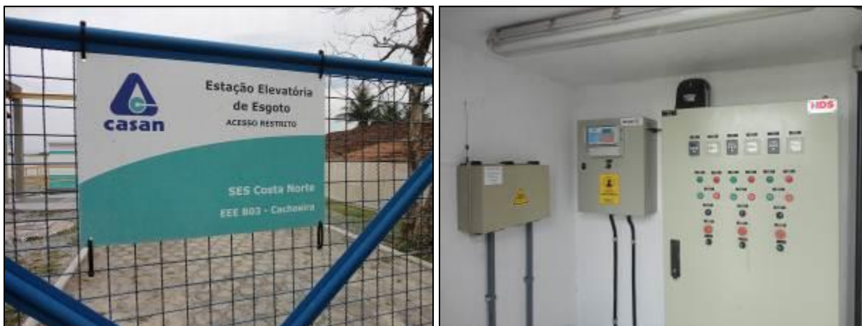
Figura 128: Acesso com placas de identificação e painel de controle
