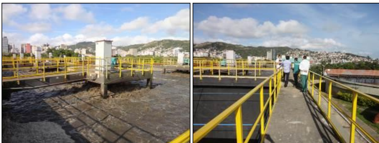
Figura 10: Tanque de aeração em operação
