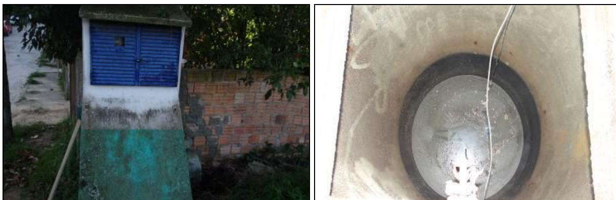
Figura 170: Vista externa da casa de comando e interna do poço úmido
