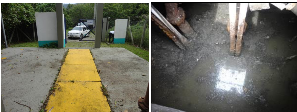
Figura 230: Vista externa e interna do poço úmido (Acompanhamento set 2014)
