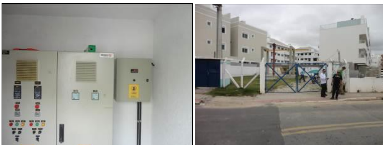
Figura 140: Vista interna do painel de controle e geral da EEE
