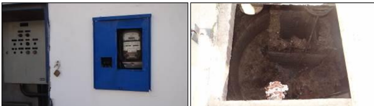
Figura 157: Vista da casa de comando e poço úmido com muito lodo sobrenadante
