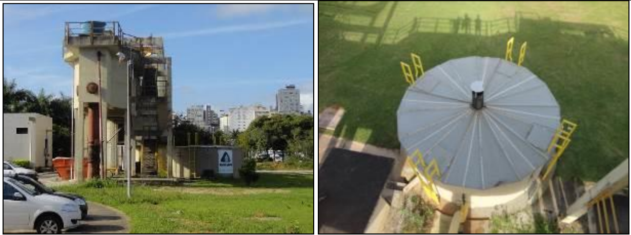
Figura 3: Biofiltro instalado para coletar os gases da unidade de pré-tratamento
