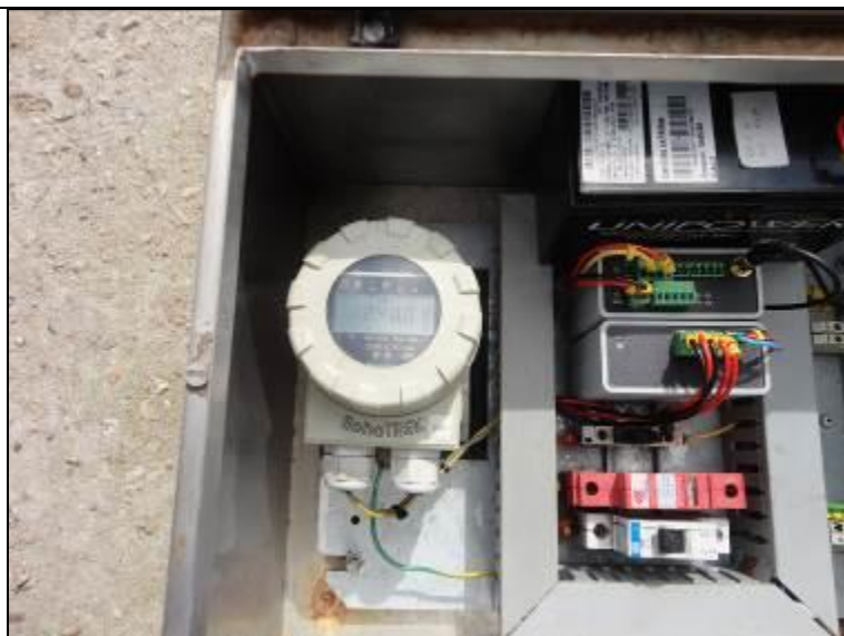
Figura 90: Medidor de vazão do efluente tratado
