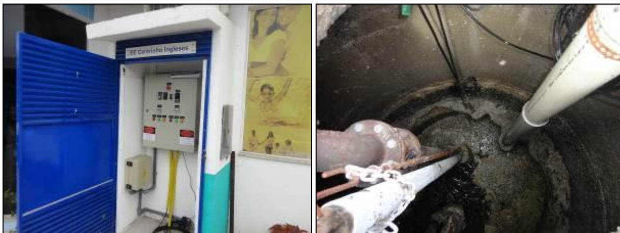
Figura 147: Vista interna do Painel de controle e do poço úmido
