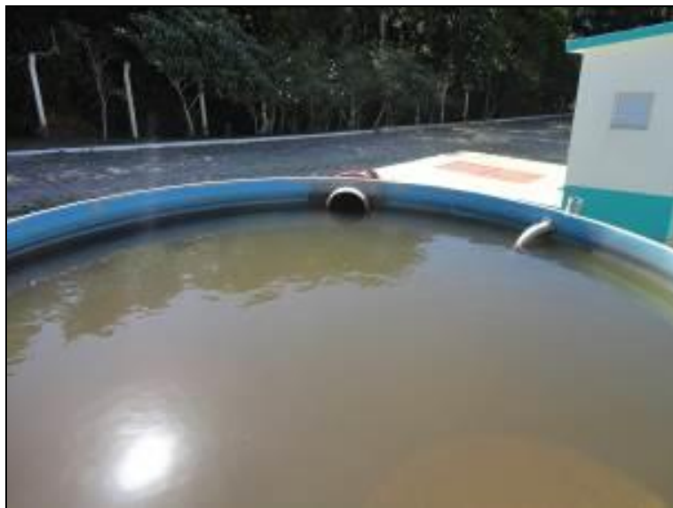
Figura 81: Tanque de contato
