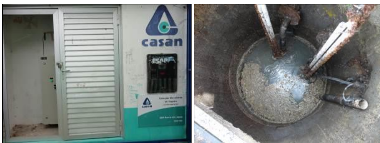
Figura 110: Vista externa da casa de comando e vista interna do poço úmido
