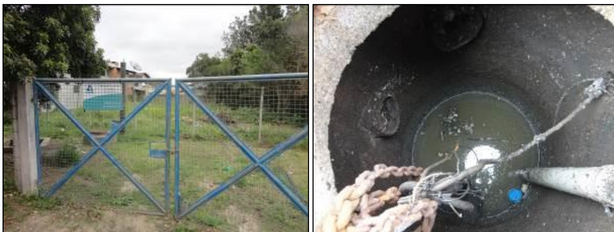
Figura 143: Entrada da EEE e vista interna do poço úmido
