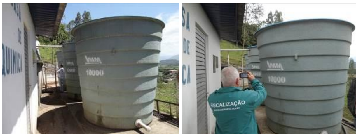
Figura 10: Reservatórios junto à ETA Nascente Tomazi (Inicial e Acompanhamento)
