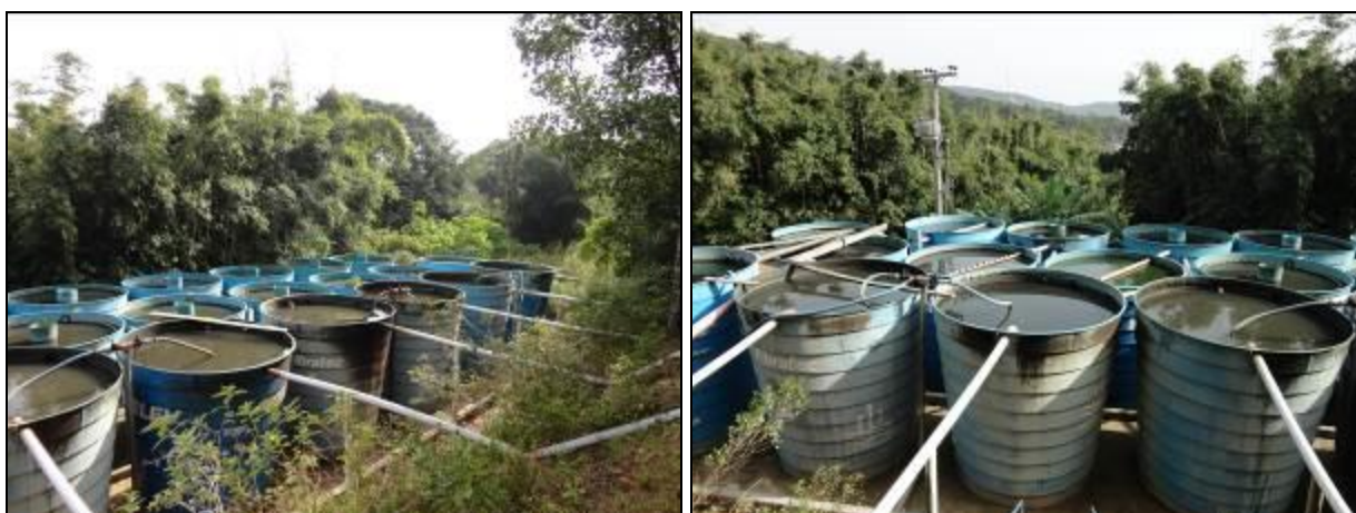
Figura 45: Sistema de tratamento de esgoto de bombinhas
