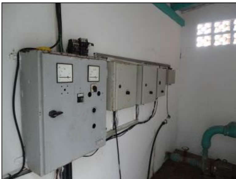
Figura 39: Quadro de comando da ERAT
