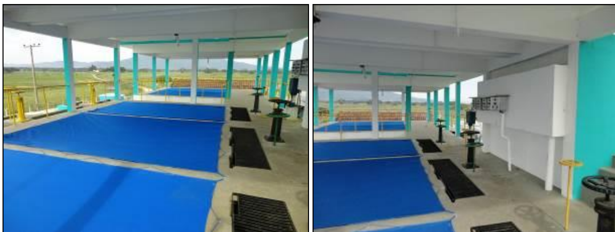
Figura 193: Filtros da ETA Porto Belo
