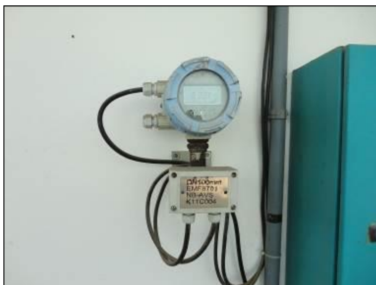
Figura 256: Quadro de energia e macromedidor
