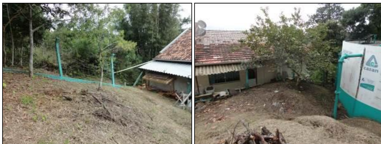
Figura 29: Cercas danificadas e sem proteção no limite do reservatório
