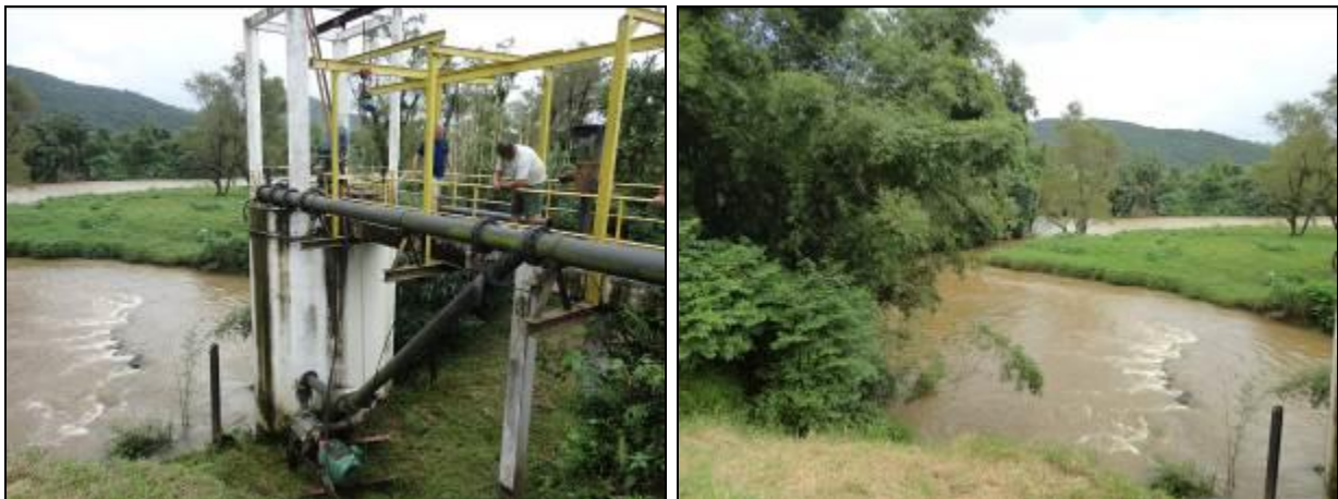
Figura 1: Vista geral da área de captação de água bruta do Rio Braço do Norte (03/04/2014)
