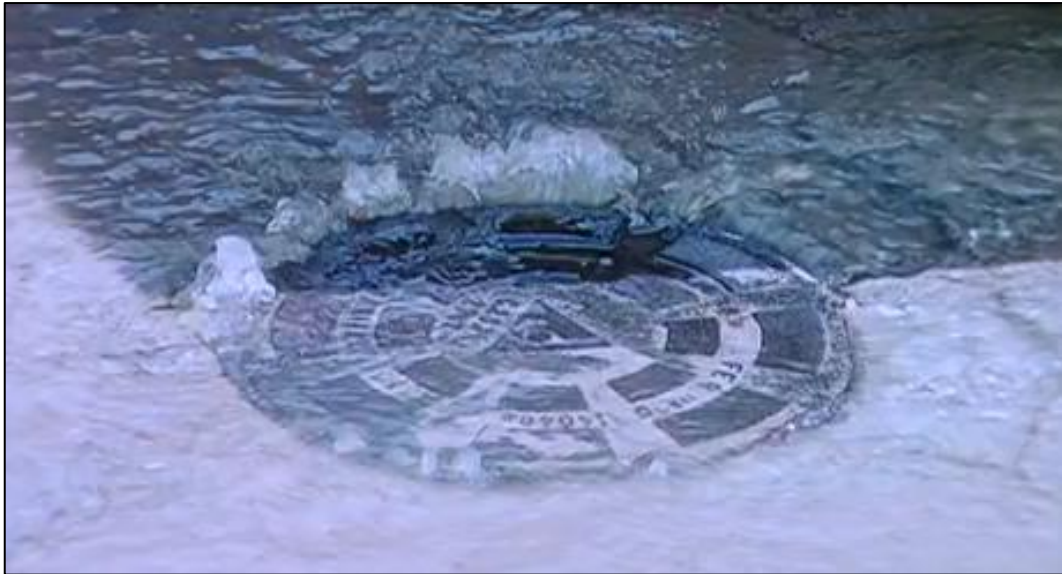
Figura 1: Caixa coletora com vazamento flagrado por um usuário (foto enviada pelo denunciante)
