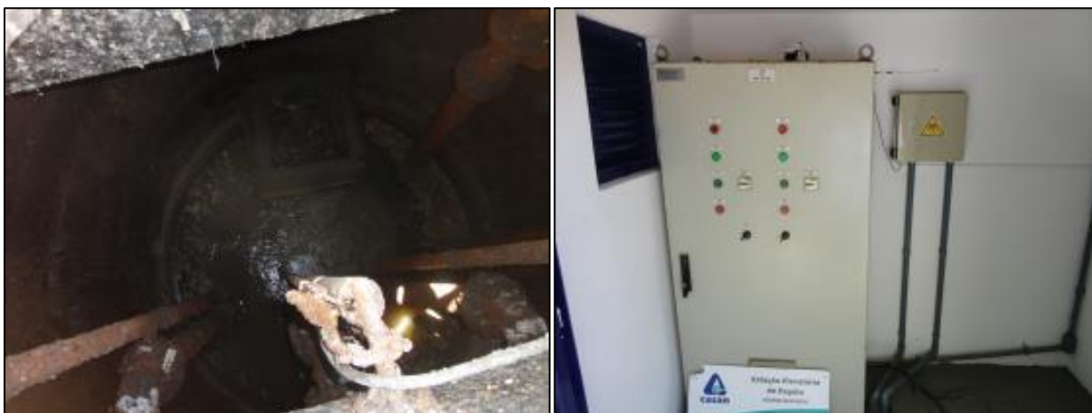
Figura 5: Poço úmido (à esquerda) e painel de controle com a telemetria em fase de validação (à direita) (28/01/2014)
