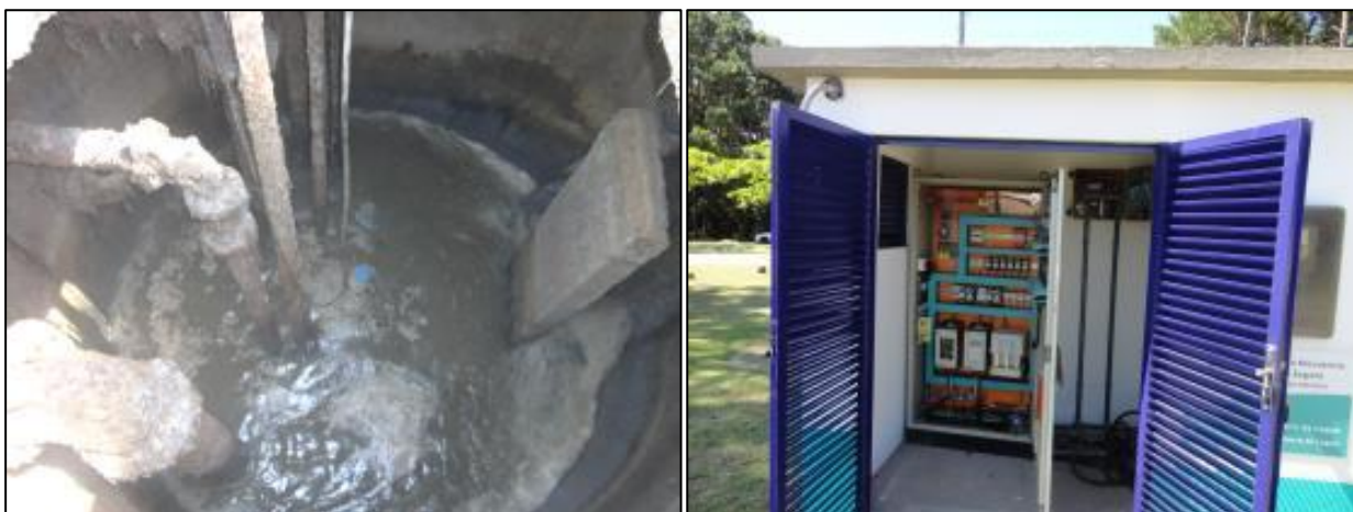
Figura 7: Poço úmido (à esquerda) e painel com controle com a telemetria em fase de validação (à direita) (28/01/2014)
