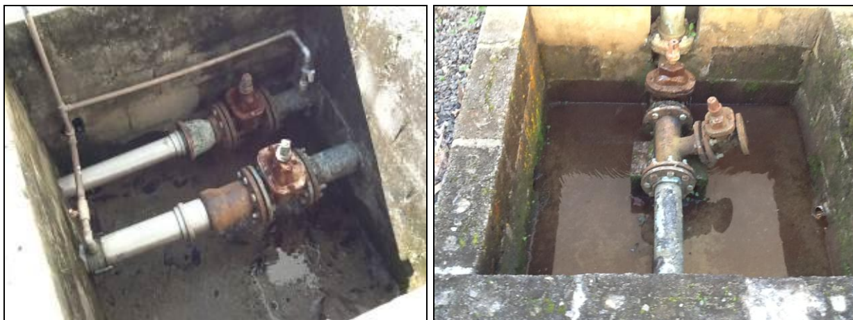
Outros equipamentos de acompanhamento da ETA.
