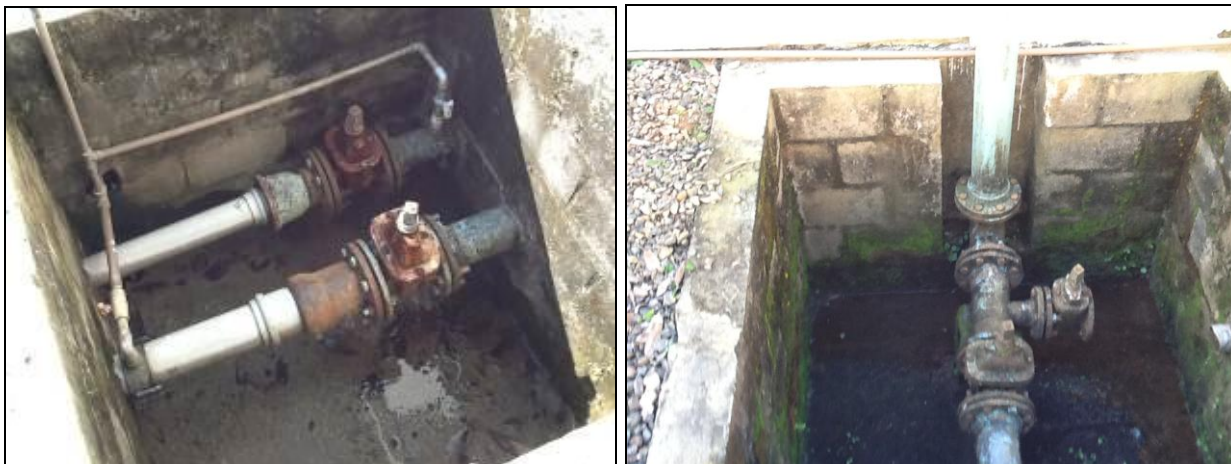
Algumas estruturas apresentam pequenos vazamentos.
