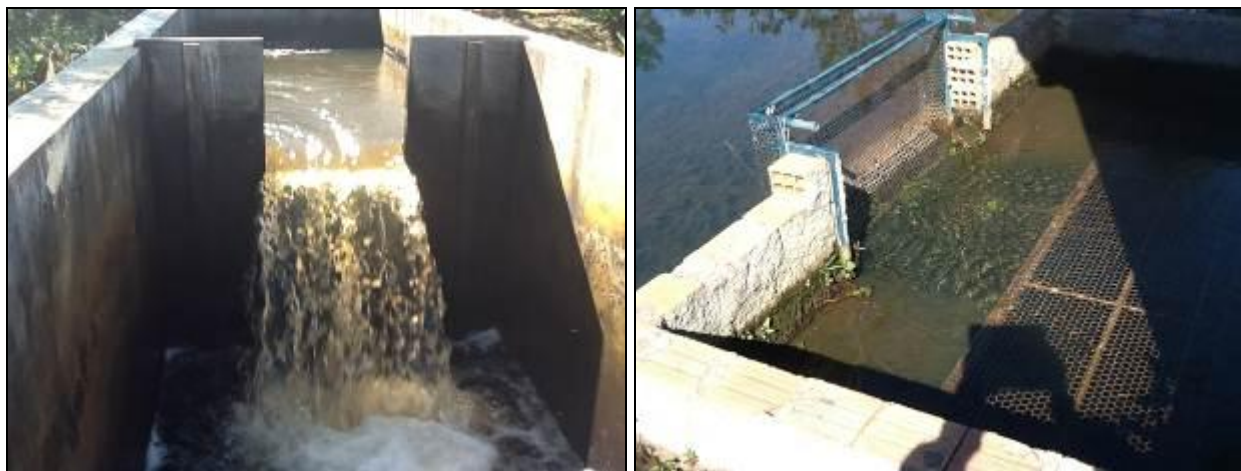
Entradas de água bruta da ETA do Gi. Coordenadas UTM: 0716699 / 6849052
