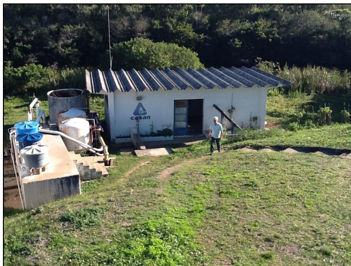
Vista geral do tratamento químico da ETA Laguna
