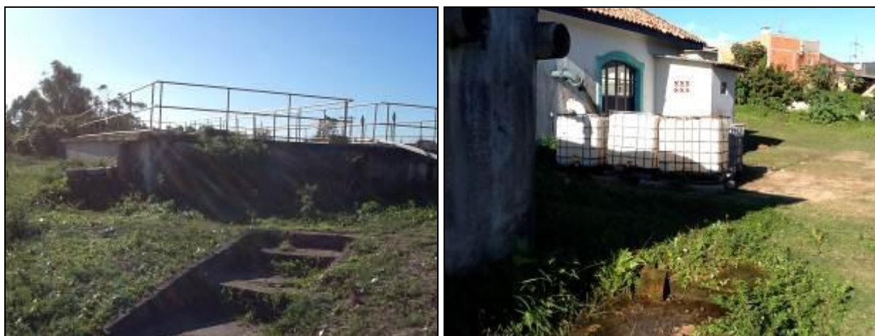
Áreas externas em mal estado de conservação.
