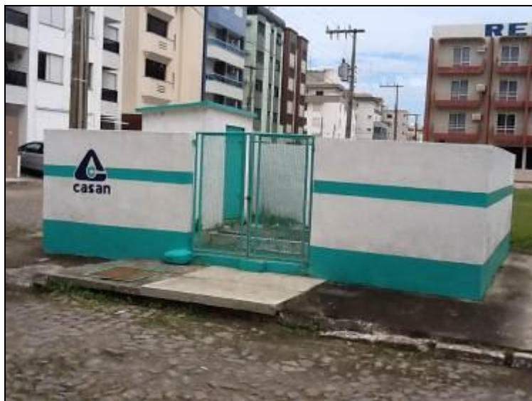
Elevatória de Esgoto do Mar Grosso
