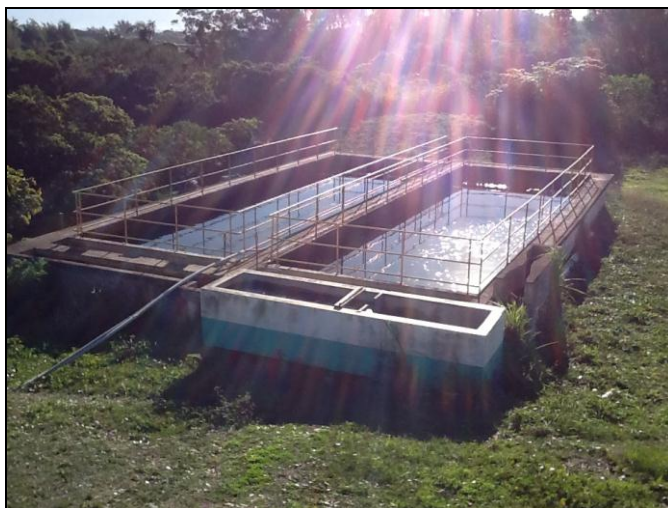
Sistema de tratamento físico
