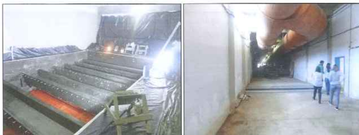
Figura 14: Filtro ascendente em manutenção (à esquerda) e tubulação dos filtros (à direita), em julho de 2016
