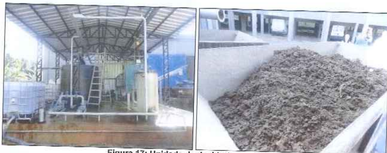
Figura 17: Unidade de desidratação de lodo
