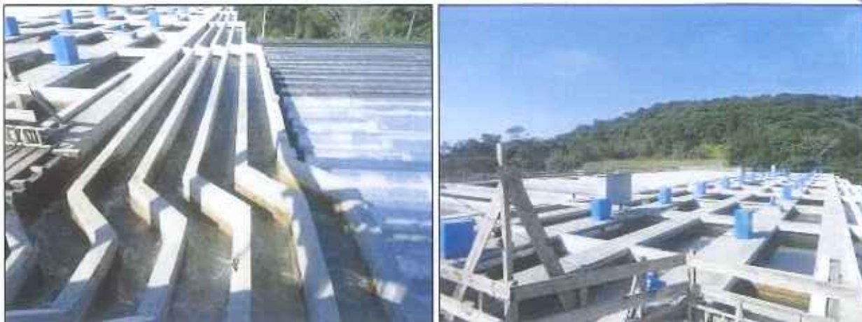
Figura 10: Canais de direcionamento da mistura rápida para as seis câmaras do floccodecantador, em julho de 2016
