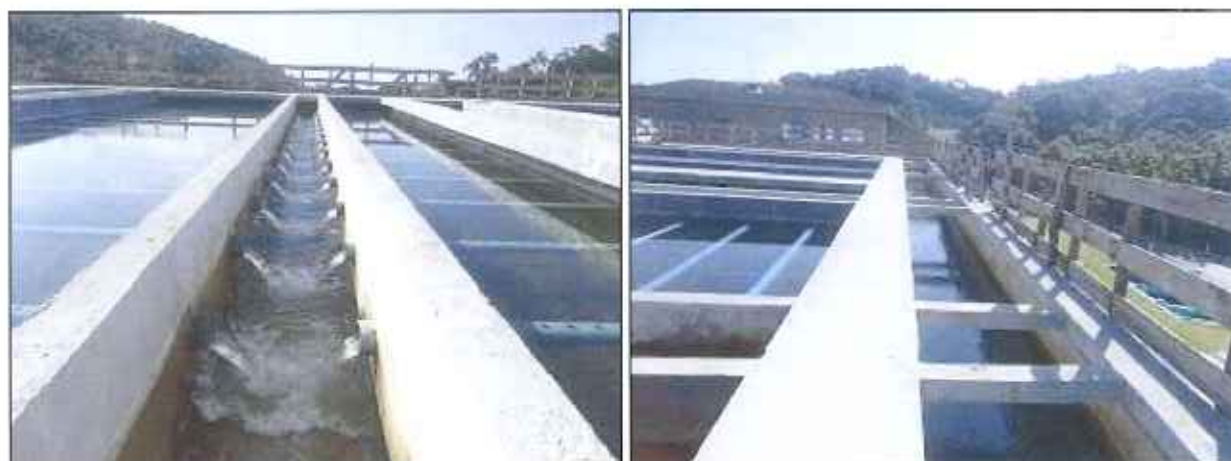
Figura 12: Canais de saída da água decantada, em julho de 2016
