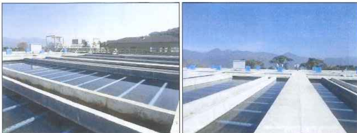
Figura 11: Câmaras de floccodecantador, em julho de 2016
