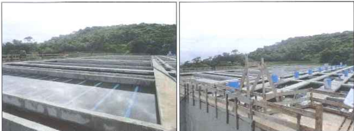
Figura 6: Flocodecantador da ETA na fase de pré-operação, em janeiro de 2016
