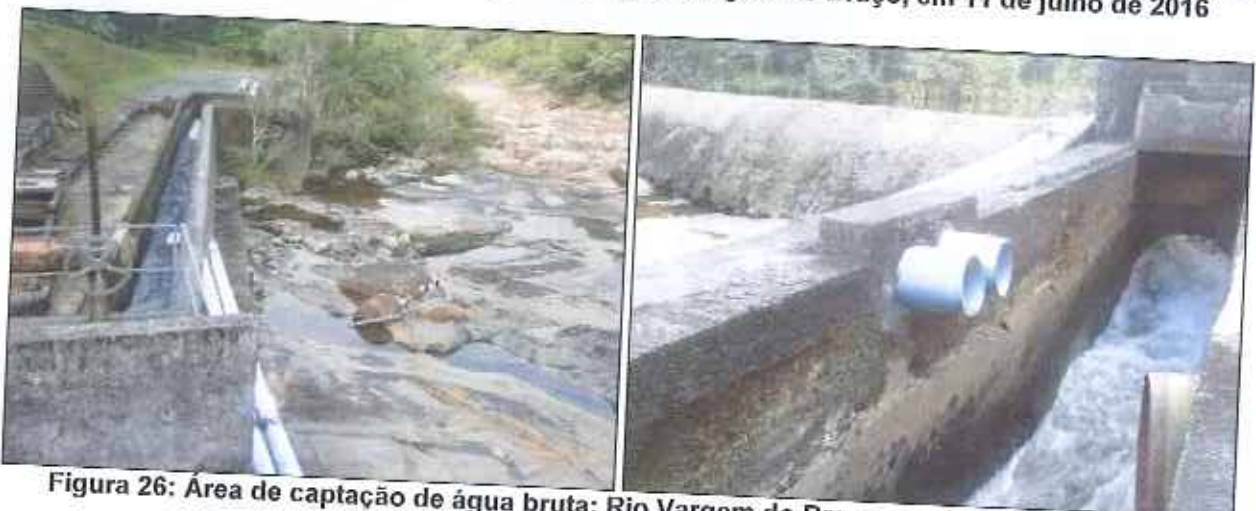
Figura 25: Área de captação de água bruta: Rio Vargem do Braço, em 11 de julho de 2016
