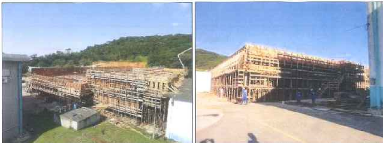
Figura 2: Situação das obras de ampliação da ETA nos meses de Abril (à esquerda) e Junho (à direita) de 2015
