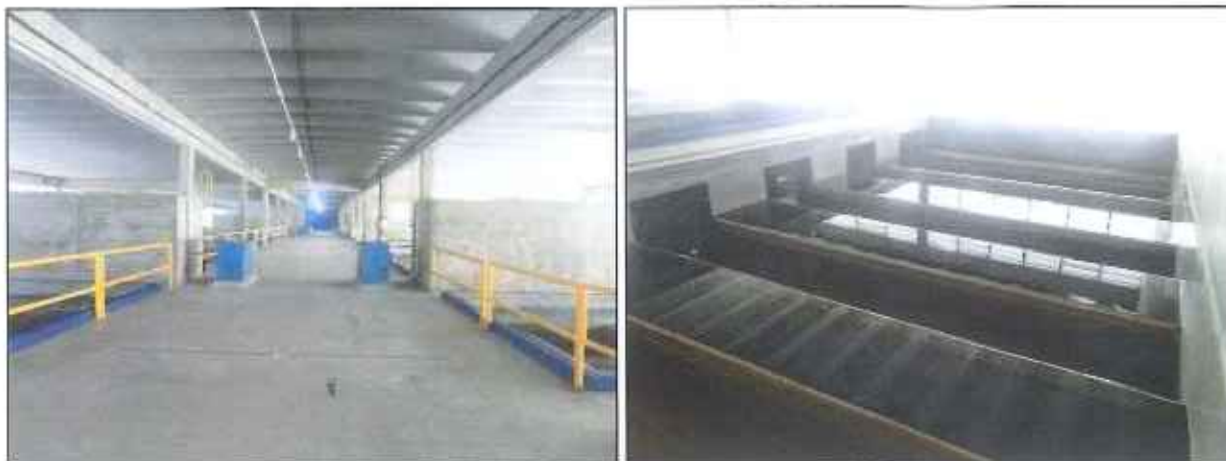
Figura 13: Filtros ascendentes, em julho de 2016
