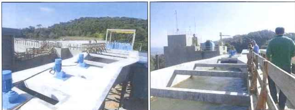
Figura 9: Unidade de mistura rápida com calha Parshall e três misturadores mecânicos, em julho de 2016
