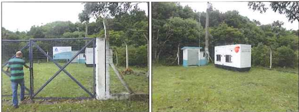
Figura 40: Gerador no Poço Paulinho da Matriz I
