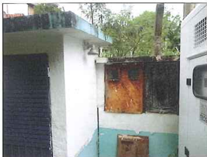
Figura 68: Quadro de energia queimado do Poço Edmundo III
