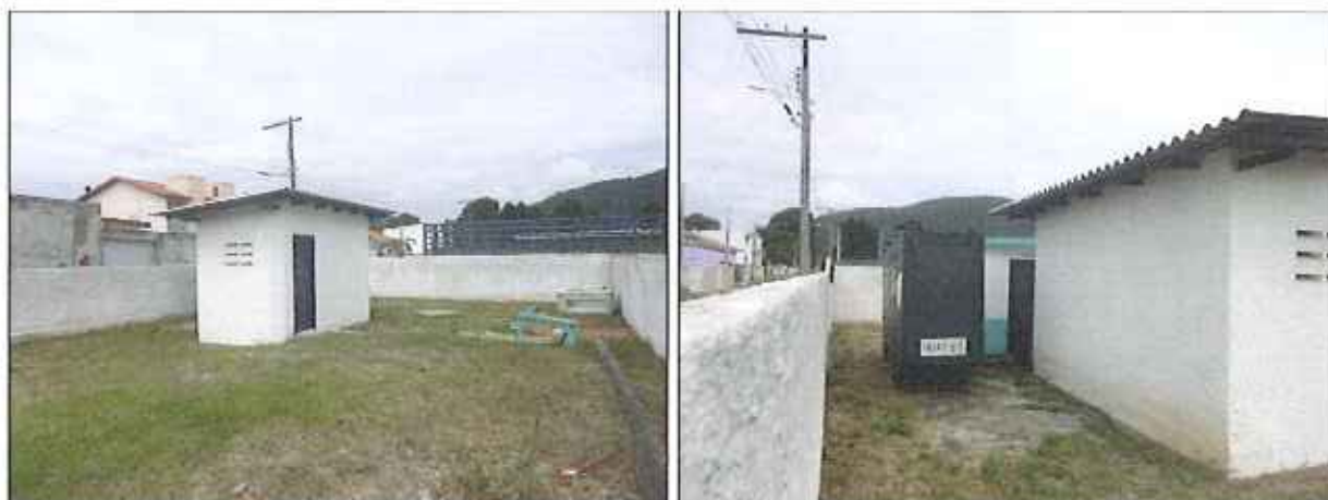
Figura 45: Gerador no Poço Ciro
