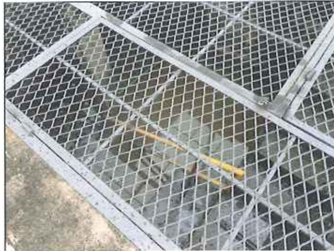
Figura 58: Gradeamento entupido EEE Sacolão
