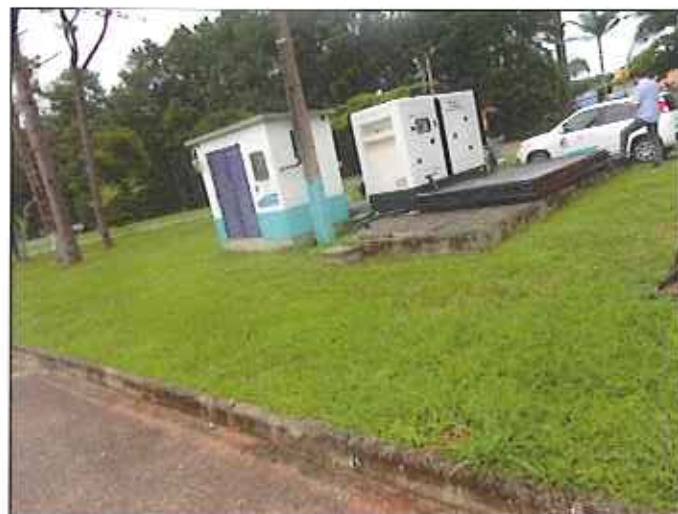
Figura 9: Geradores EEE Bombeiros – Barra da Lagoa
