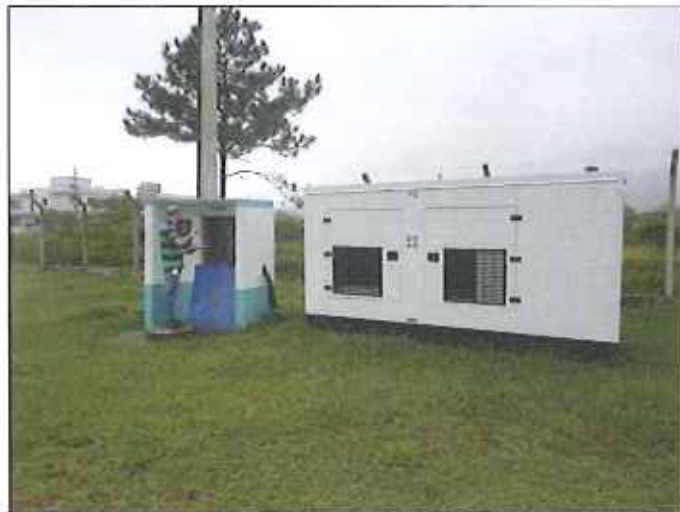
Figura 48: Gerador no Poço Emundo III
