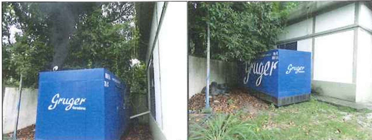
Figura 22: Geradores EEE Campinas
