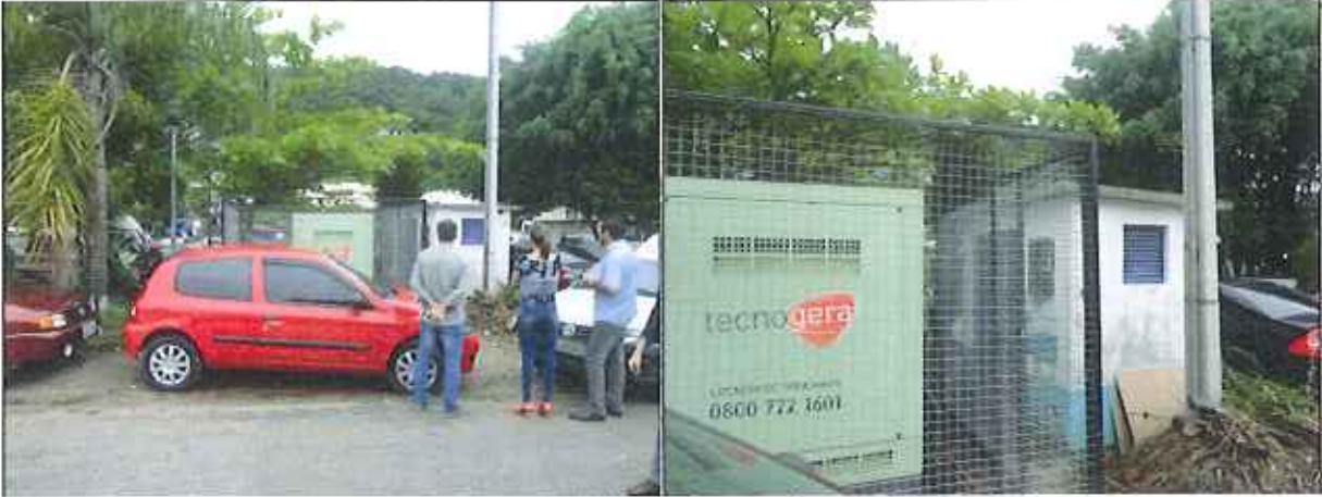
Figura 10: Geradores EEE Vila dos Pescadores – Barra da Lagoa
