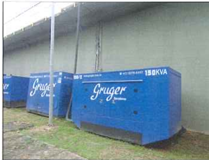
Figura 13: Geradores ETE Insular
