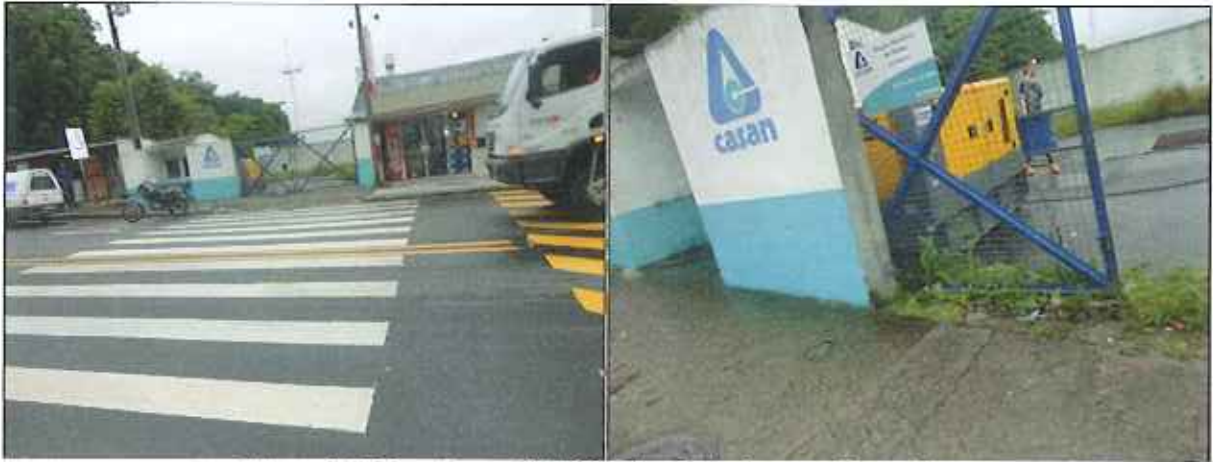
Figura 25: Geradores EEE Condomínio Argus - Coqueiros
