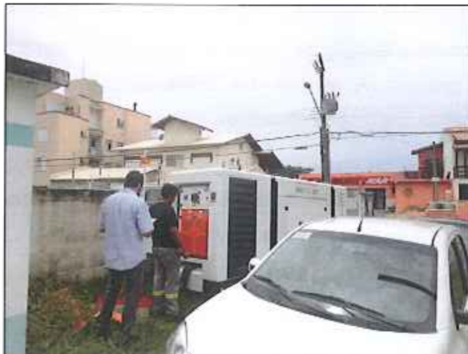
Figura 3: Geradores EEE Rua das Gaivotas - Ingleses
