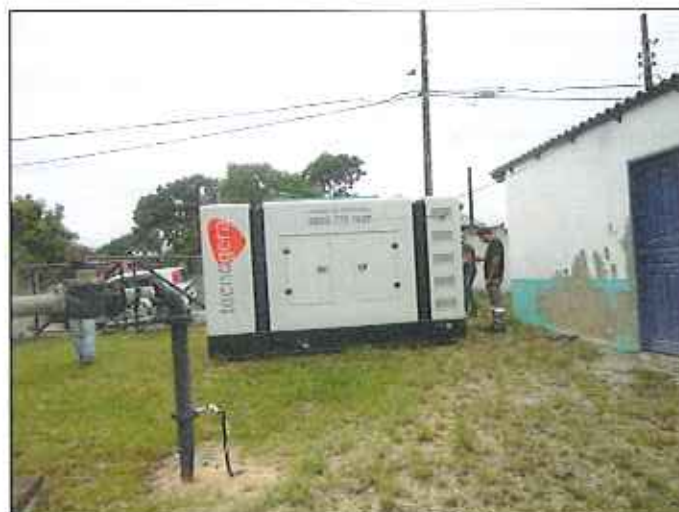
Figura 51: Gerador no Poço Moçambique
