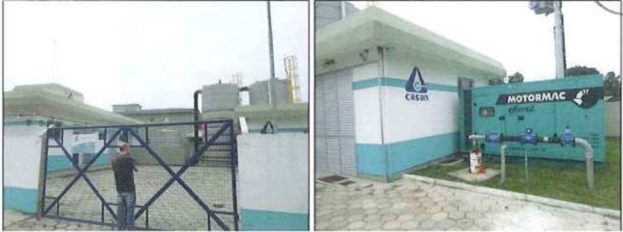
Figura 54: Gerador na ETA Campeche
