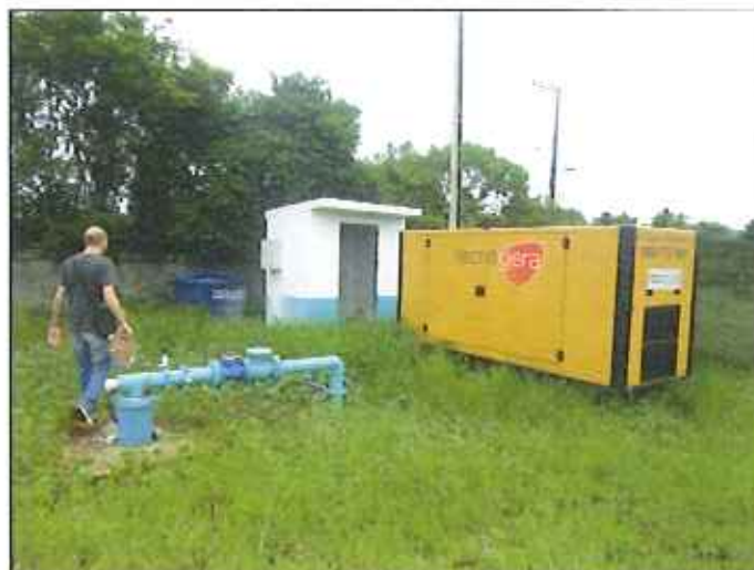
Figura 50: Gerador no Poço Moinho Rio Vermelho
