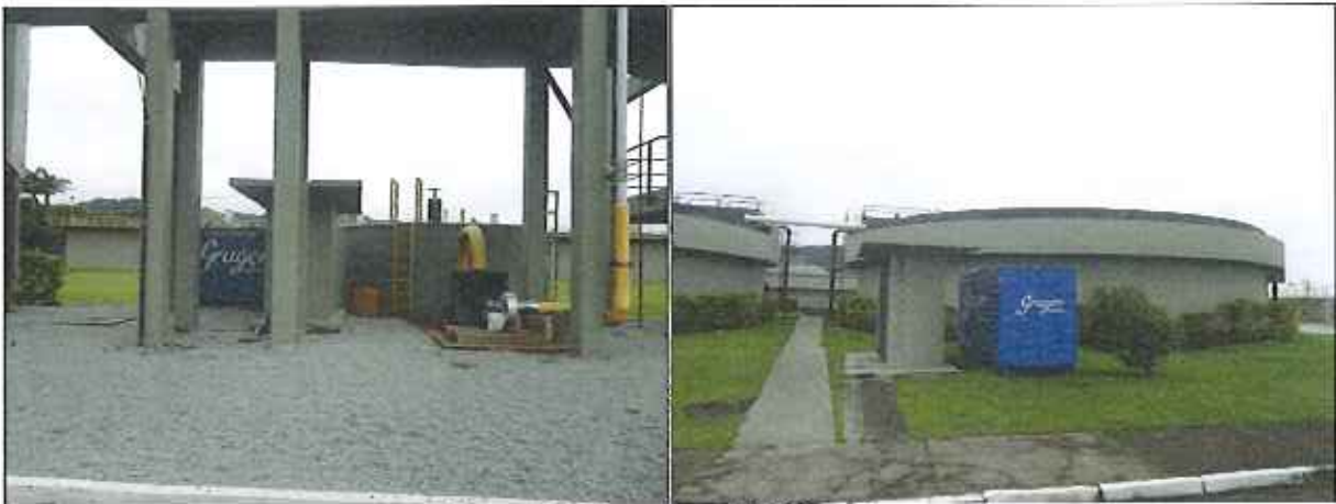
Figura 11: Geradores ETE Insular
