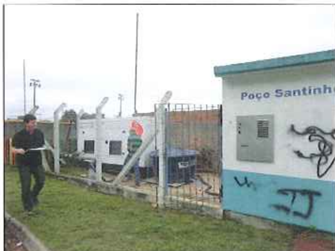
Figura 29: Gerador no Poço Santinho
