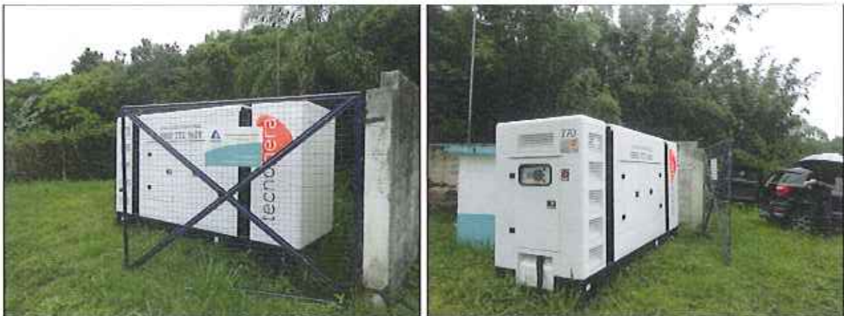
Figura 36: Gerador no Poço Ipanema
