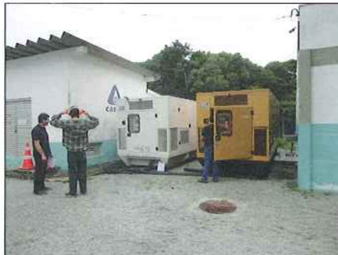
Figura 28: Geradores ETA Ingleses
