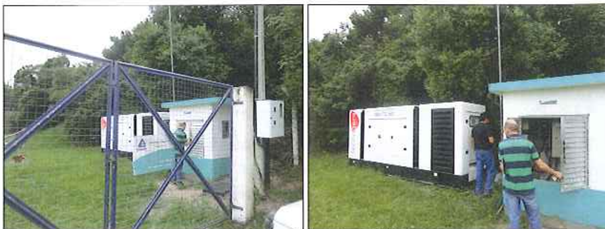
Figura 31: Gerador no Poço Oficina
