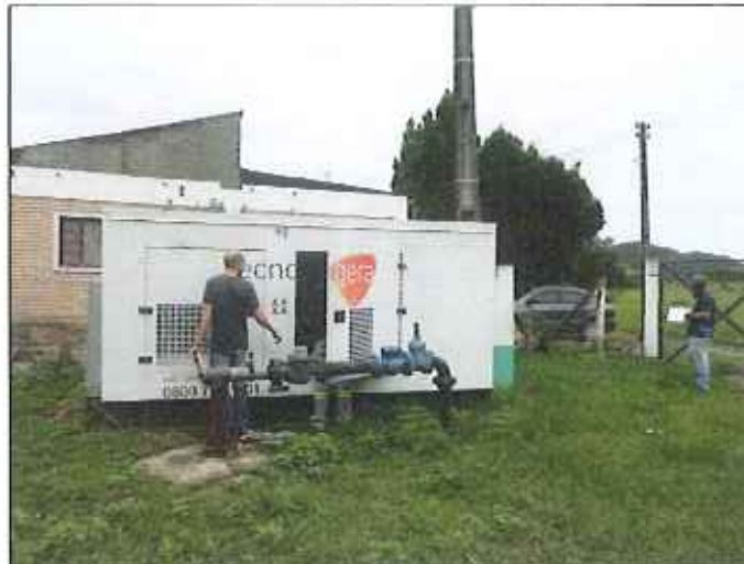
Figura 35: Gerador no Poço Palmeiras
