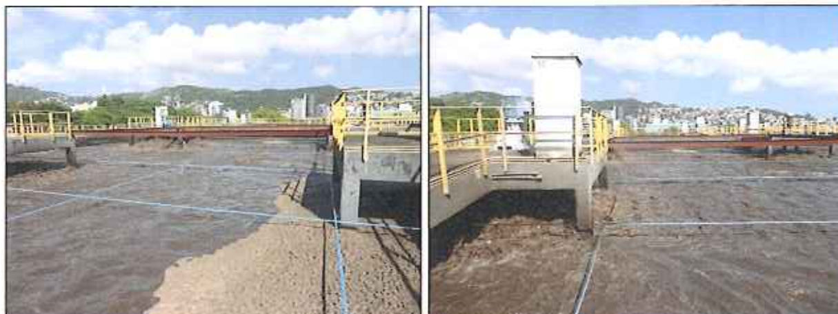
Figura 57: Aerador ETE Insular
