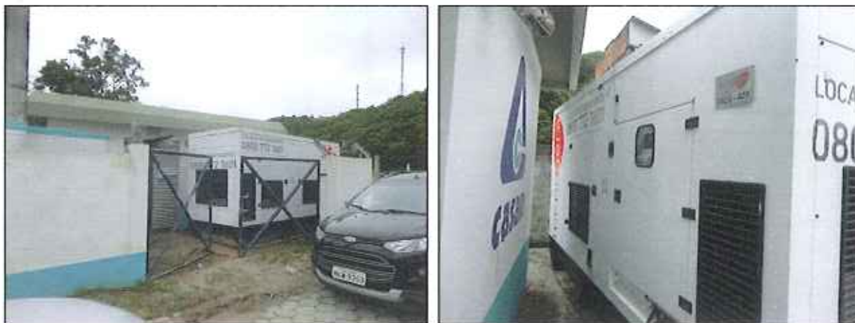
Figura 52: Gerador no Booster Três Marias
