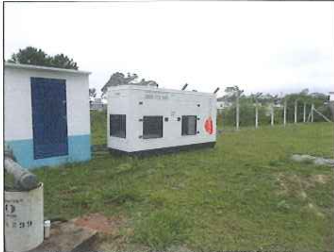
Figura 47: Gerador no Poço Edmundo II
