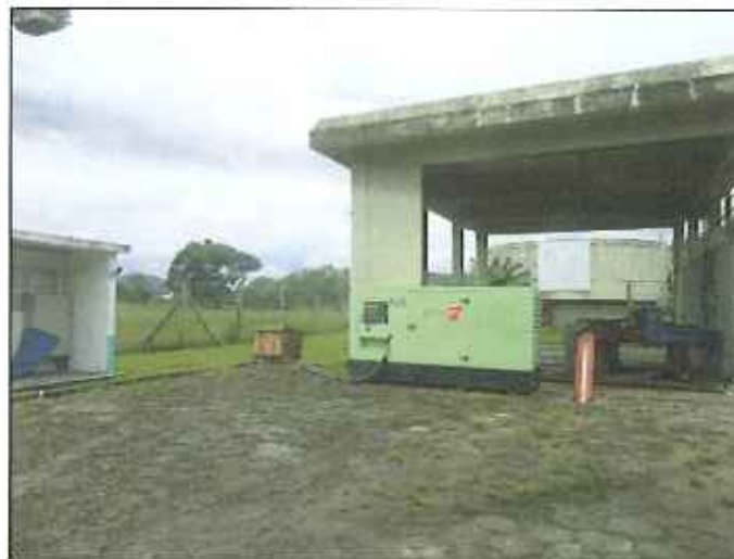
Figura 2: Geradores EEE ETE Ingleses
