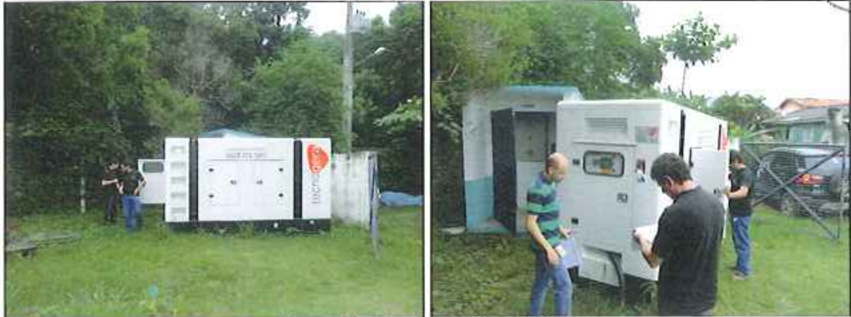
Figura 32: Gerador no Poço Didi 3
