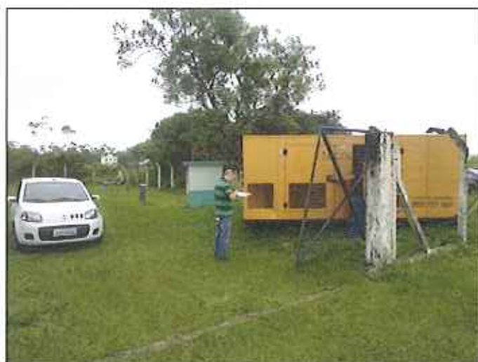
Figura 46: Gerador no Poço Edmundo I
