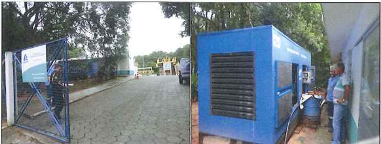
Figura 8: Geradores ETE Barra da Lagoa
