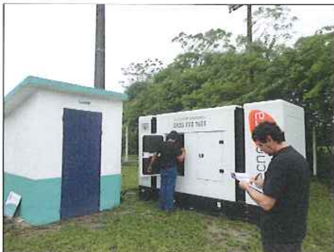
Figura 43: Gerador no Poço Paulinho da Matriz IV
