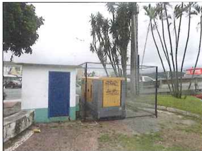
Figura 21: Geradores EEE Ponte da Lagoa – Lagoa da Conceição
