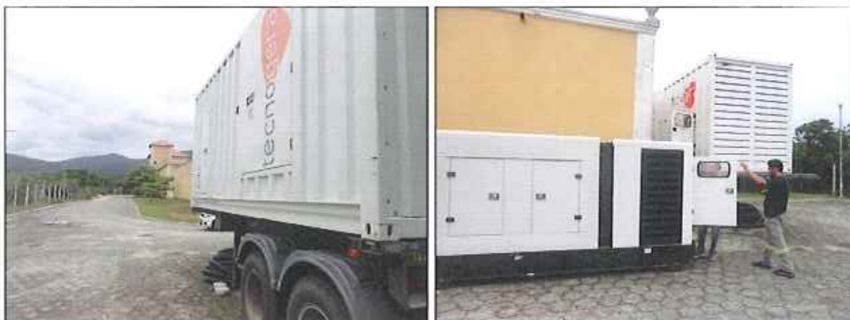
Figura 53: Geradores na ETA Lagoa do Peri
