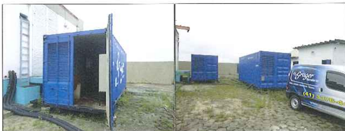
Figura 23: Geradores EEE GB Barreiros
