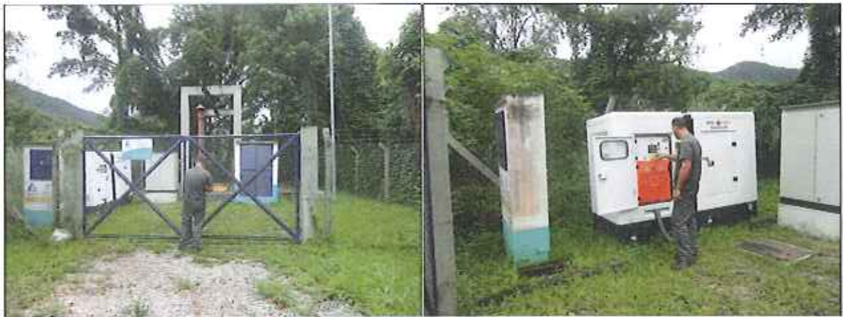
Figura 20: Geradores EEE Condomínio Saulo Ramos - Canto da Lagoa
