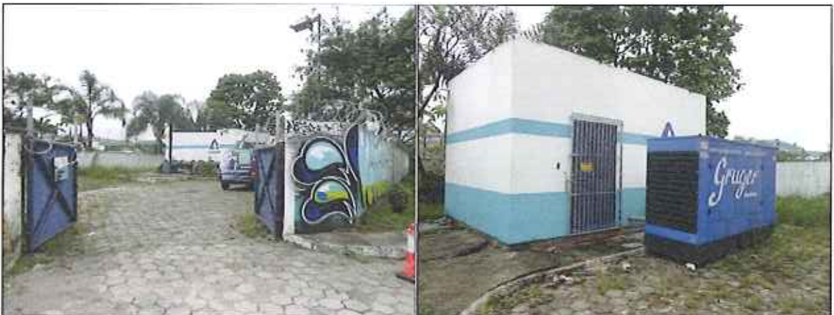
Figura 15: Geradores EEE BC Sacolão
