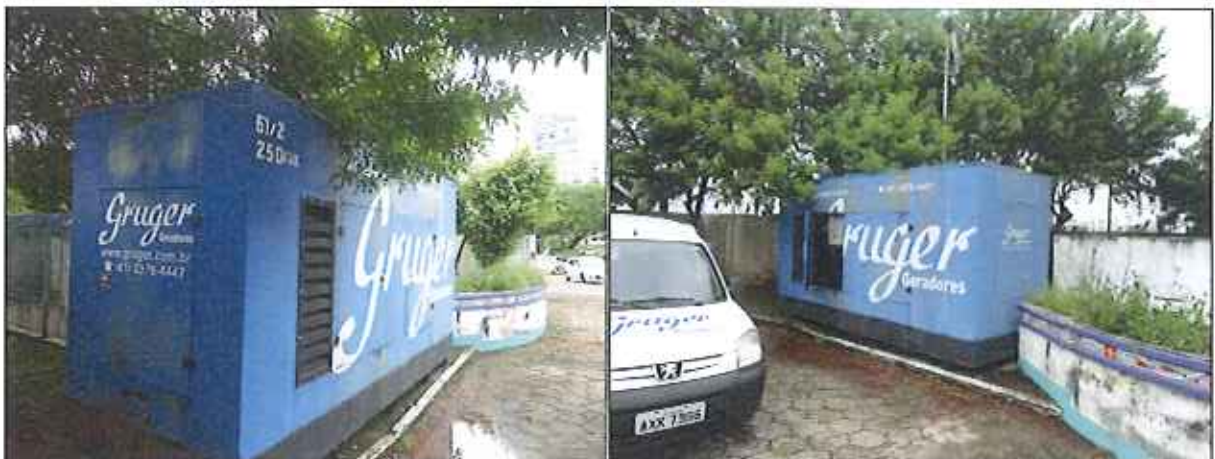
Figura 14: Geradores EEE Beira Mar
