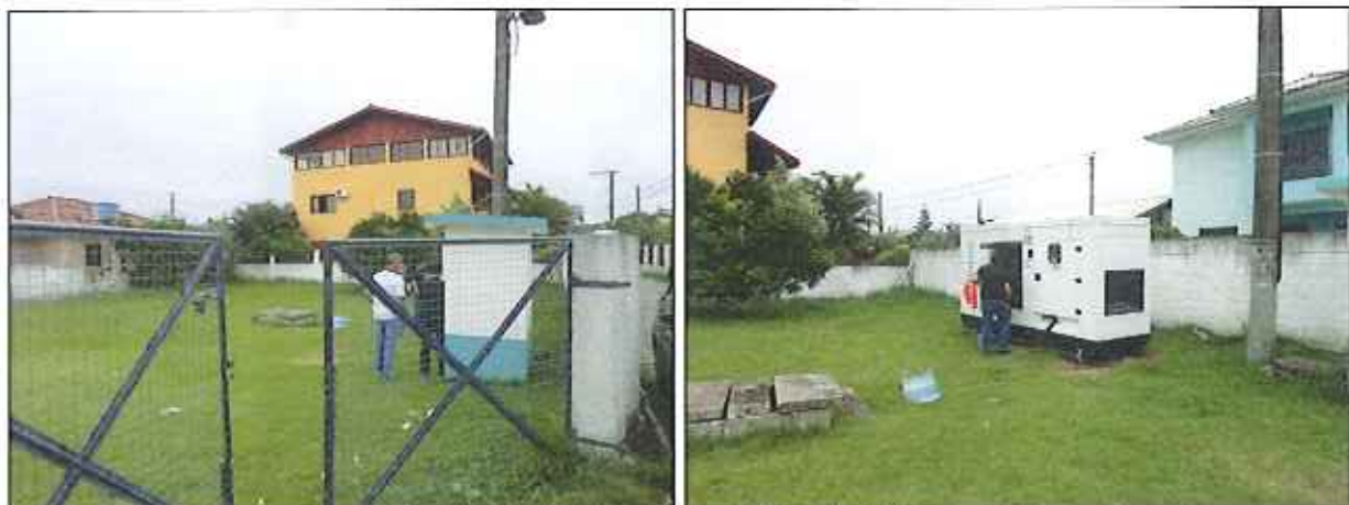
Figura 34: Gerador no Poço Didi 1
