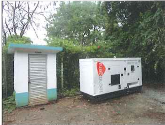
Figura 38: Gerador no Poço RBS
