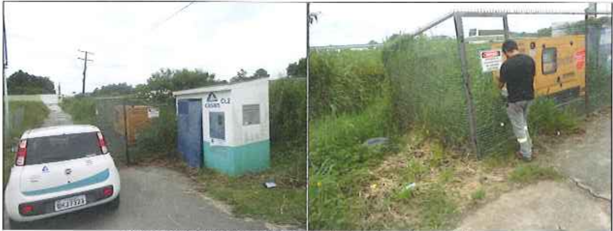
Figura 7: Geradores EEE Canto do Lamim – Canasvieiras
