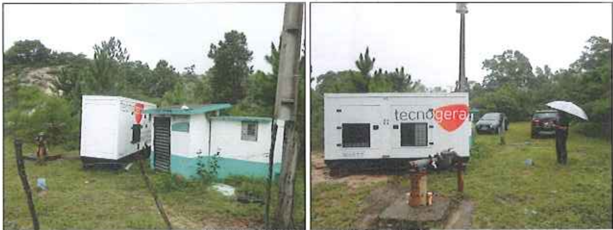
Figura 39: Gerador no Poço Bianco
