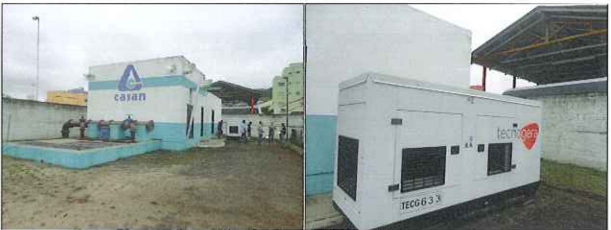
Figura 17: Geradores EEE A1 – Trindade
