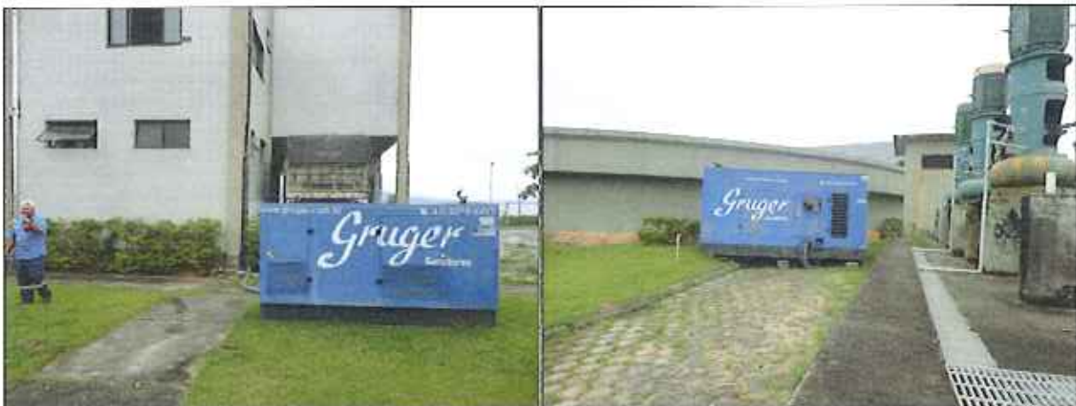
Figura 12: Geradores ETE Insular
