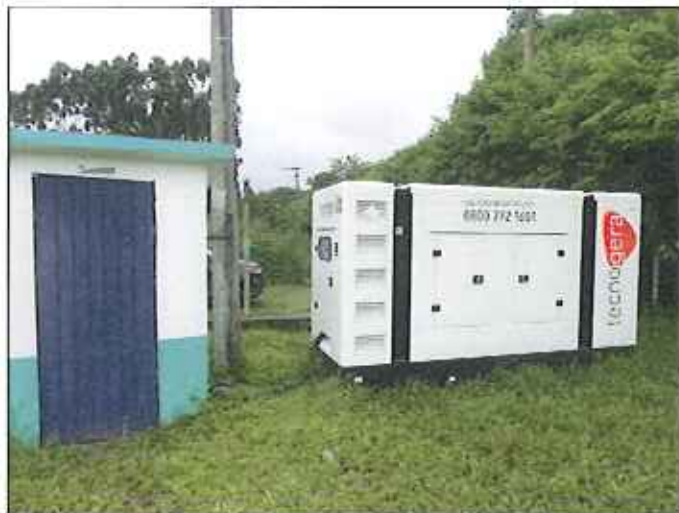
Figura 42: Gerador no Poço Paulinho da Matriz III
