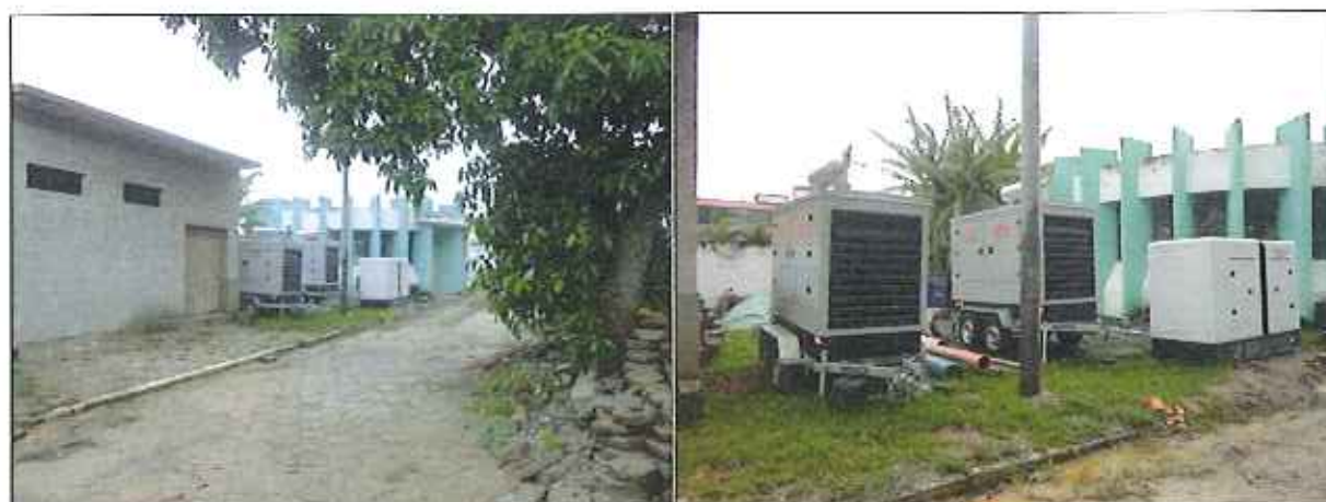
Figura 24: Geradores EEE Ponta do Leal
