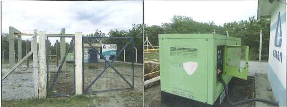
Figura 4: Geradores EEE 01 Cachoeira
