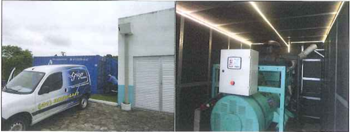
Figura 1: Geradores ETE Canasvieiras
