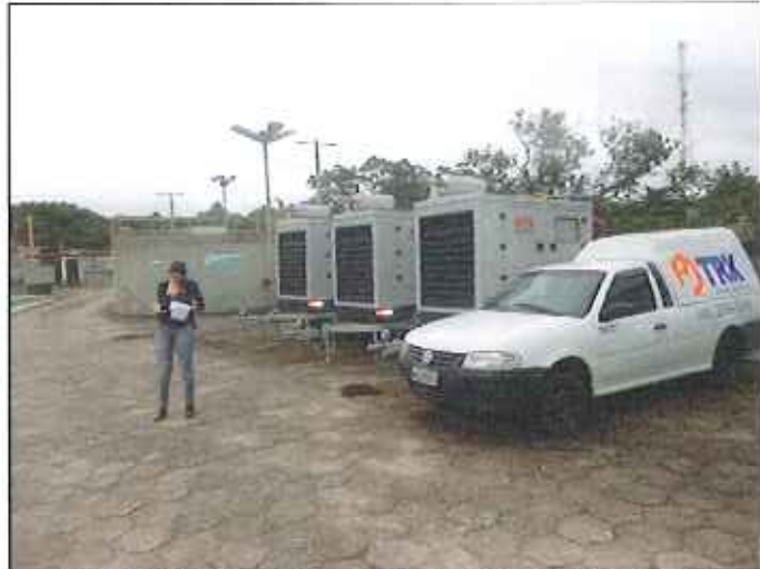
Figura 19: Geradores ETE Lagoa da Conceição
