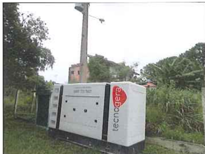
Figura 49: Gerador no Poço Areial
