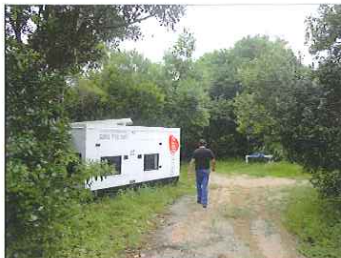
Figura 37: Gerador no Poço Costão Golf
