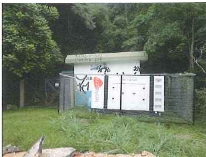
Figura 56: Gerador no Booster Canto da Lagoa
