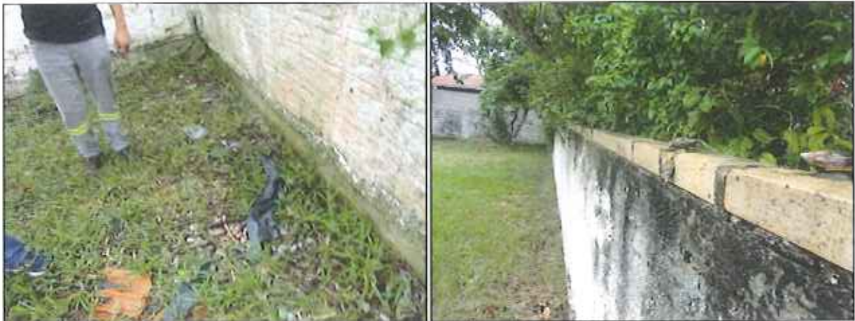
Figura 67: Falta de manutenção e limpeza em alguns poços
