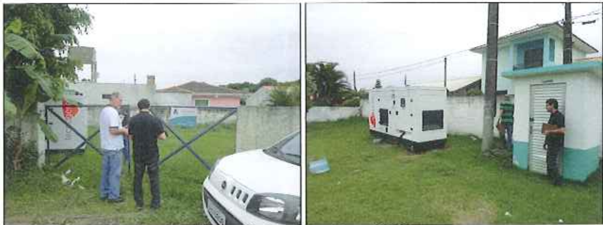
Figura 33: Gerador no Poço Didi 2
