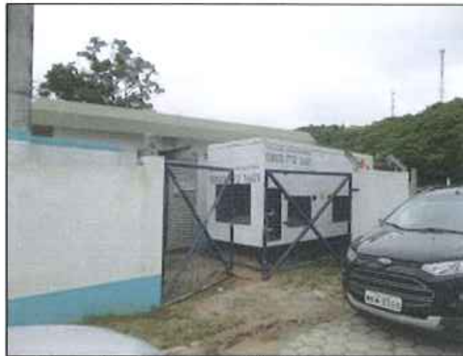
Figura 65: Portão com dificuldade de abertura
