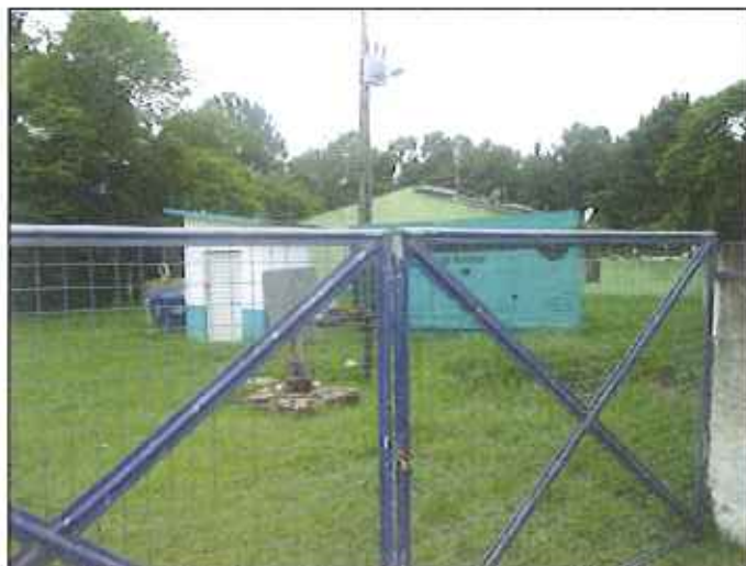
Figura 44: Gerador no Poço Dunas Verdes
