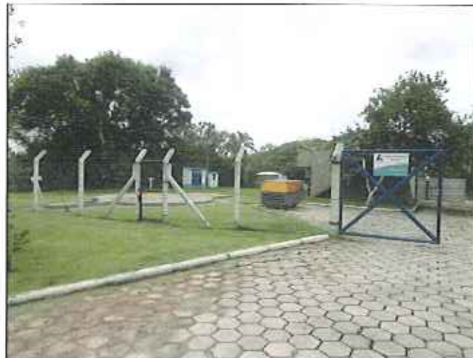
Figura 27: Geradores ETE João Paulo
