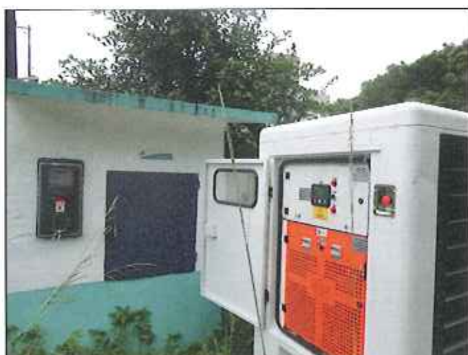
Figura 30: Gerador no Poço Idalino
