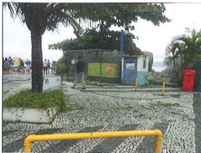
Figura 26: Geradores EEE Bar da Pedra - Coqueiros
