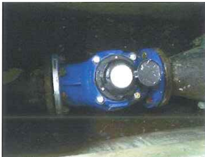
Figura 15: Macromedidor de água tratada
