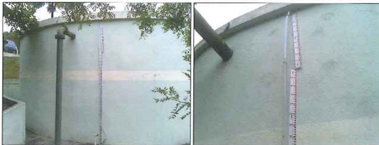
Figura 30: Medidor de nível inadequado
