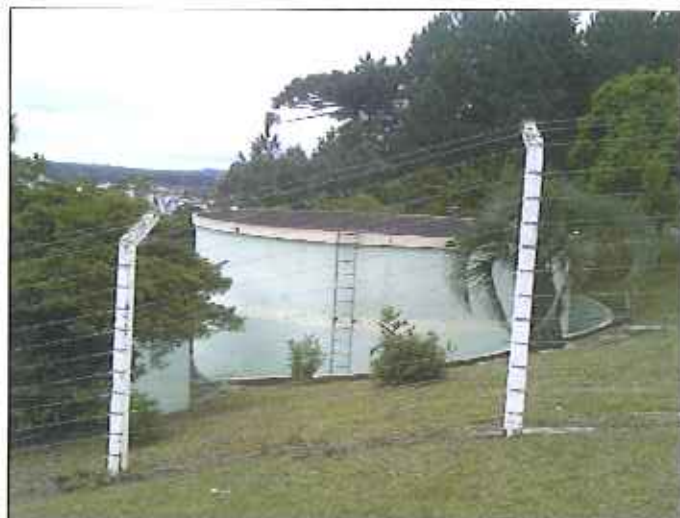
Figura 27: Reservatório da ETA
