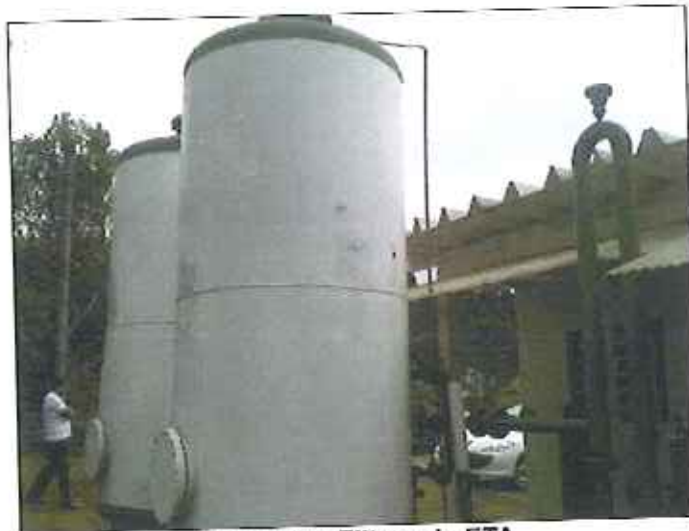
Figura 17: Filtros da ETA
