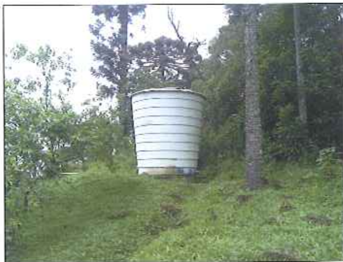
Figura 42: Reservatório São Miguel
