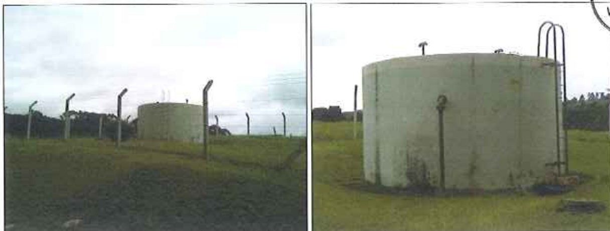
Figura 32: Reservatório Vila Cedro
