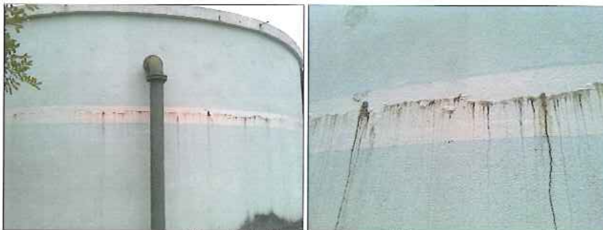
Figura 31: Infiltrações no reservatório
