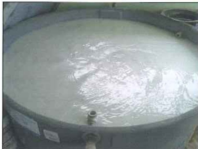
Figura 24: Tanque de cloro
