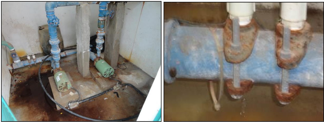
Figura 14: Bombas com vazamentos.
