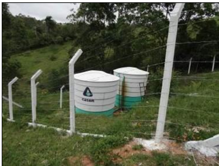
Figura 8: Reservatórios de 20m 3 cada.
