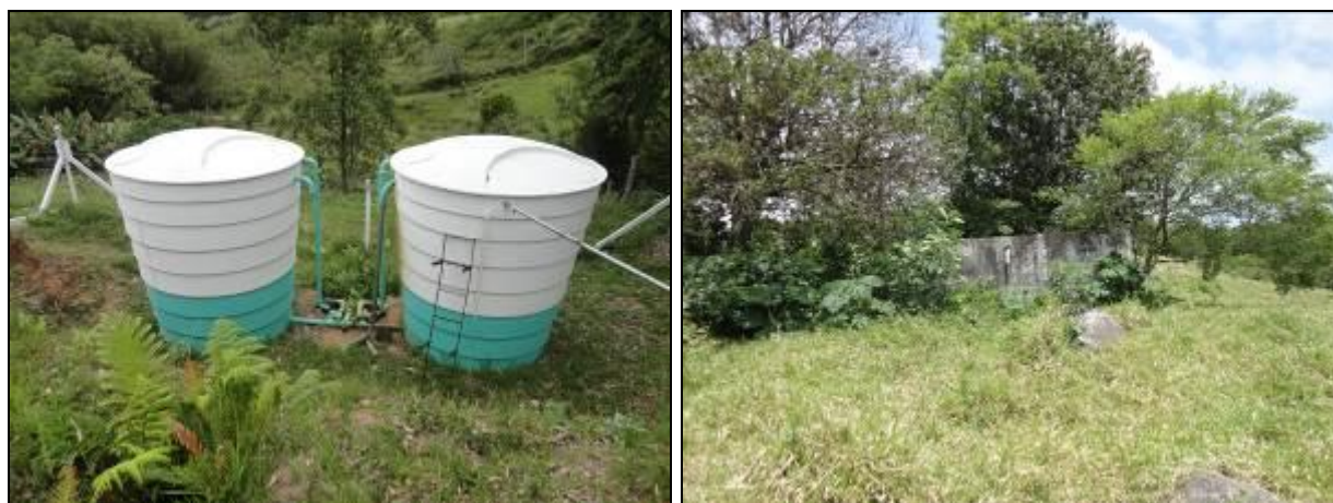
Figura 11: Entorno dos Reservatórios.
