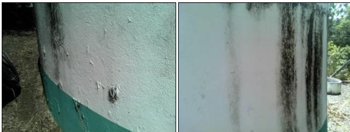
Figura 26: Vazamentos / infiltrações R1
