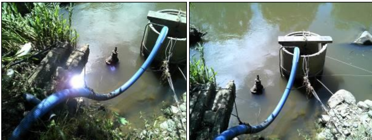
Figura 9: Bomba de recalque da água bruta
