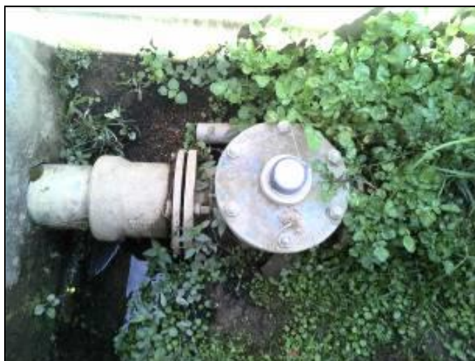
Figura 15: Macromedidor de saída de água tratada
