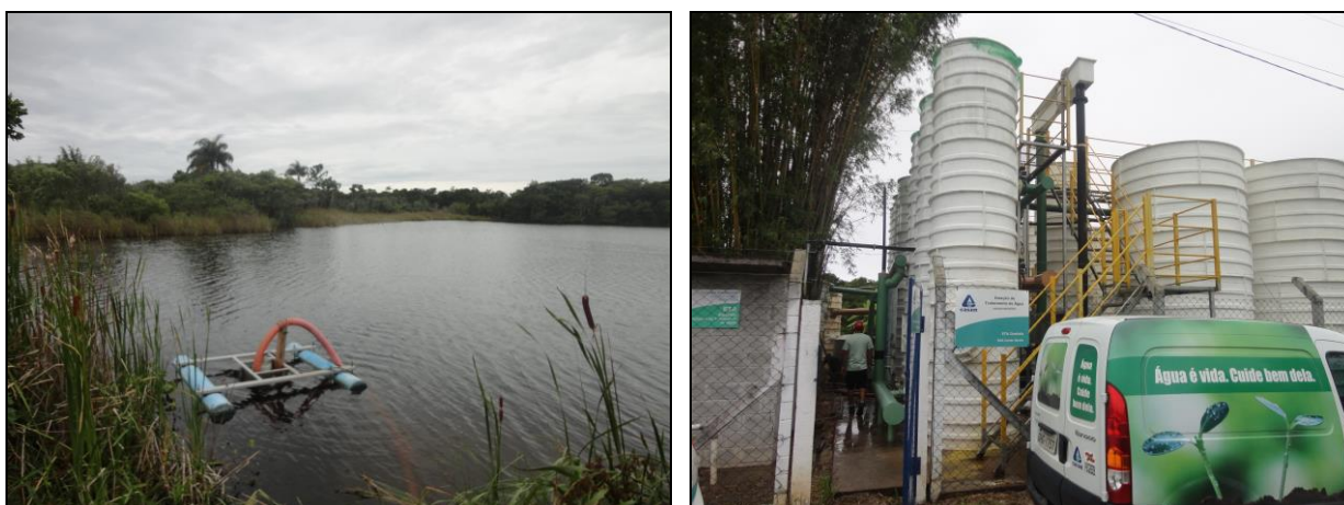
Figura 1: Captação da água bruta que segue para ETA Compacta da Daniela
