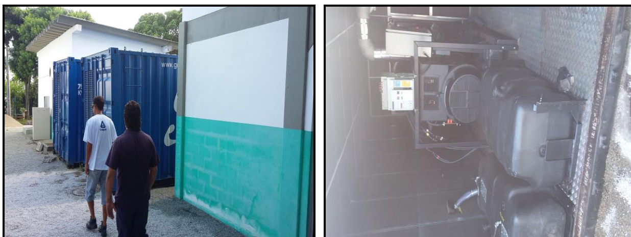
Figura 9: Grupos geradores de energia elétrica na ETA Ingleses (11/02/2015)
