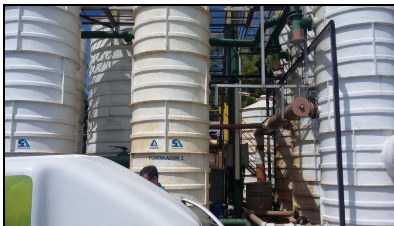
Figura 29: Captação e ETA Compacta Ratores (11/02/2015)
