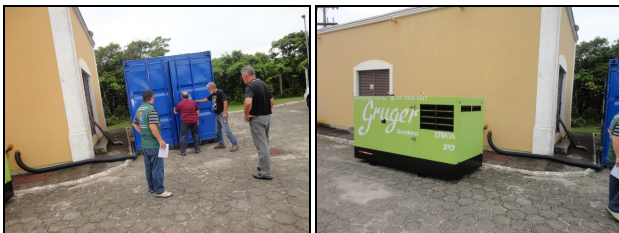
Figura 34: ETA Lagoa do Peri com gerador (13/02/2015)
