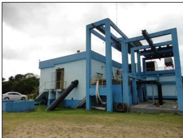
Figura 1: Estação de Recalque de Água Bruta
