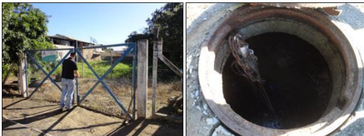
Figura 157: EEE Caminho do Mar (Acompanhamento set2013)
