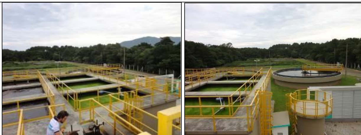
Figura 81: Lagoa de estabilização (à esquerda) e decantador (à direita) (Acompanhamento set2013)
