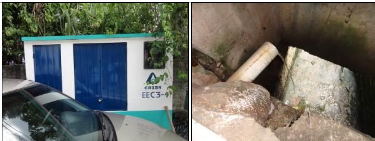
Figura 242: Casa de comando (à esquerda) e lançamento do esgoto no córrego ao lado da Estação (Acompanhamento fev2014)
