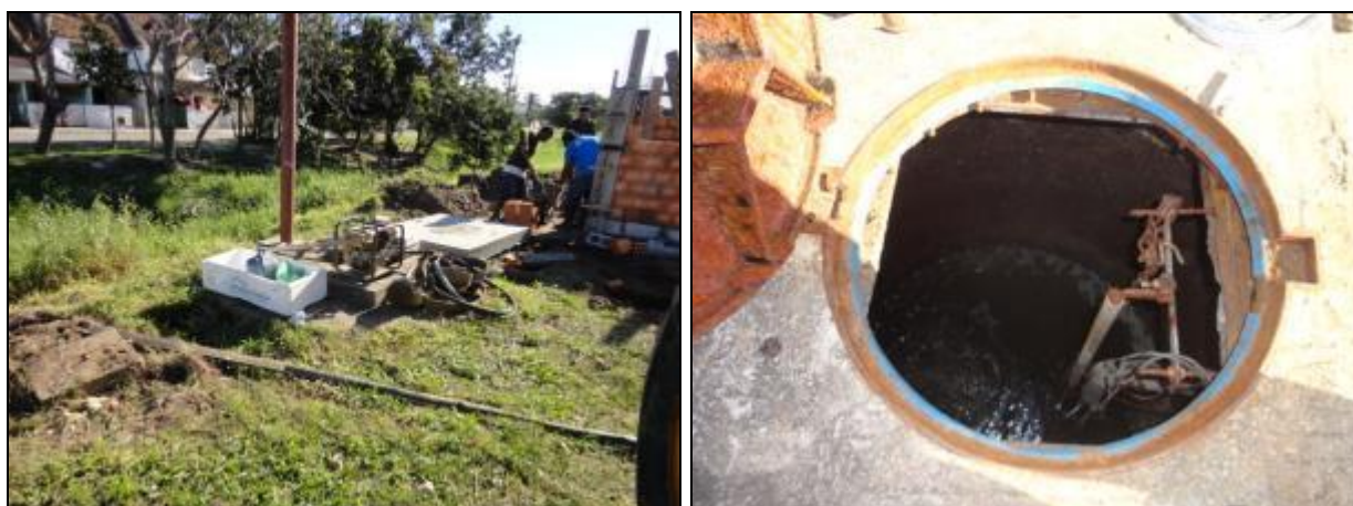
Figura 160: ETE Vila União (Acompanhamento set2013)
