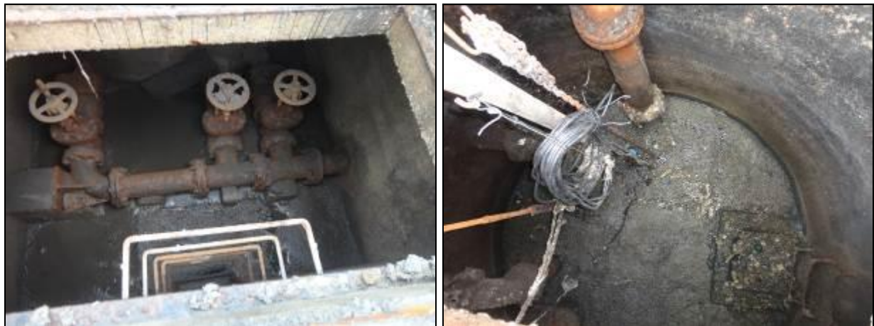
Figura 168: Poço úmido com muito lodo sobrenadante (Acompanhamento fev2014)
