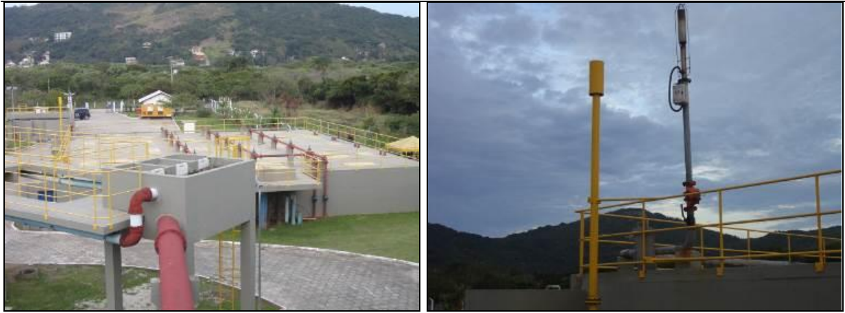
Figura 68: Reator UASB (à esquerda) e queimador de biogás (à direita) (Acompanhamento set2013)
