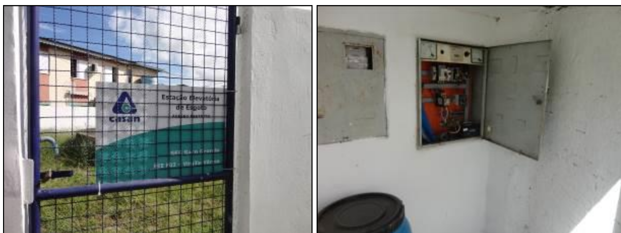
Figura 293: Vista da EEE (à esquerda) e interior da casa de comando (à direita) (Acompanhamento fev2014)
