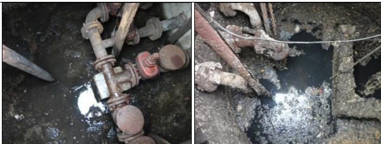
Figura 178: Poço úmido com muita sujeira (Acompanhamento fev2014)
