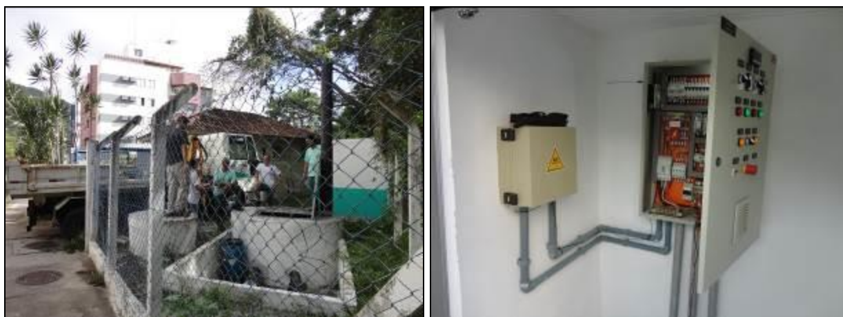
Figura 234: Vista geral da EEE e casa de comando (Acompanhamento fev2014)
