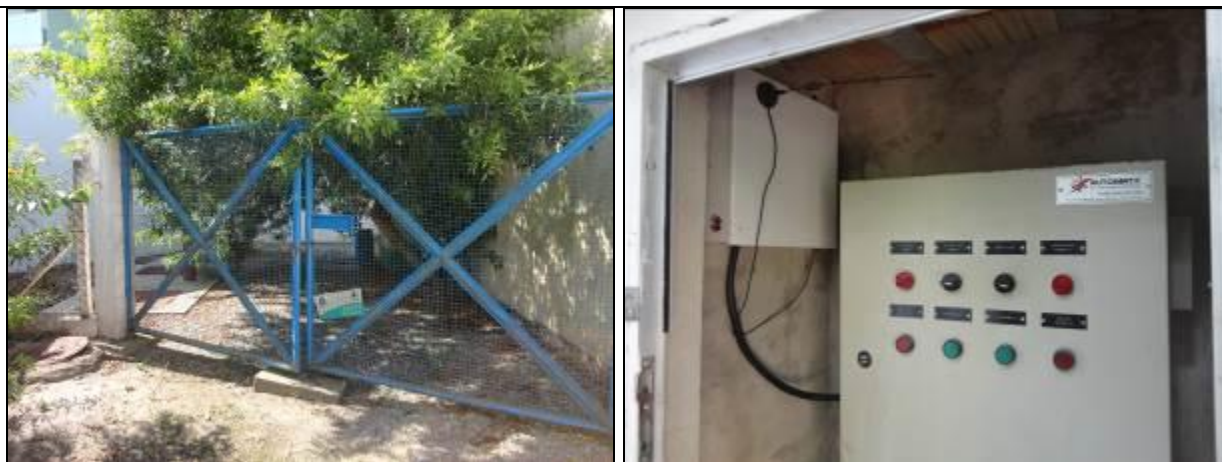
Figura 127: Vista geral da EEE (à esquerda) e quadro de comando (à direita) (Acompanhamento fev2014)
