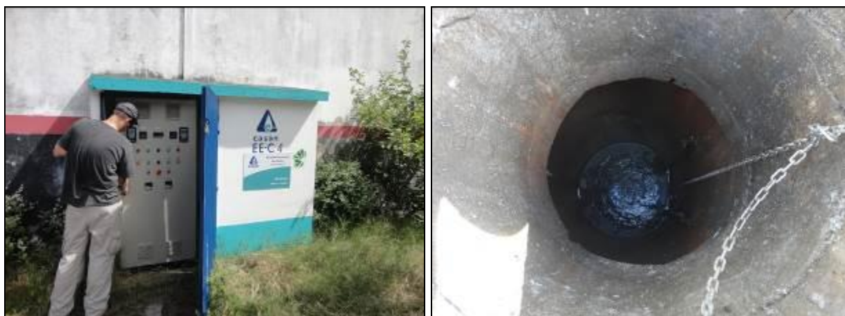
Figura 248: Casa de comando (à esquerda) e gradeamento (à direita) (Acompanhamento fev2014)
