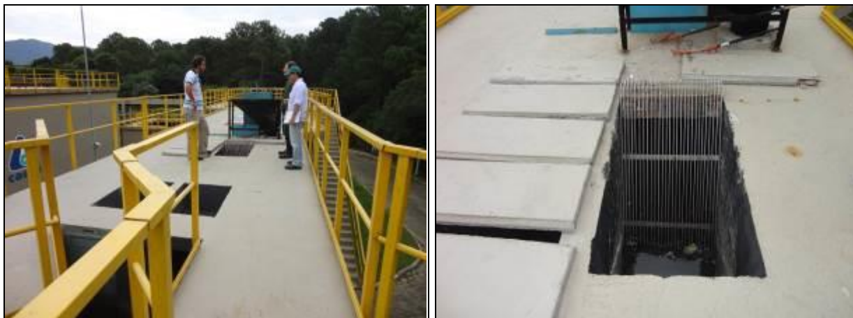
Figura 85: Área de entrada do efluente bruto e gradeamento (Acompanhamento set2013)
