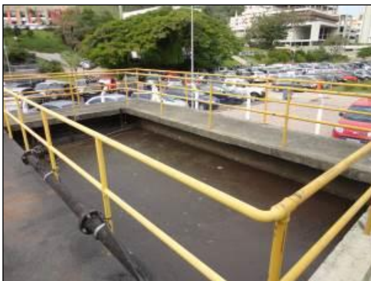
Figura 36: Área do tratamento de efluentes (Acompanhamento set2013)
