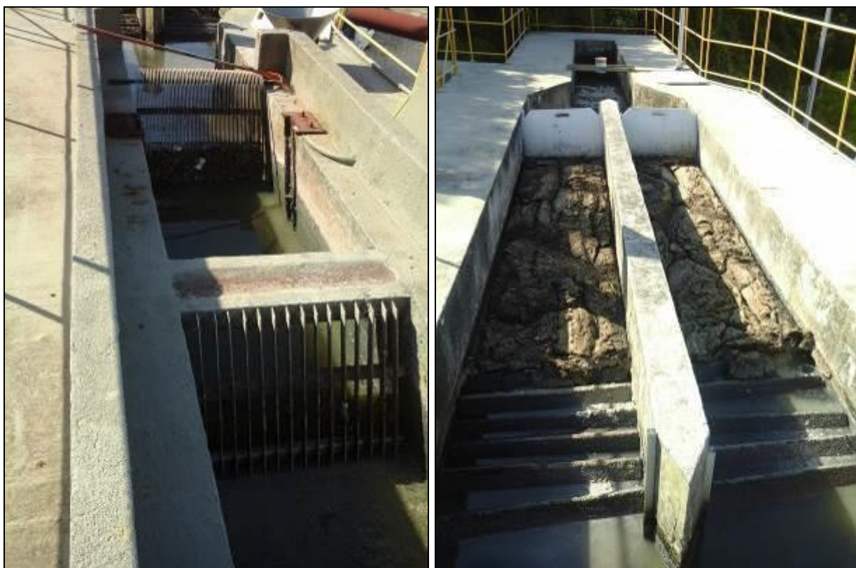
Figura 76: Gradeamento (à esquerda) e caixa de gordura (à direita) (Acompanhamento fev2014)
