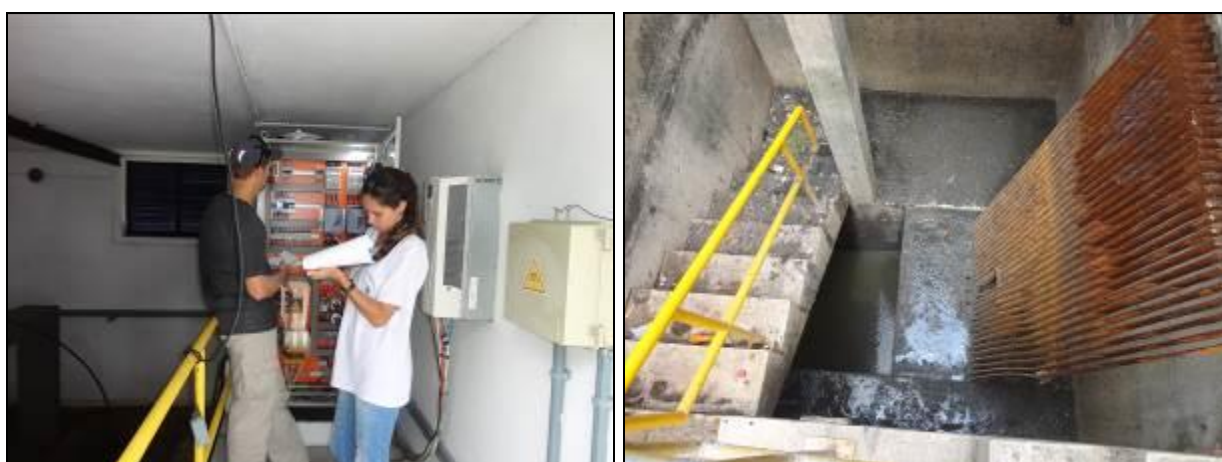
Figura 203: Interior da casa de comando (à esquerda) e gradeamento (à direita) (Acompanhamento fev2014)
