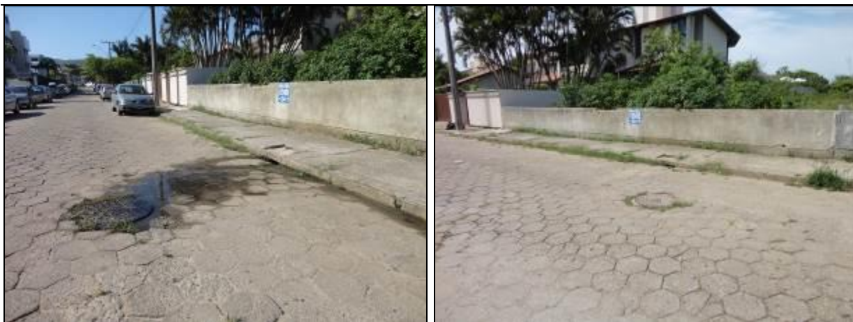
Figura 63: Poço de visita com vazamento (à esquerda) e poço de visita recuperado (à direita)
