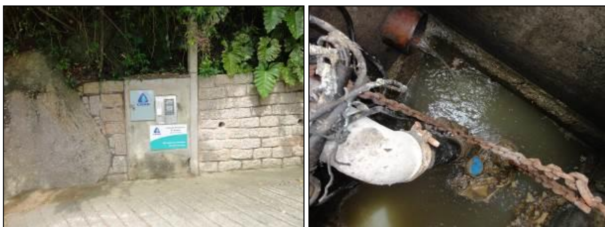
Figura 269: EEE Retiro da Lagoa (Acompanhamento fev2014)
