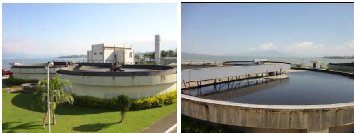
Figura 2: Decantadores (Acompanhamento set2013 à esquerda e fev2014 à direita)
