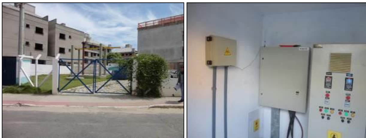
Figura 152: Vista geral da EEE (à esquerda) e casa de comando (à direita) (Acompanhamento fev2014)
