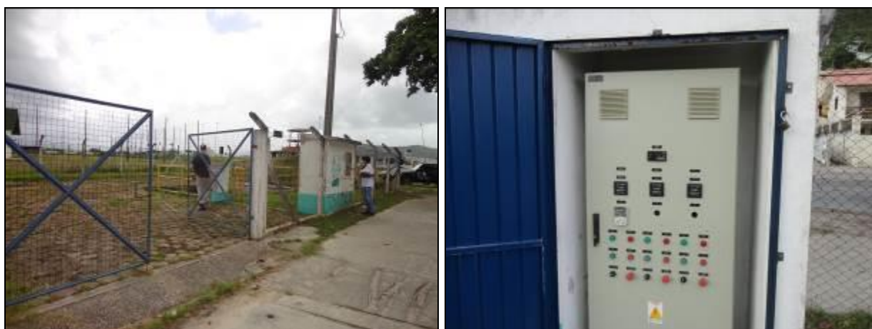
Figura 245: Vista geral da EEE e casa de comando (Acompanhamento fev2014)
