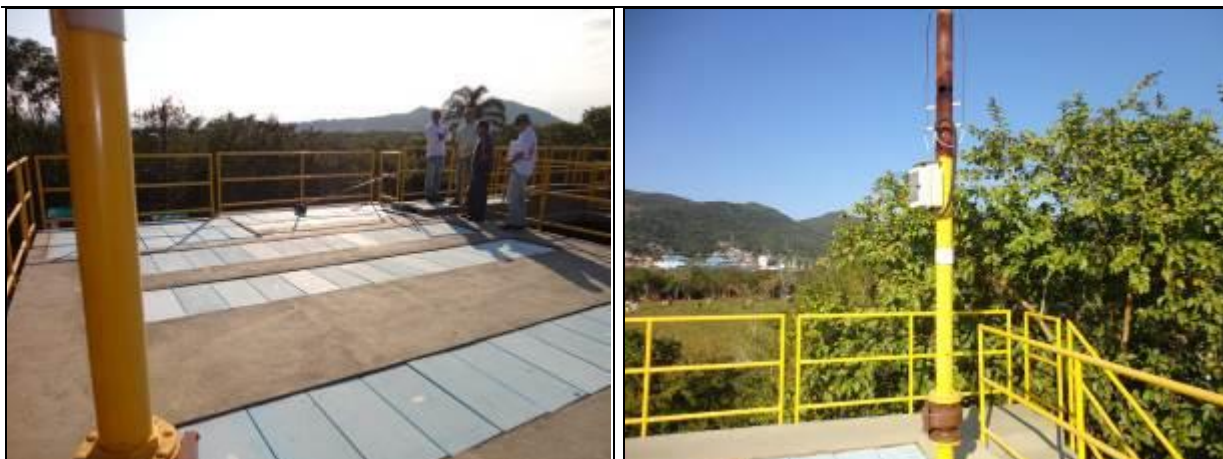
Figura 20: Reator UASB (à esquerda) e queimador de biogás (à direita) (Acompanhamento set2013)
