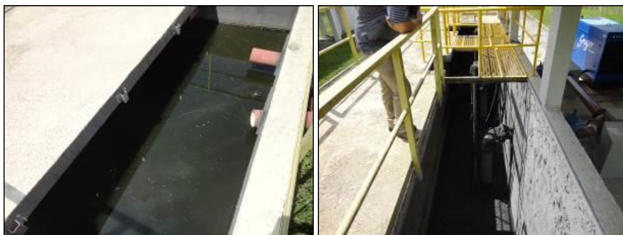
Figura 156: Poço úmido (Acompanhamento fev2014)
