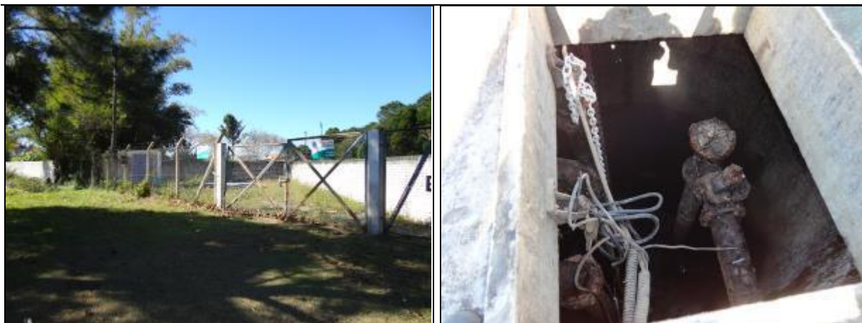
Figura 108: EEE BB Barra da Lagoa (Acompanhamento set2013)
