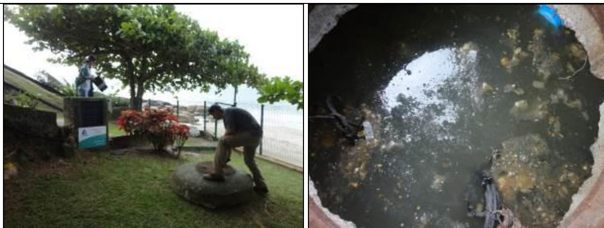
Figura 144: Vista geral da EEE (à esquerda) e poço úmido (à direita) (Acompanhamento fev2014)
