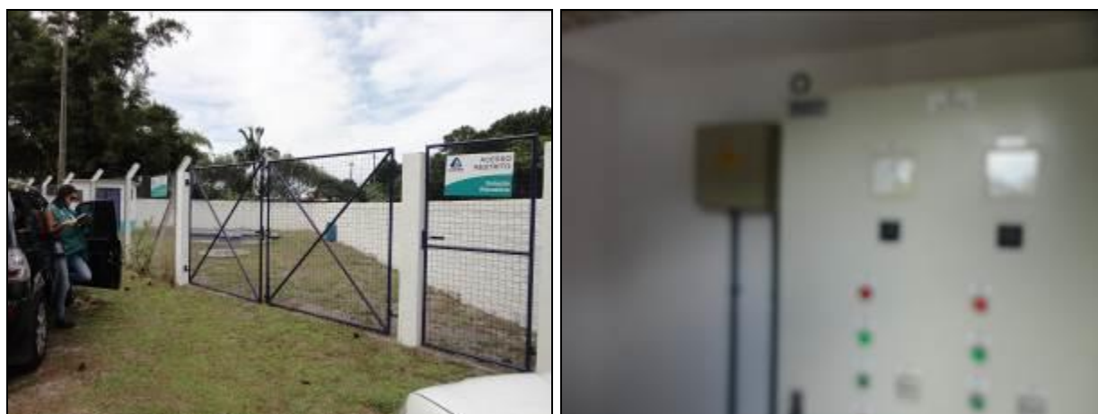
Figura 109: EEE BB Barra da Lagoa e interior da casa de comando (Acompanhamento fev2014)
