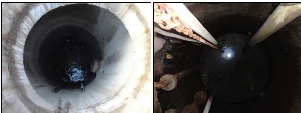
Figura 282: Poço de entrada de efluente bruto (à esquerda) e poço úmido (à direita) (Acompanhamento fev2014)
