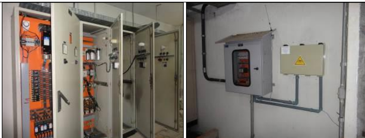
Figura 208: Quadros de comando (Acompanhamento fev2014)
