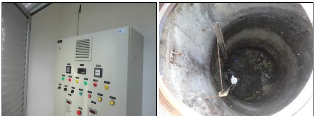
Figura 119: Casa de comando (à esquerda) e poço de entrada do efluente bruto com lodo sobrenadante (à direita) (Acompanhamento fev2014)
