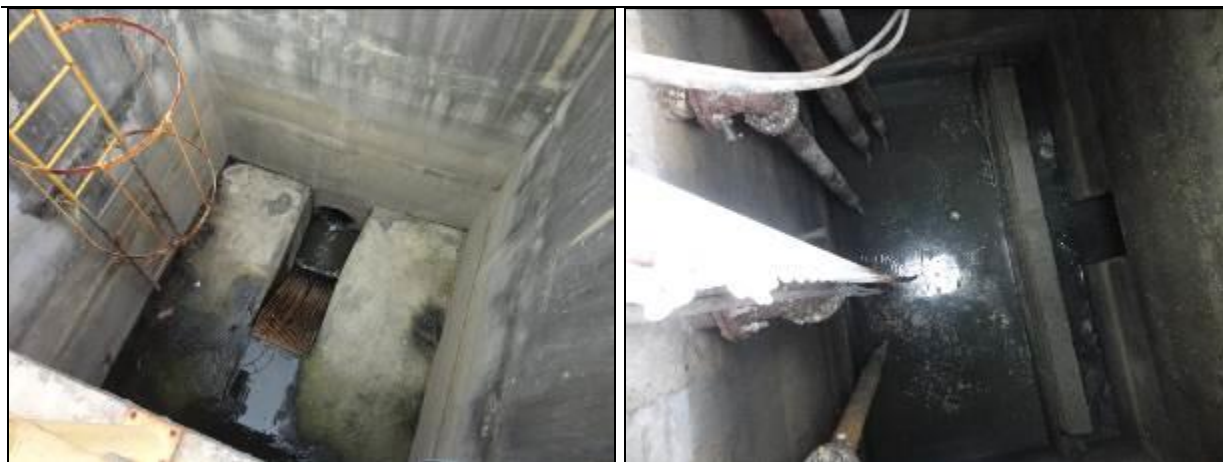
Figura 246: Gradeamento (à esquerda) e poço úmido (à direita) (Acompanhamento fev2014)
