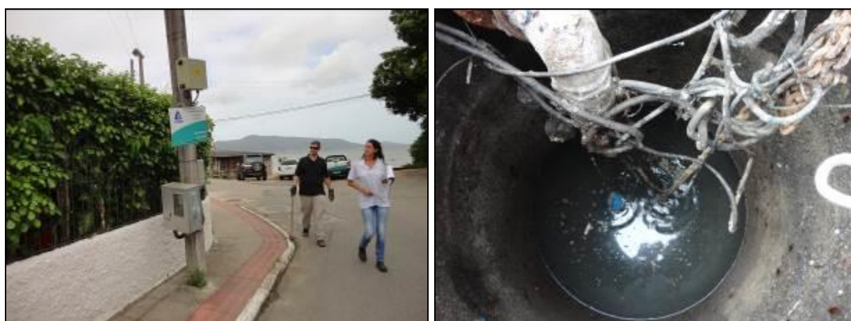
Figura 170: EEE Bento Goiás (Acompanhamento fev2014)
