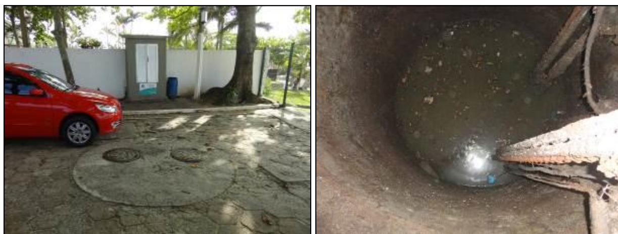
Figura 142: Vista geral da EEE (à esquerda) e poço úmido (à direita) (Acompanhamento fev2014)
