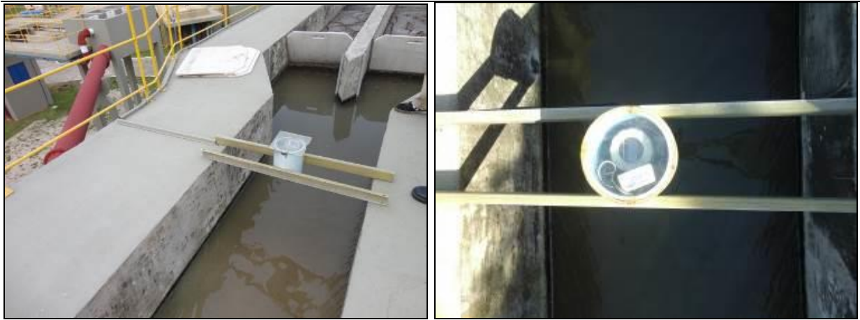
Figura 73: Medidor de vazão (Acompanhamento set2013 à esquerda e fev2014 à direita)
