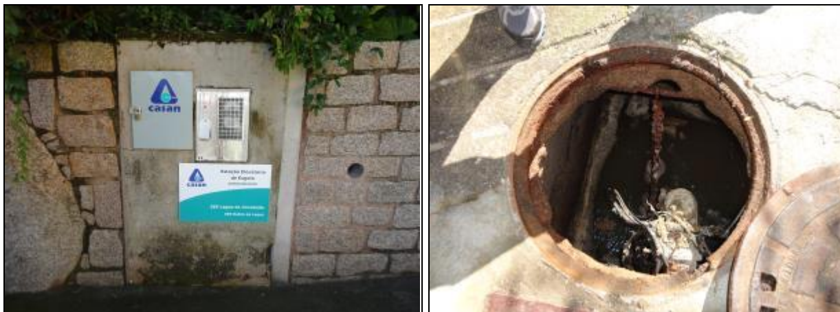
Figura 268: EEE Retiro da Lagoa (Acompanhamento set2013)
