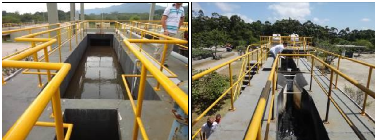
Figura 48: Entrada do efluente bruto (Acompanhamento set2013 à esquerda e fev2014 à direita)
