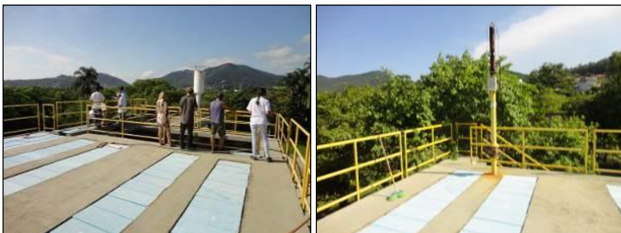
Figura 21: Reator UASB (à esquerda) e queimador de biogás (à direita) (Acompanhamento fev2014)
