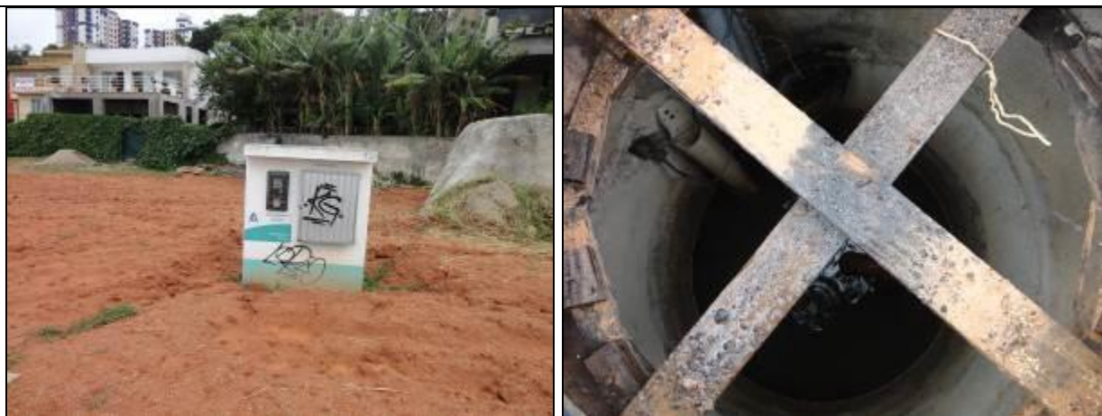
Figura 198: EEE continua inoperante (Acompanhamento fev2014)
