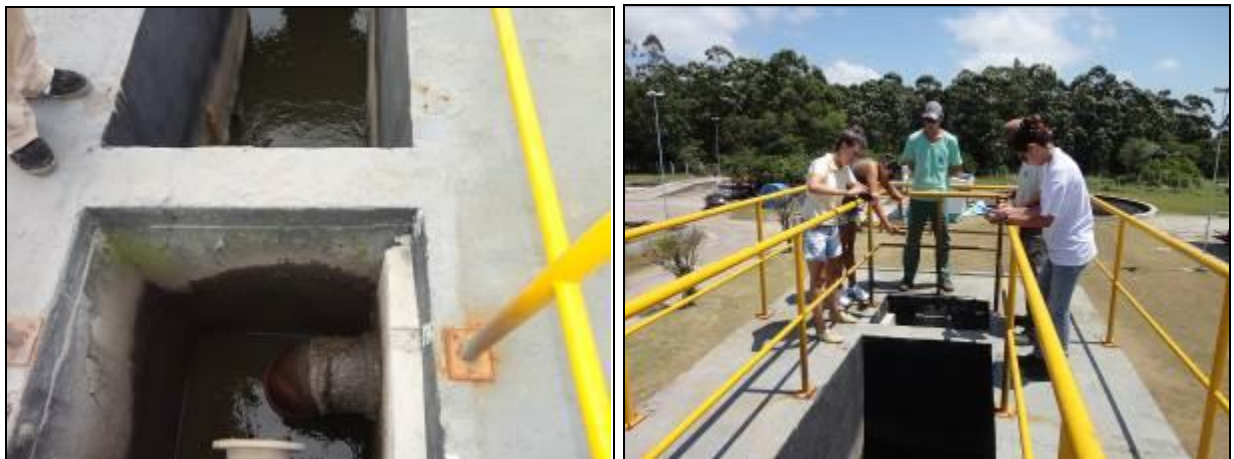
Figura 52: Entrada do efluente bruto (Acompanhamento set2013 à esquerda e fev2014 à direita)
