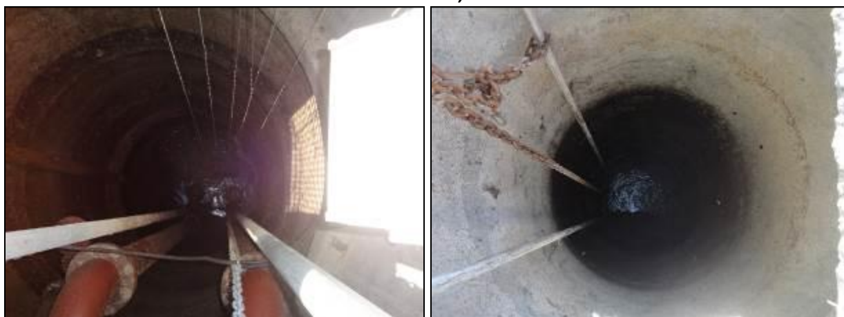
Figura 140: Poço úmido (à esquerda) e entrada do efluente bruto com gradeamento (à direita) (Acompanhamento fev2014)
