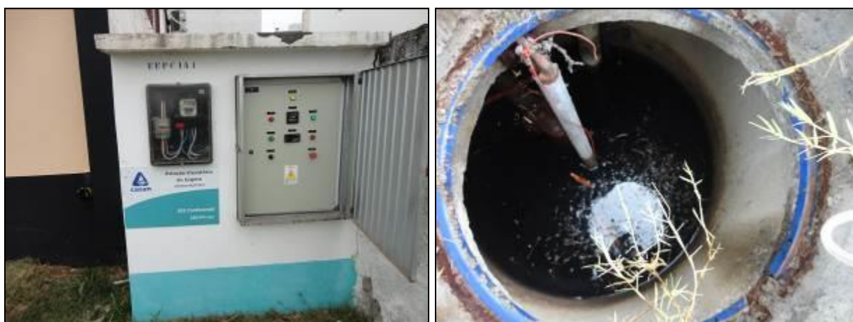
Figura 200: EEE continua inoperante (Acompanhamento fev2014)
