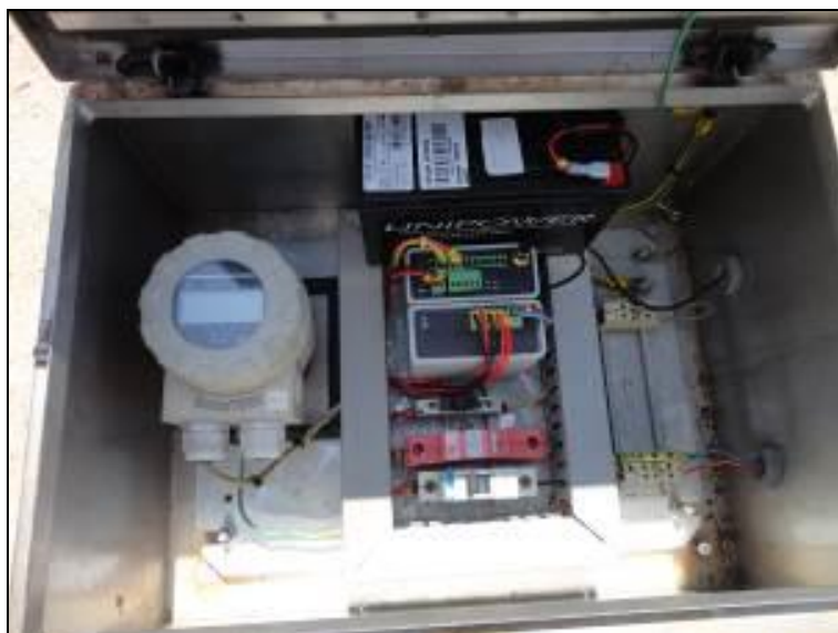
Figura 95: Medidor de vazão (Acompanhamento fev2014)
