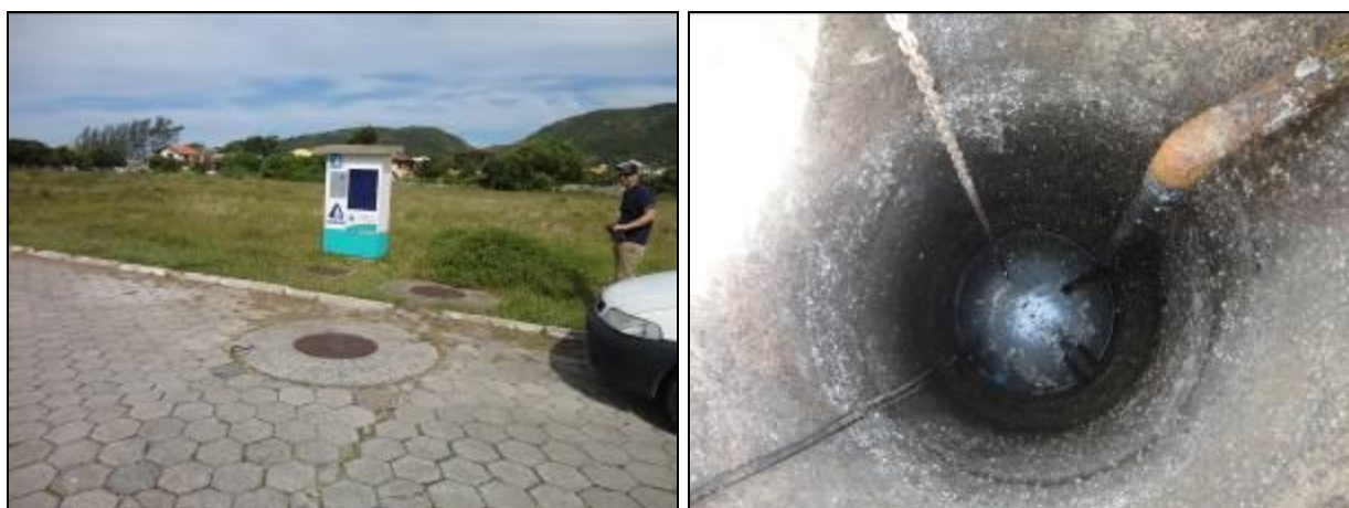
Figura 104: EEE BC Barra da Lagoa e poço úmido (Acompanhamento fev2014)
