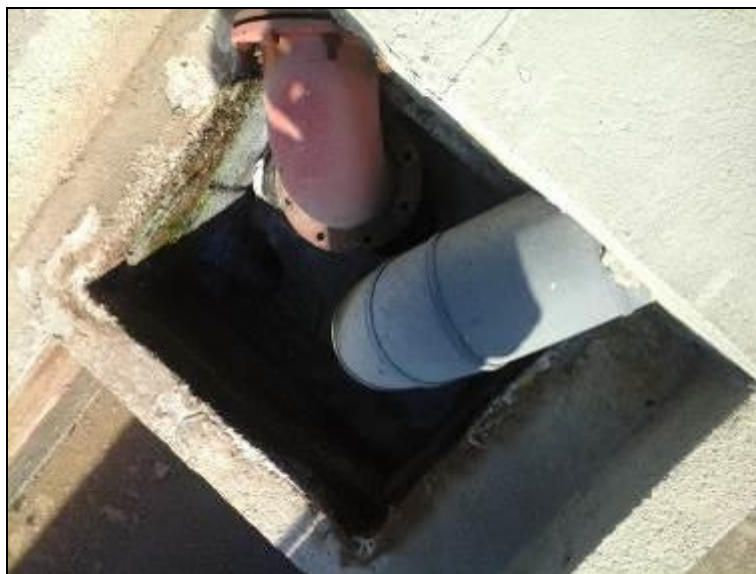
Figura 74: Entrada do efluente bruto não é submersa (Acompanhamento fev2014)
