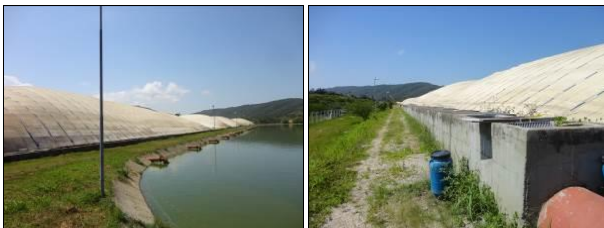
Figura 88: Reatores anaeróbicos operando normalmente (Acompanhamento fev2014)
