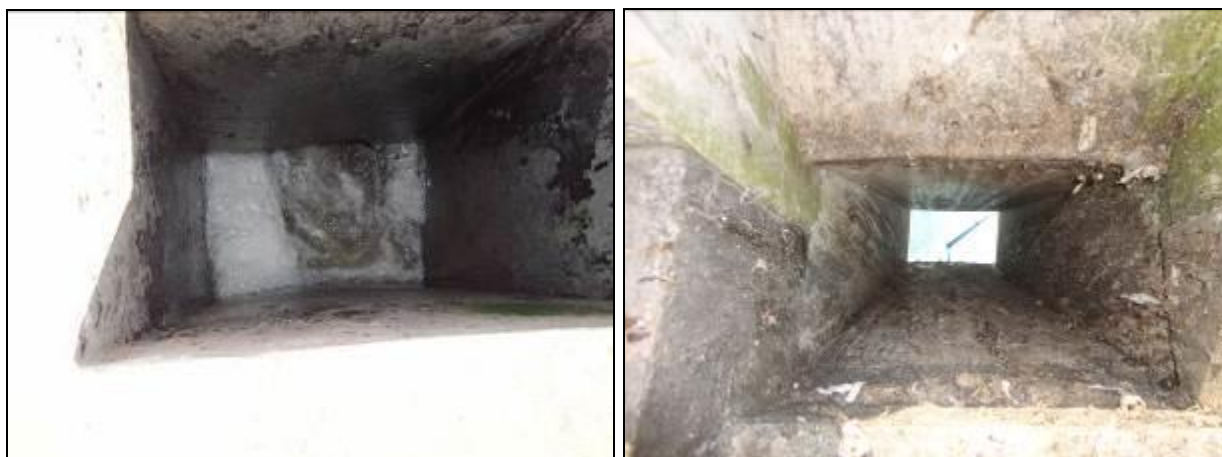
Figura 24: Área de recepção do efluente bruto (Inicial à esquerda e Acompanhamento fev2014 à direita)
