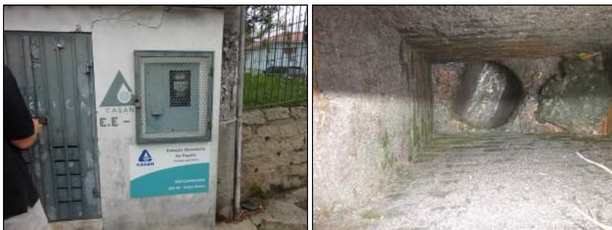
Figura 193: Vista externa da casa de comando (à esquerda) e vazamento na rede pluvial (à direita) (Acompanhamento fev2014)
