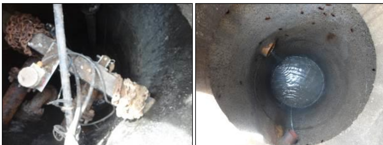
Figura 99: Poço úmido (à esquerda) e chegadas dos efluentes brutos (à direita) (Acompanhamento fev2014)
