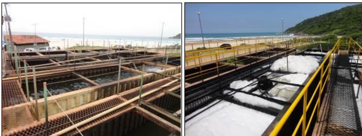
Figura 60: Equipamento de tratamento físico do esgoto (Acompanhamento set2013 à esquerda e fev2014 à direita)
