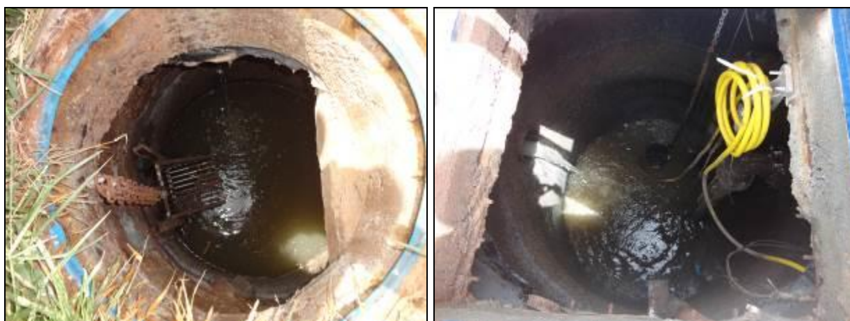
Figura 162: Poço de entrada do efluente bruto com grade (à esquerda) e poço úmido (à direita) (Acompanhamento fev2014)
