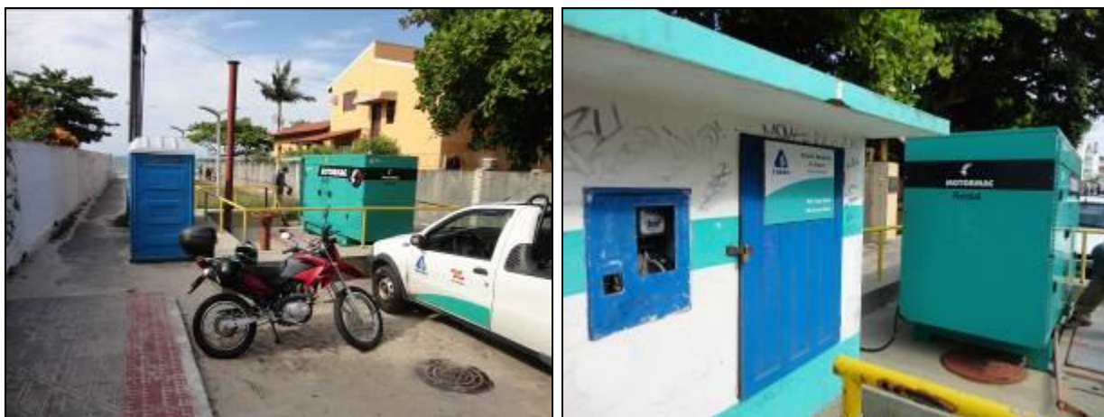
Figura 121: Vista geral da EEE Rua das Flores com a presença de gerador (Acompanhamento fev2014)
