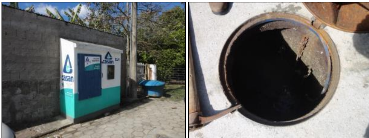
Figura 145: EEE Canto do Lamin 01 (Acompanhamento set2013)
