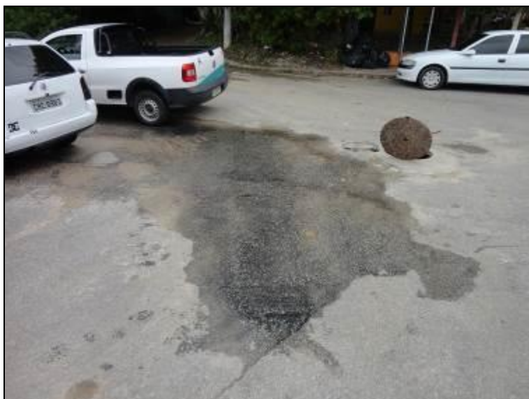
Figura 171: “Brotando” esgoto do asfalto (Acompanhamento fev2014)
