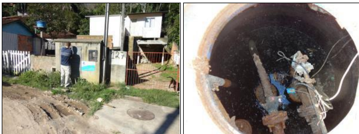
Figura 258: EEE Caieira do Saco dos Limões (Acompanhamento set2013)
