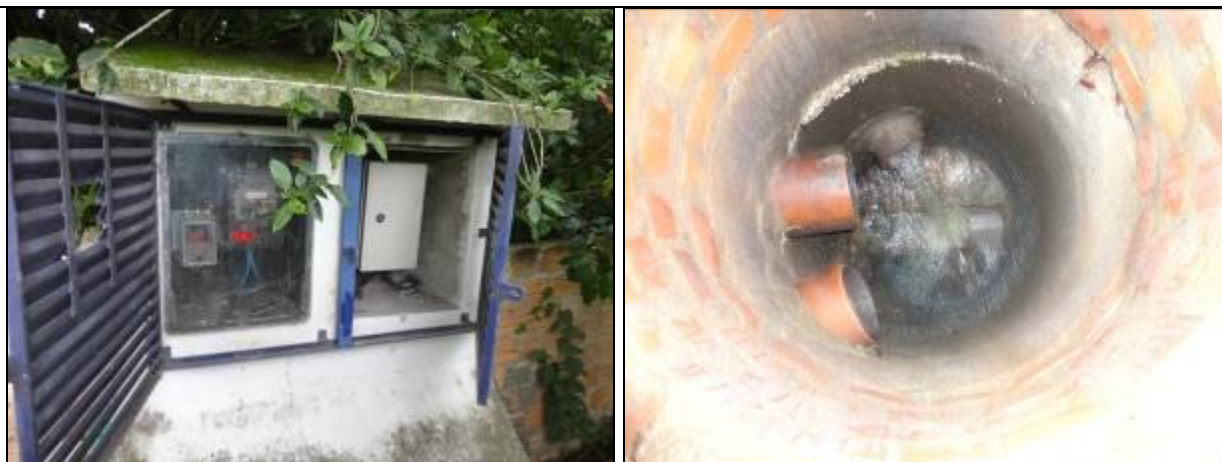
Figura 195: Vista interna da casa de comando (à esquerda) e poço de entrada do efluente bruto (à direita) (Acompanhamento fev2014)
