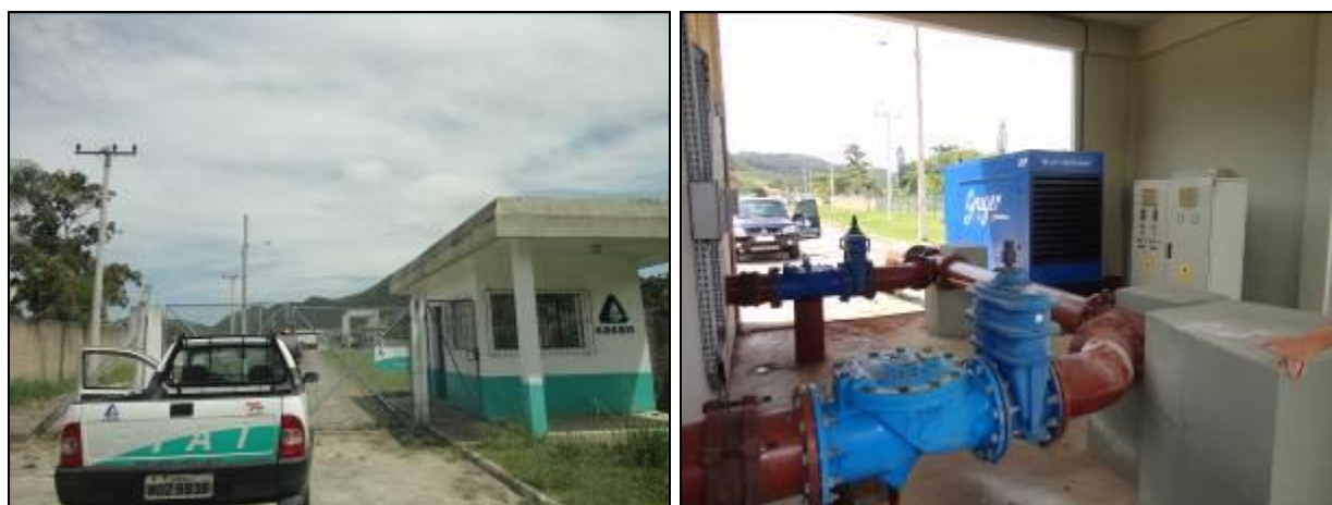
Figura 155: Vista geral da EEE (à esquerda) e casa de comando e gerador expostos (à direita) (Acompanhamento fev2014)
