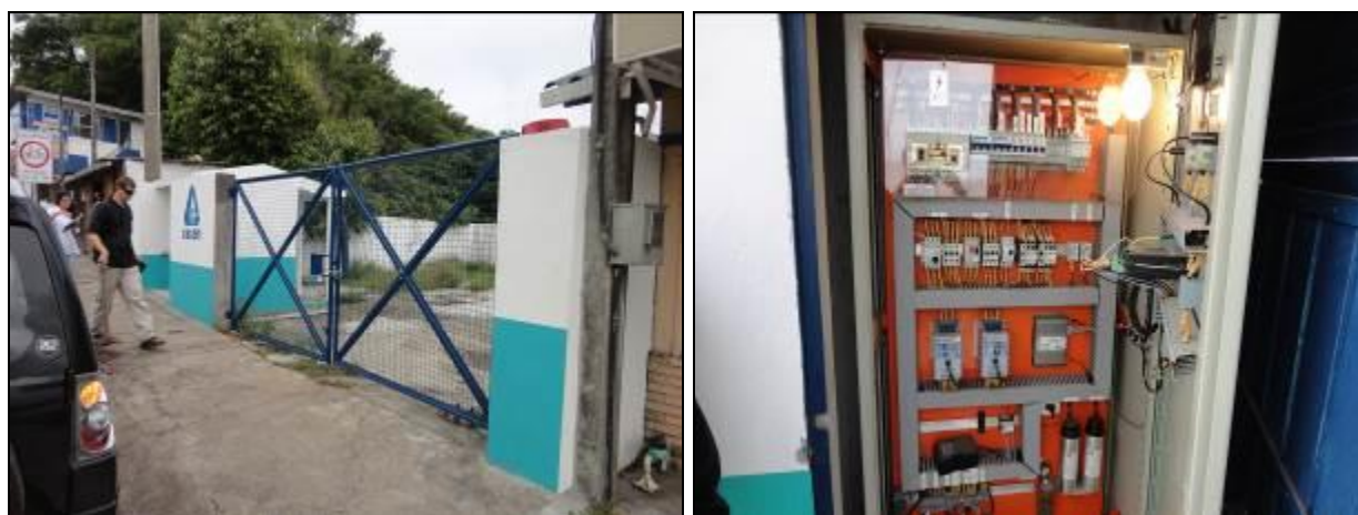
Figura 186: Vista geral da EEE (à esquerda) e casa de comando (à direita) (Acompanhamento fev2014)
