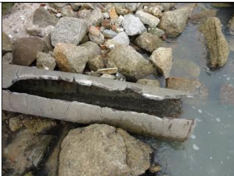
Figura 188: Extravasador (Acompanhamento fev2014)
