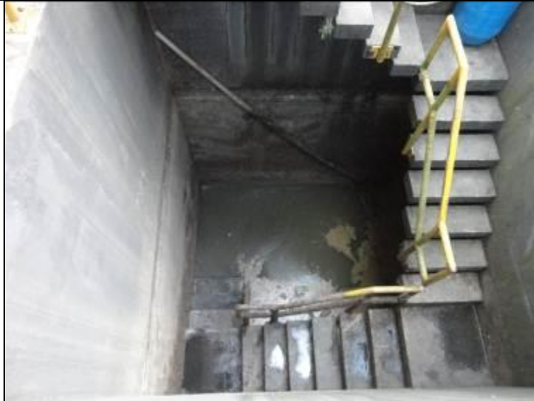
Figura 225: Gradeamento entupido (Acompanhamento fev2014)
