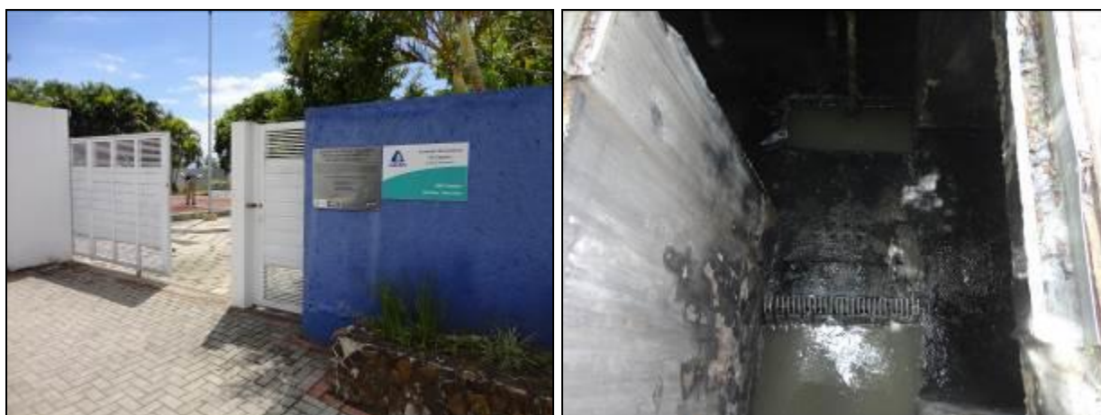
Figura 207: Vista geral da EEE (à esquerda) e gradeamento (à direita) (Acompanhamento fev2014)
