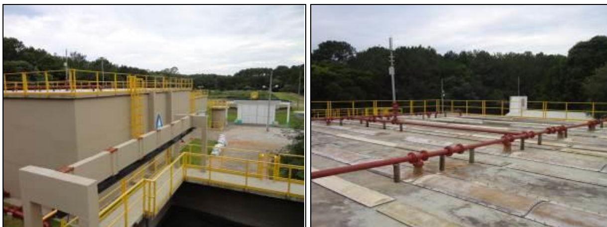
Figura 80: Reatores UASB (Acompanhamento set2013)
