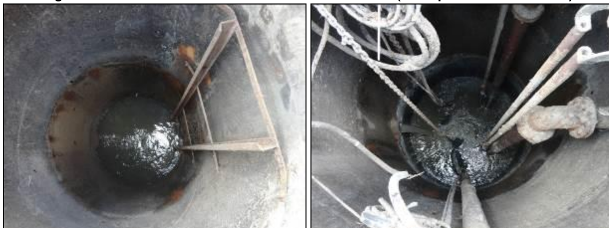
Figura 150: Poço de entrada do efluente bruto (à esquerda) e poço úmido (à direita) (Acompanhamento fev2014)
