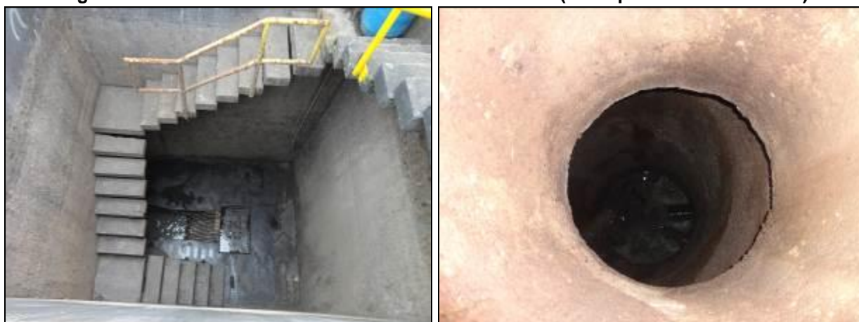
Figura 228: Gradeamento (à esquerda) e poço de entrada de efluente bruto (à direita) (Acompanhamento fev2014)
