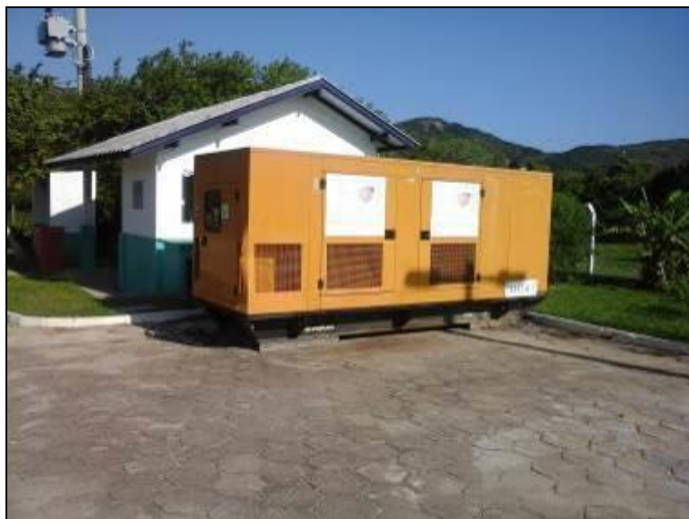
Figura 78: Gerador (Acompanhamento fev2014)
