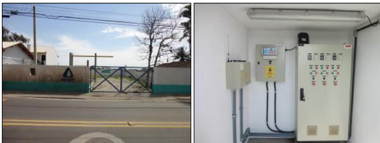
Figura 136: Vista geral da EEE (à direita) e casa de comando (à esquerda) (Acompanhamento fev2014)
