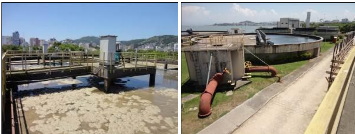
Figura 16: Tanque de aeração (à esquerda) e decantador (à direita) paralisados devido à falta de energia elétrica (Acompanhamento fev2014)
