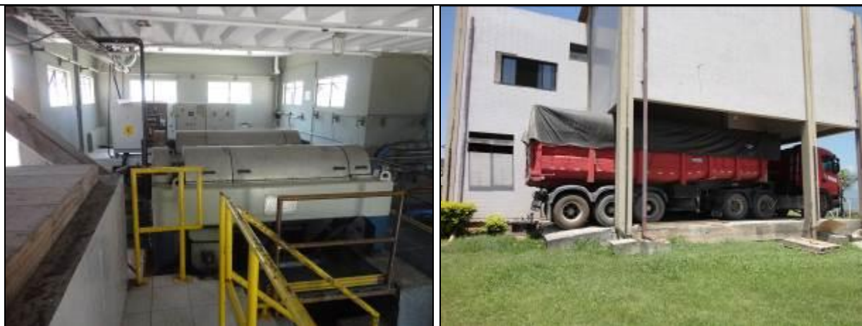
Figura 10: Interior da área de desidratação do lodo (à esquerda) e caminhão sendo carregado com o sólido final (à direita) (Acompanhamento fev2014)
