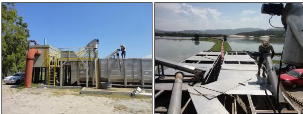
Figura 94: Chegada do esgoto bruto e separação dos sólidos grosseiros (Acompanhamento fev2014)
