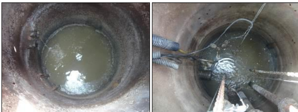
Figura 291: Poço de entrada de efluente bruto (à esquerda) e poço úmido (à direita) (Acompanhamento fev2014)
