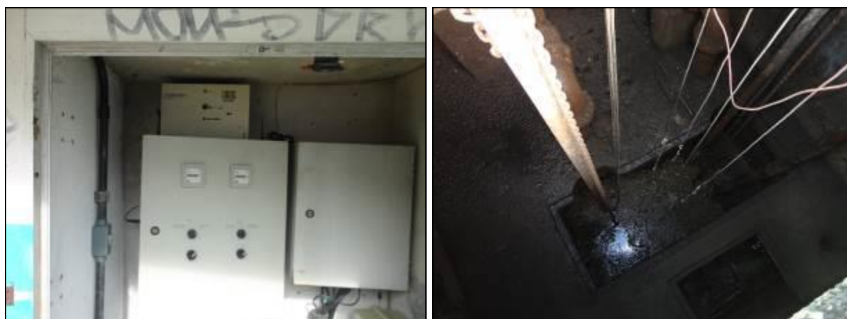
Figura 122: Interior da casa de comando (à esquerda) e interior do poço úmido (à direita) (Acompanhamento fev2014)
