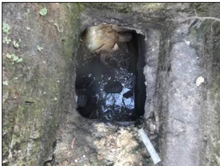
Figura 216: Vazamento para a rede pluvial (Acompanhamento fev2014)
