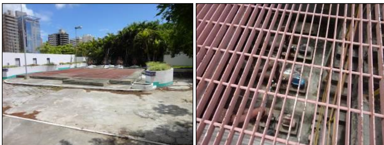
Figura 209: Vista das bombas horizontais de poço seco (Acompanhamento fev2014)
