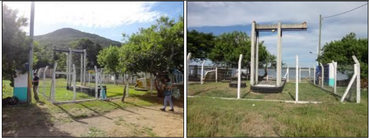
Figura 117: Vista geral da EEE 07 Costa da Lagoa (Acompanhamento fev2014)
