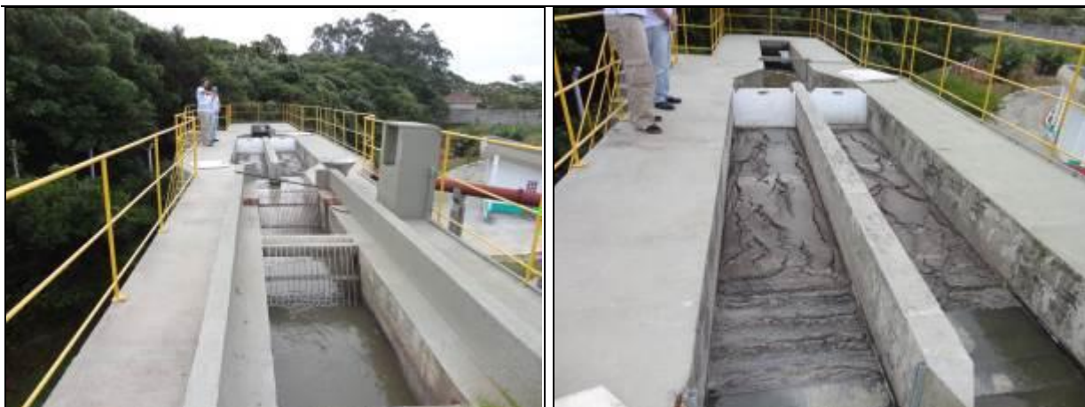
Figura 75: Gradeamento (à esquerda) e caixa de gordura (à direita) (Acompanhamento set2013)
