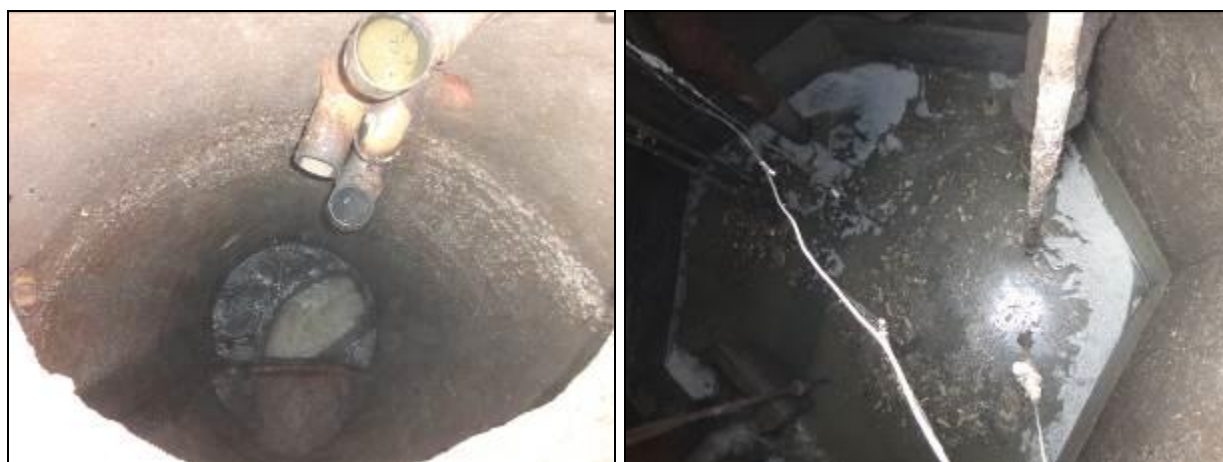
Figura 165: Poço de entrada do efluente bruto (à esquerda) e poço úmido (à direita) (Acompanhamento fev2014)
