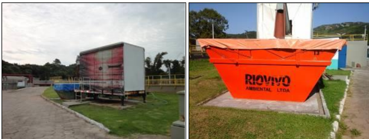
Figura 72: Caixa de recepção do lodo desidratado (Acompanhamento set2013 à esquerda e fev2014 à direita)
