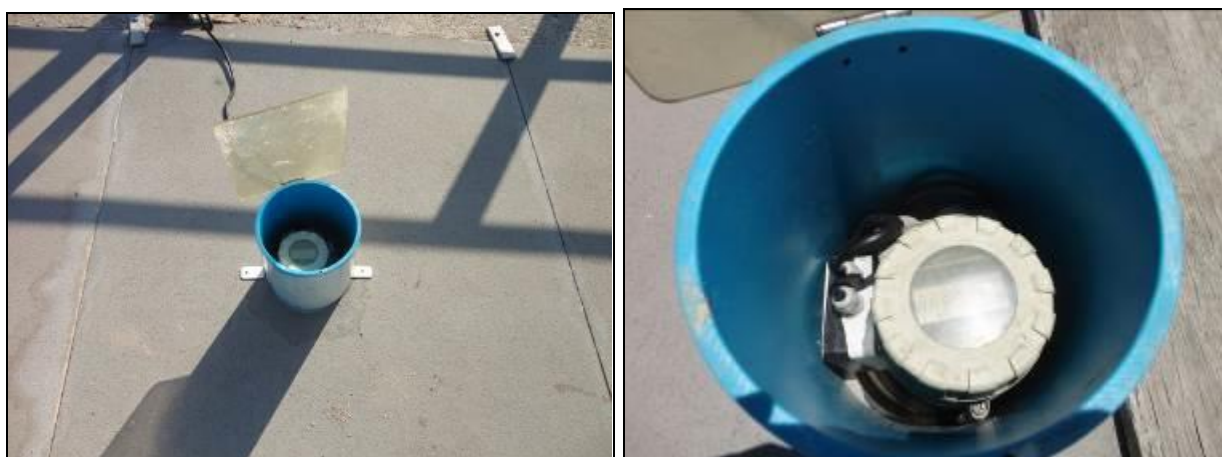
Figura 11: Medidor de vazão (Acompanhamento set2013 à esquerda e fev2014 à direita)
