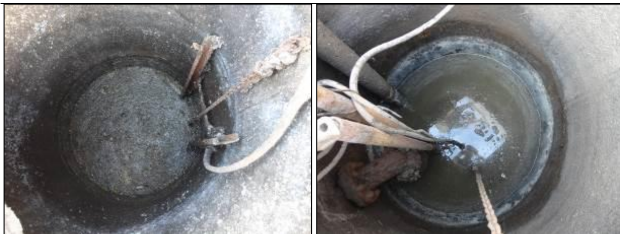
Figura 147: Poço de entrada do efluente bruto com lodo sobrenadante (à esquerda) e poço úmido (à direita) (Acompanhamento fev2014)
