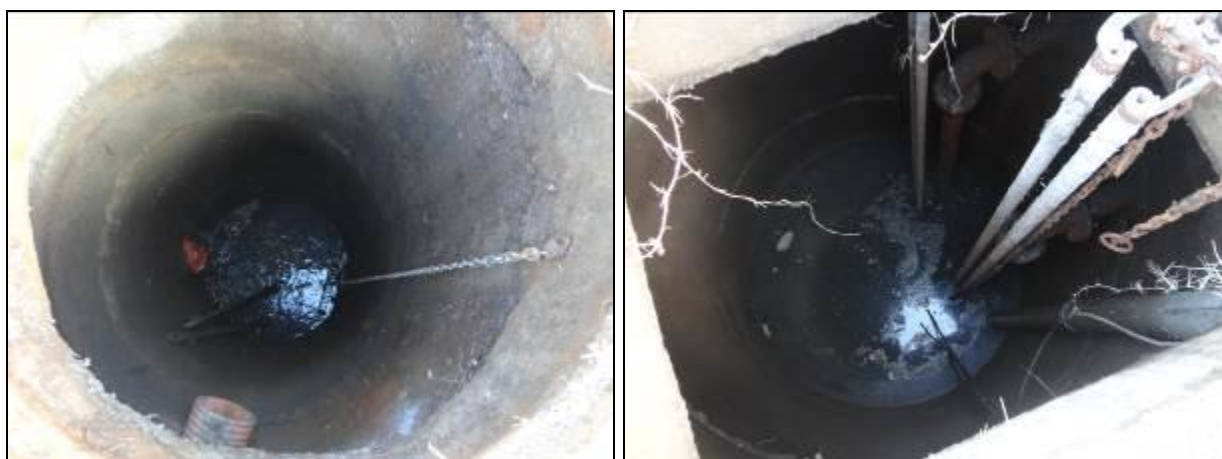
Figura 252: Gradeamento (à esquerda) e poço úmido (à direita) (Acompanhamento fev2014)
