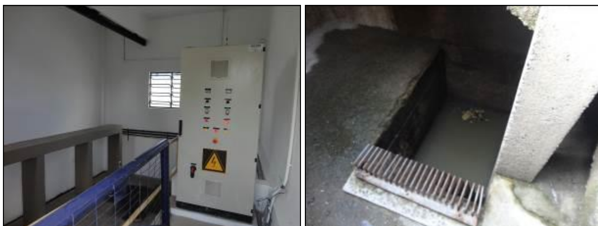
Figura 219: Casa de comando (à esquerda) e gradeamento (à direita) (Acompanhamento fev2014)
