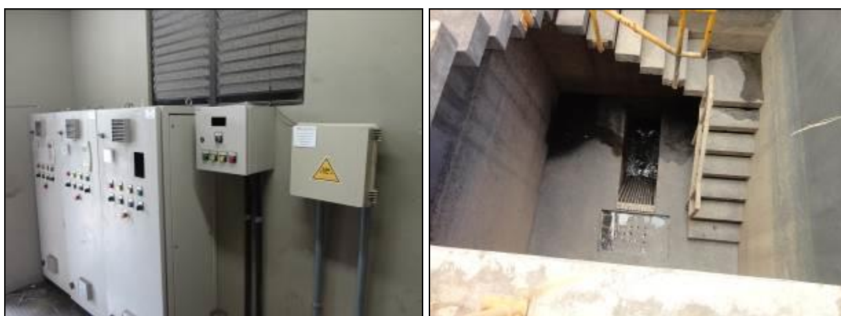
Figura 238: Casa de comando (à esquerda) e gradeamento (à direita) (Acompanhamento fev2014)
