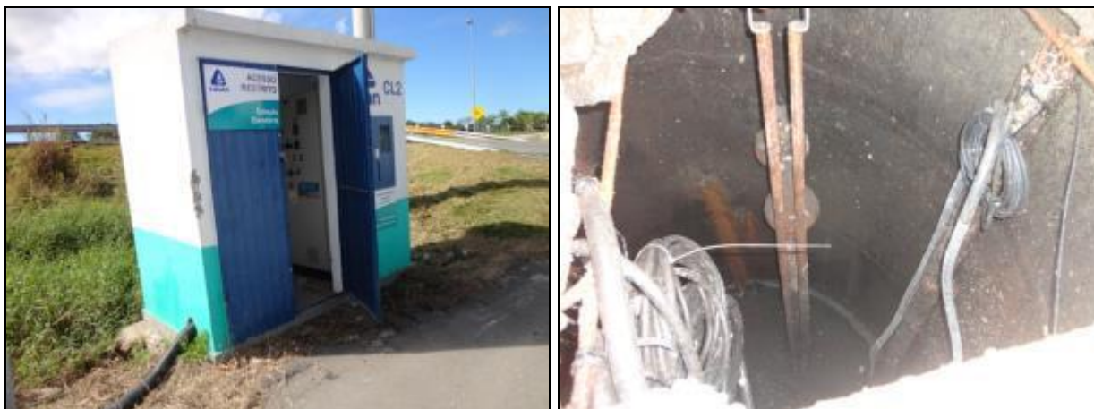
Figura 148: EEE Canto do Lamin 02 (Acompanhamento set2013)
