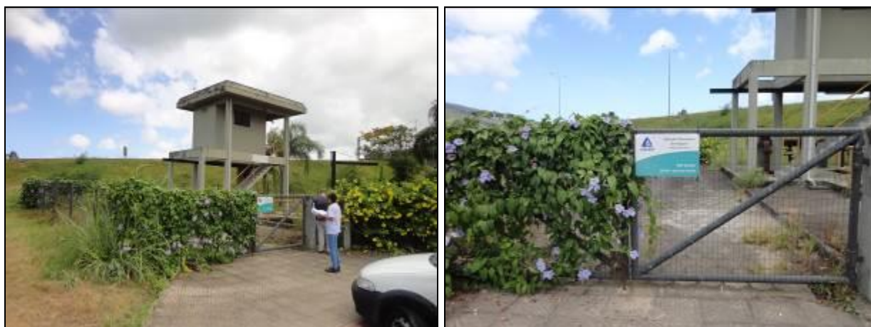
Figura 237: Vista geral da EEE (Acompanhamento fev2014)
