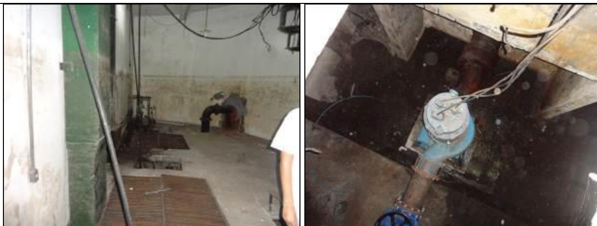
Figura 191: Vista externa do poço úmido (à esquerda) e vista das bombas submersíveis de poço seco (à direita) (Acompanhamento fev2014)
