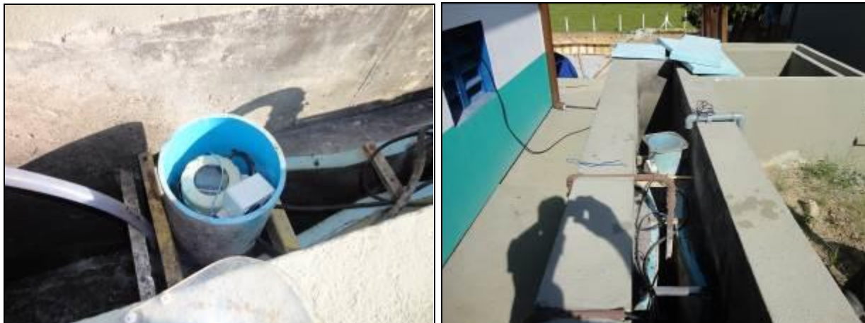
Figura 26: Medidor de vazão (Acompanhamento set2013 à esquerda e fev2014 à direita)
