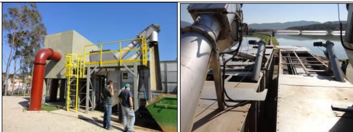
Figura 93: Chegada do esgoto bruto e separação dos sólidos grosseiros (Acompanhamento set2013)
