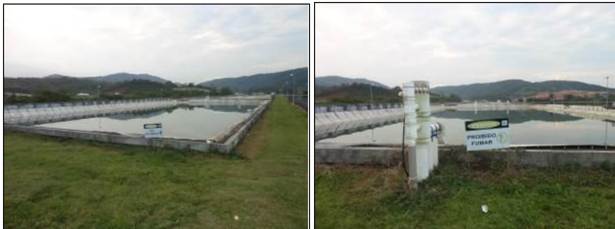
Figura 87: Reatores anaeróbicos danificados e inativos (Acompanhamento set2013)
