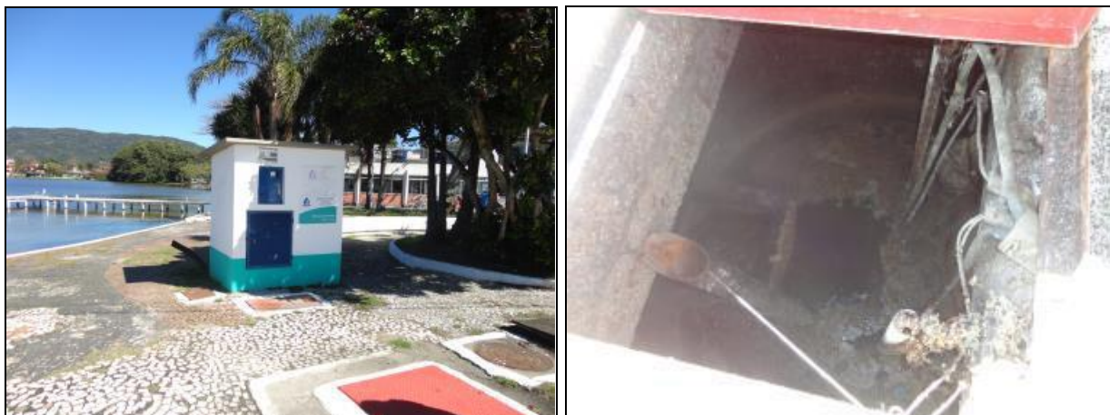
Figura 261: EEE B01 Ponte (Acompanhamento set2013)
