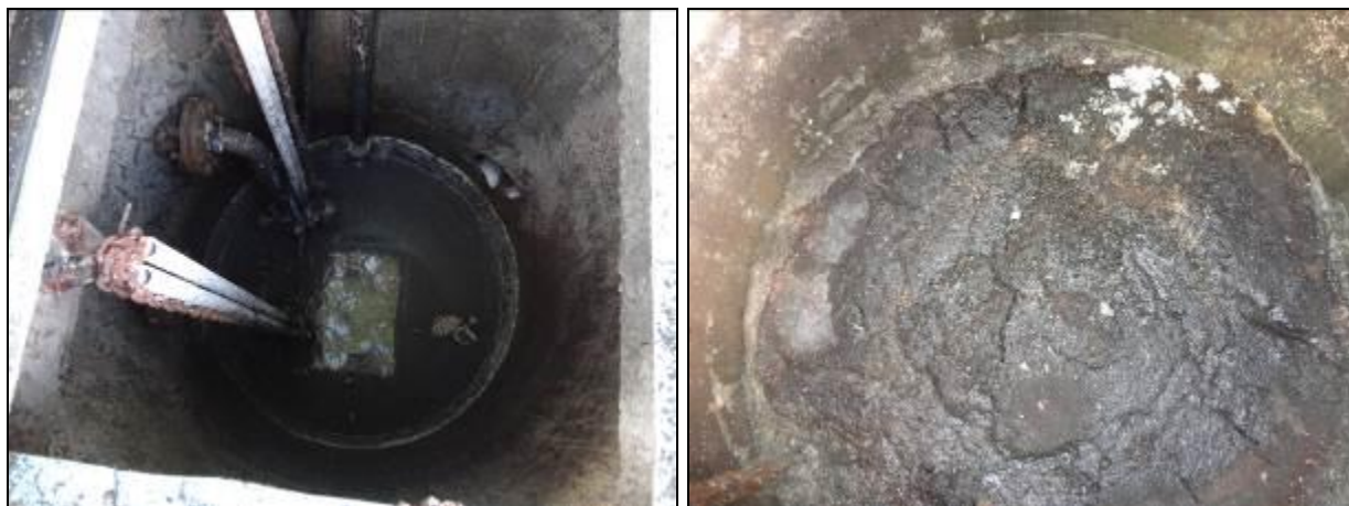
Figura 112: Poço úmido (à esquerda) e poço de entrada do efluente bruto com lodo sobrenadante (à direita) (Acompanhamento fev2014)
