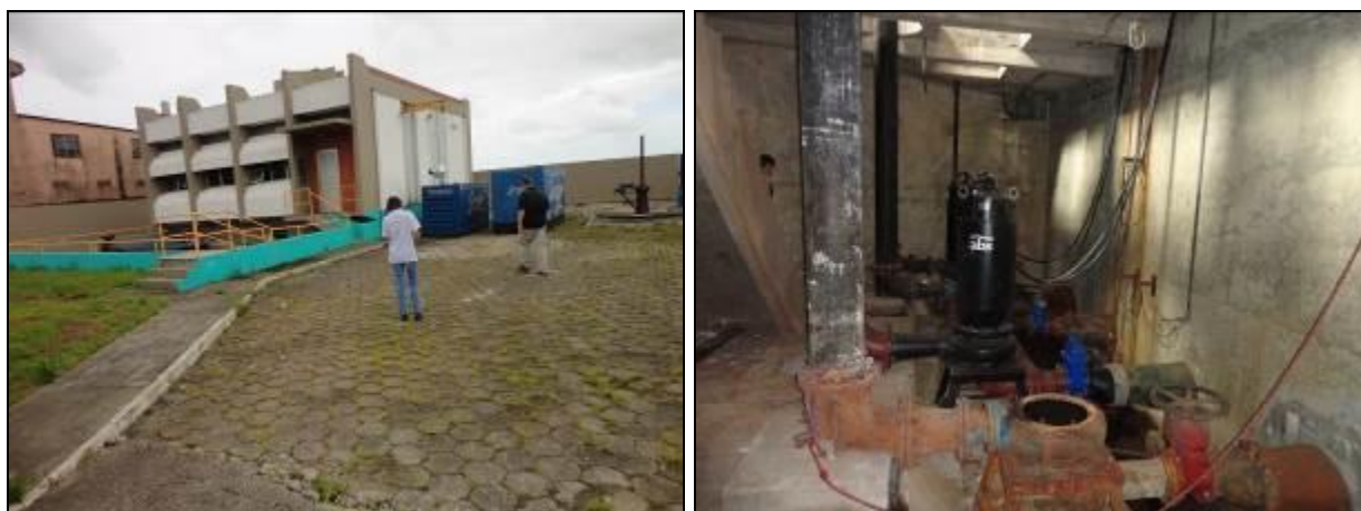
Figura 180: Vista geral da EEE (à esquerda) e bombas submersíveis de poço seco (à direita) (Acompanhamento fev2014)
