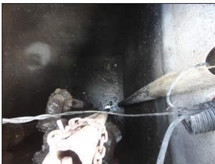
Figura 241: Interior do poço úmido (Acompanhamento fev2014)
