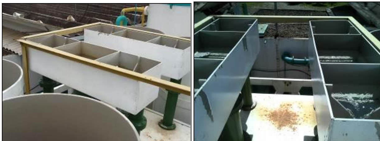
Figura 15: Filtros da ETA (inicial e Acompanhamento)
