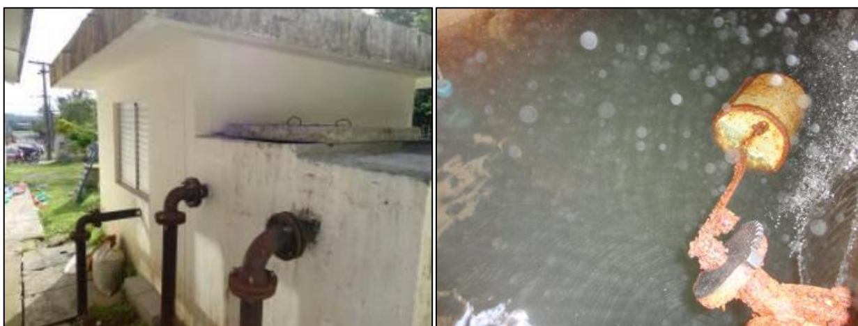
Figura 2: Vista da cisterna acoplada à ERAT (à esquerda) e nível de água na mesma (à direita) (29/01/2014)
