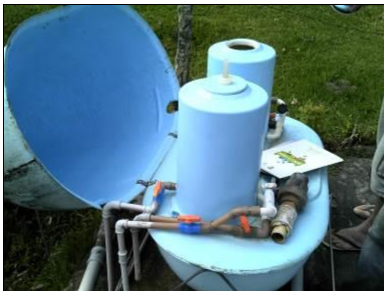
Figura 6: Dosador de Produtos Químicos - Sede
