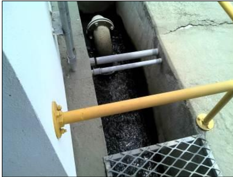
Figura 28: Chegada do Esgoto
