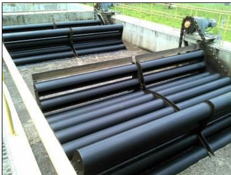
Figura 27: Equipamentos de Operação da ETE
