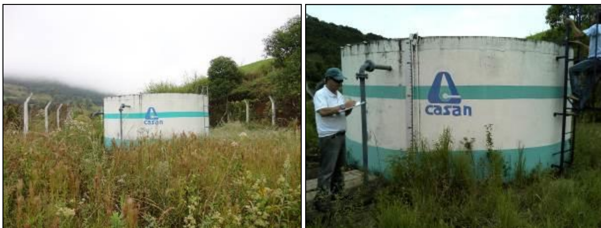
Figura 8: Reservatório R 1 (inicial e acompanhamento)
